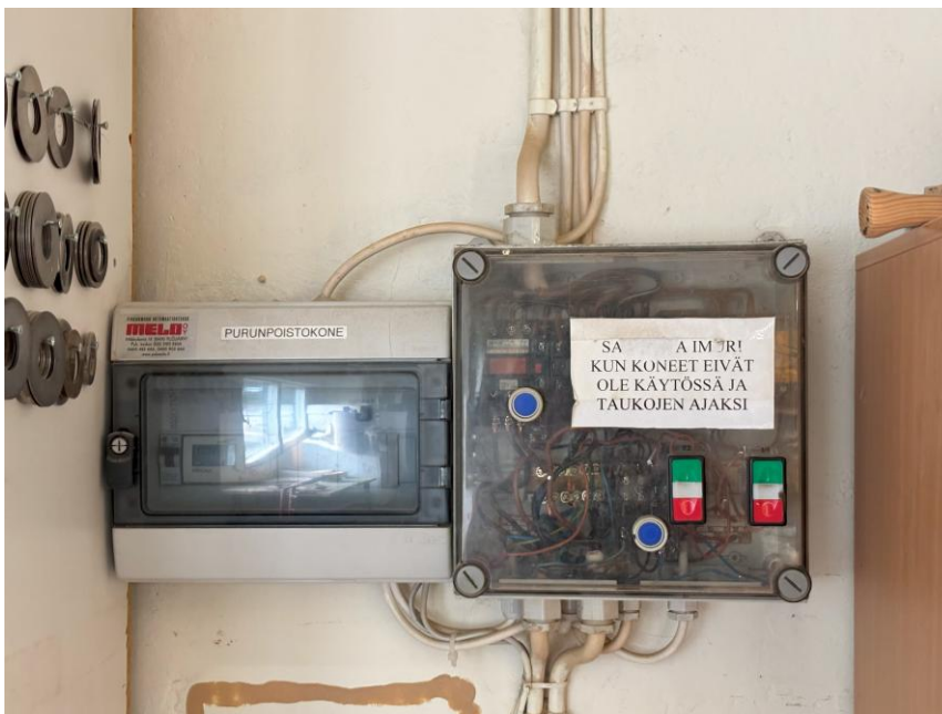
Kuva 4: Purunpoistokoneen ohjauspaneeli puuverstaan seinällä. Imurin kytkentäkotelon kanteen kiinnitetty ohje on osin kulunut, eikä kaikille painikkeille ole merkitty selitettä.
