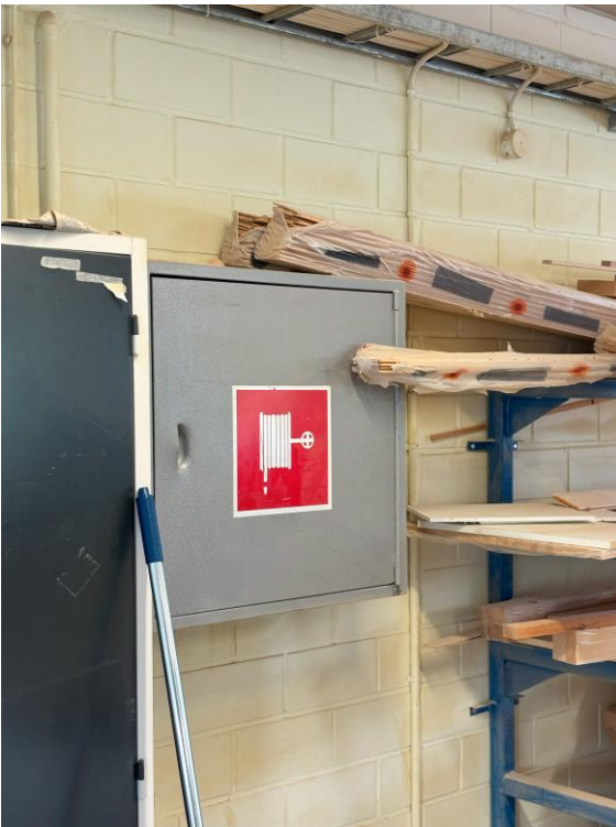
Kuva 2: Kohdekatselmoinnissa pikapalopostin oven todettiin jumiutuneen kiinni ja hyllyltä oven eteen ylettyvä puumateriaali vaikeutti sen avaamista. Alkusammutusvälineistön saavutettavuuteen tulee kiinnittää huomiota. Sammutusvälineiden edustalla ei saa säilyttää tavaraa.
