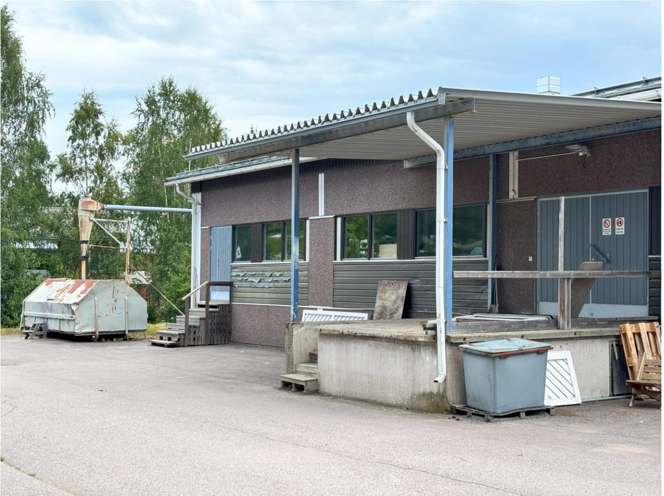
Kuva 11: Varapoistumistieovet rakennuksen länsipuolelta kuvattuna, maalaamoon johtava ovi kuvassa oikealla. Maalaamon lastauslaiturilla ja rakennuksen seinustoilla todettiin säilytettävän puumateriaalia, mikä lisää tuhopolttoriskiä. Puuverstastilasta ulos johtava ovi (rakennuksen nurkassa) on noin 3 metrin päässä purunpoistojärjestelmään kuuluvasta keräyssäiliöstä.
