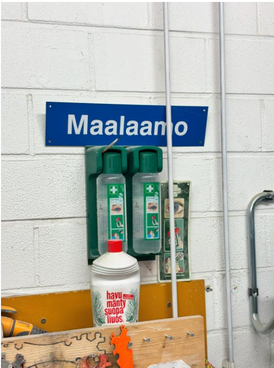
Kuva 9: Maalaamohuoneessa on silmähuuhdeteline, jossa on kaksi pulloa roiskeiden ja roskien puhdistamiseen soveltuvaa silmähuuhdetta. Ensiapupisteen sijaintia ei ole merkitty kylteillä eikä opasteilla.
