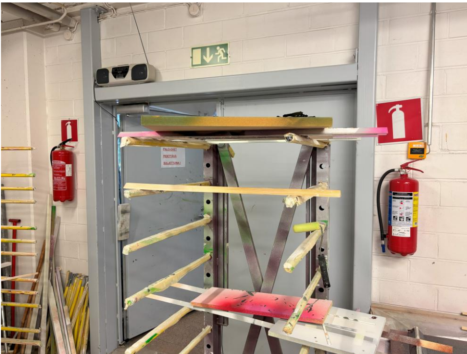
Kuva 10: Maalaamossa olevat käsisammuttimet oli merkitty yksipuolisilla opastekylteillä. Sammuttimien sijaintia ei ole opastettu puuverstastilan puolelta. Oven oikealla puolella olevan käsisammuttimen yläpuolella on keltainen ilmastoinnin hätä seis -rikolasipainike, joka on merkitty tarratulostimella "IV-HS". Painikkeen tarkoitus tulisi osoittaa helpommin ymmärrettävällä merkinnällä. Maalaamossa olevia kuivatustelineitä säilytettiin varapoistumisreiteillä ja varapoistumisovien edessä. Palo-oven yläpuolella on nähtävissä varapoistumistien opastekyltti.
