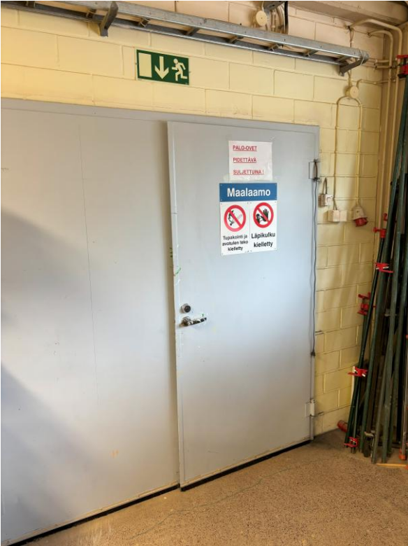
Kuva 7: Maalaamoon johtavan palo-oven lukkopesän kiinnitys todettiin puutteelliseksi. Osin upotteestaan irronnut lukkopesä esti oven sulkemisen. Avoin palo-ovi lisää tulipalon ja savukaasujen leviämisen riskiä. Oven yläpuolella on varapoistumisreittiä osoittava opastekyltti.
