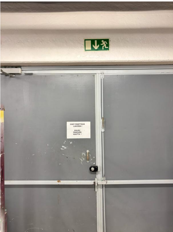
Kuva 8: Sekä maalaamosta että verstastilasta ulos johtavat varapoistumisovet oli teljety sisäpuolelta metallitangolla. Tanko muodostaa hätäpoistumista vaarantavan esteen, joten se tulee poistaa aina, kun tiloissa on ihmisiä.
