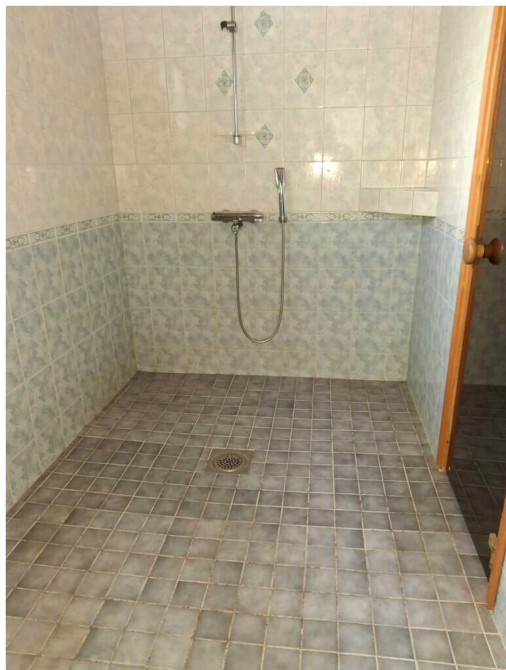
Kuva 20 Pesuhuoneen lattialaatoitus osittain kopona. Suihkuvesialueella lattiassa pintakosteutta.
