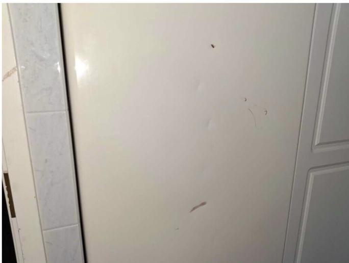
Kuva 15 Lvv:n peitelevyssä vaurioita.
