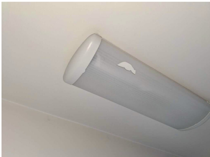
Kuva 14 Kodinhoitohuoneen kattolampun kuvussa reikä.
