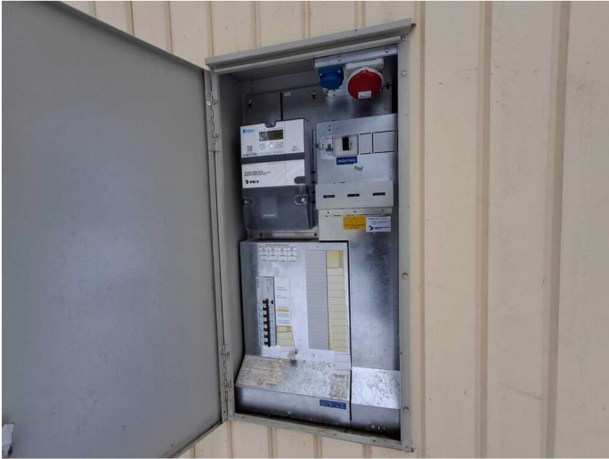
Kuva 6 Sähköpääkeskus on autotallin päätyseinällä.
