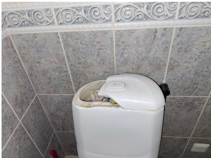
Kuva 18 Wc-istuimen säiliön yläosa rikki.
