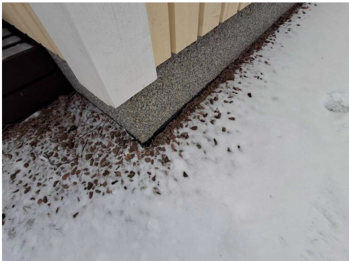
Kuva 2 Rakennuksen perustuksena on betonianturoiden päälle Leca-harkoista muuratut perusmuurit. Näkyvällä perusmuuriosalla ei havaittu vaurioita. Perusmuuria vasten on asennettu patolevytyt.
