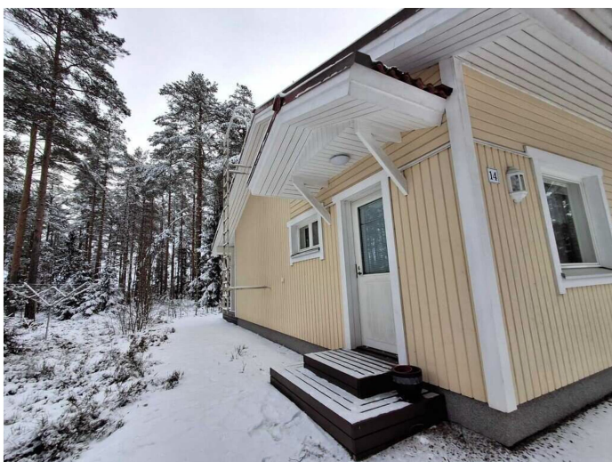
Kuva 4 Lattiapinta sekä ulkoseinien alajuoksujen alapinta on ulkopuolen maanpintaa ylempänä noin 250-300 mm.
