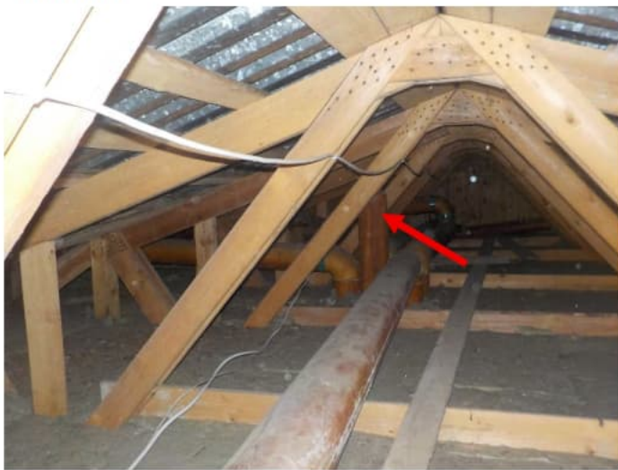
Yläpohjaan päättyvä ilmanvaihtokanava.
