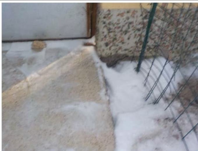
Sokkelin alaosan lohkeamaa/halkeamaa.
