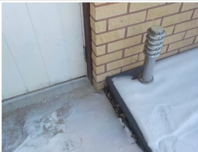
Ulko-oven viereltä kiinnityksestään irronnut tiili.
