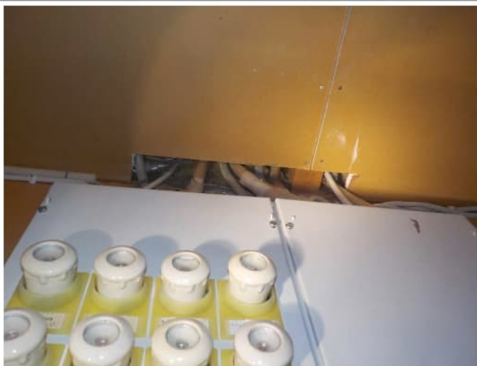
Kaapeleiden sisäkaton läpivientejä.
