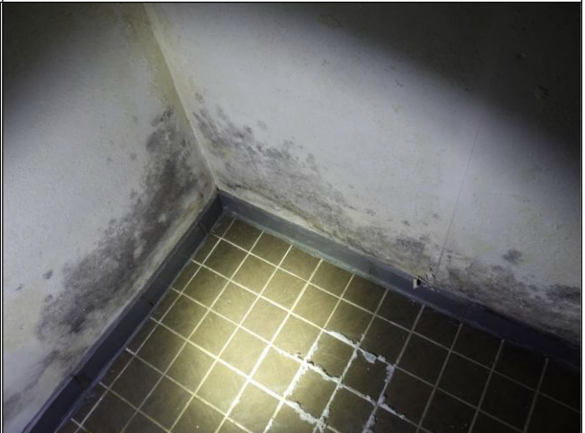
Kuva 4. Levitetyn seinän pinnalla mikrobikasvustoa.
