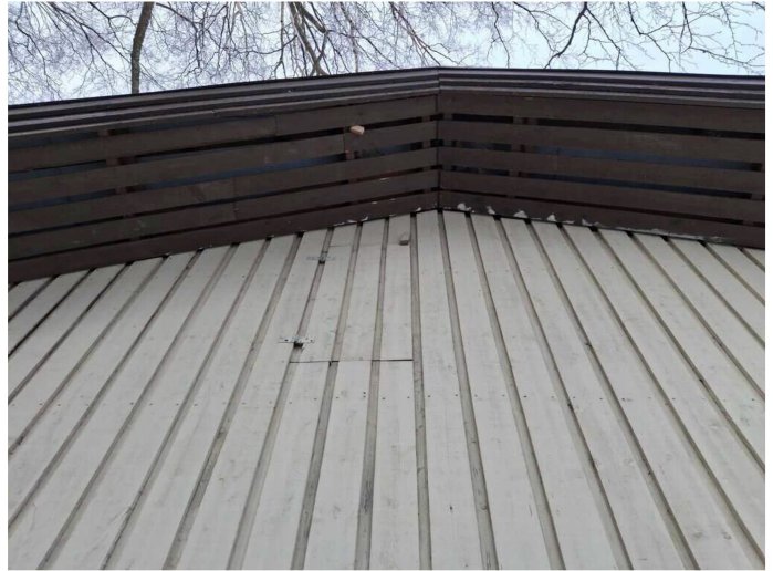
Kuva 7 Ulkoverhouksen maalipinnan huoltomaalaus on ajankohtainen.
