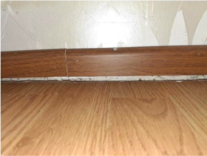
Kuva 18 Painumarakoa. Maanvaraisen betonilaatan painuma / epätasaisuus on havaittavissa huonetiloissa kävellessä.
