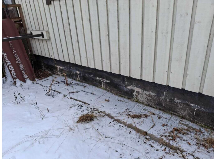
Kuva 3 Näkyvällä perusmuuriosalla oli havaittavissa maali ja tasoitepinna vaurioita.
