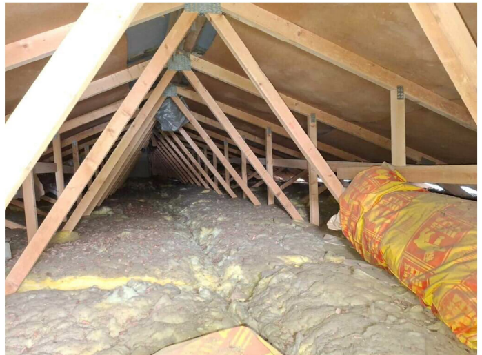
Kuva 9 Kattotuolit ovat tehdastekoiset ja reunoiltaan itsekantavat. Vesikatteen uusimisen yhteydessä alkuperäinen pahvipohjainen "panssari" aluskate on jätetty paikoilleen. Vanhaa aluskatetta on osittain avattu, ohjeistuksena kattosaneerauksissa on vanhan aluskatteen poisto kokonaisuudessaan.
