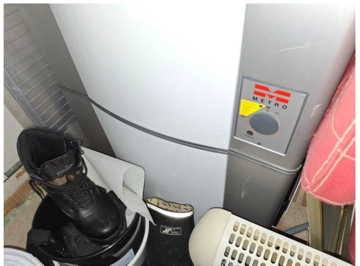
Kuva 21 Lvv-tilaan varastoitu tavara esti varaajan tarkastusta..
