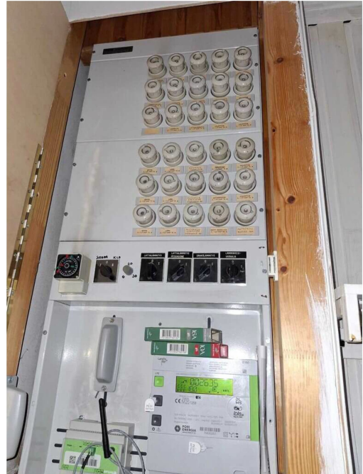
Kuva 35 Pääsulaketaulu / sähköjärjestelmä on alkuperäinen
