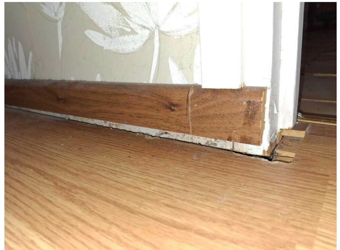
Kuva 17 Listojen alla oli havaittavissa maanvaraisen betonilaatan painumaa.
