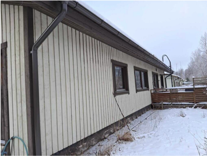
Kuva 6 Maanpinta on noin 20-40 cm alempana ulkoseinien elementtien alaohjauspuiden alareunaa.
