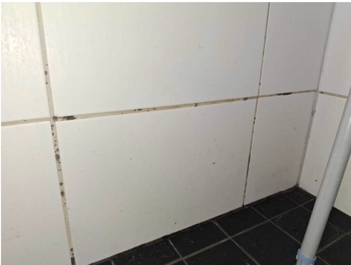
Kuva 32 Pesuhuoneen seinälaattojen saumat tummuneet.
