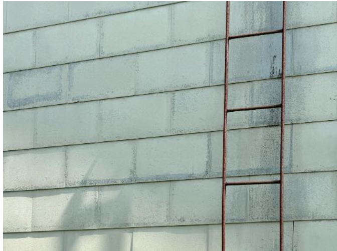
Julkisivun maalipinta hilseilee. Suositellaan huoltomaalausta.
