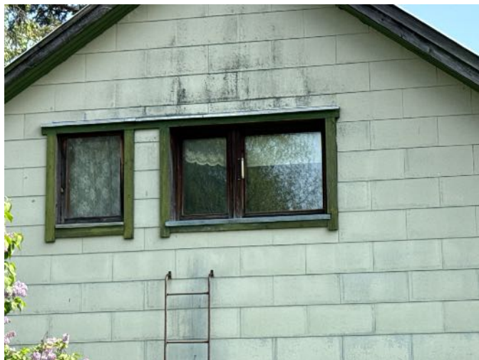
Julkisivuverhous on teknisen käyttöikänsä päässä. Suositellaan varautumaan verhouksen uusimiseen.
