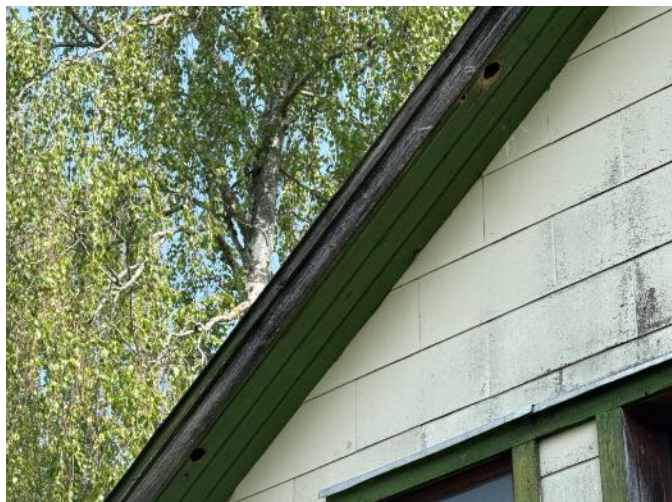
Räystäslautojen kunto on paikoin huono. Laudoissa on eläimen tekemiä reikiä. Suositellaan niiden uusimista.
