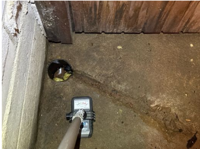
Kellarin lattiassa ja seinissä havaittiin kosteutta.
