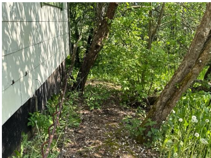
Rakennuksen perustuksia vasten on puita ja kasvillisuutta. Suositellaan puiden ja kasvillisuuden poistamista. Puiden ja kasvien juuret voivat vaurioittaa salaoja- ja viemäriputkia.
