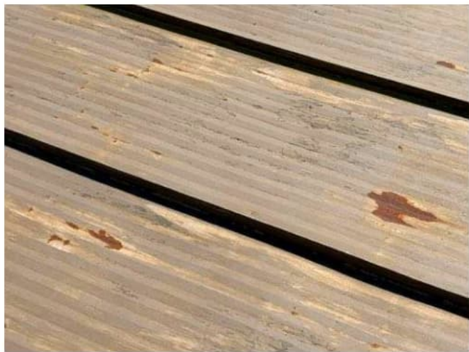
Vesikate on monin paikoin ruosteessa ja teknisen käyttöikänsä päässä. Suositellaan katteen uusimista.
