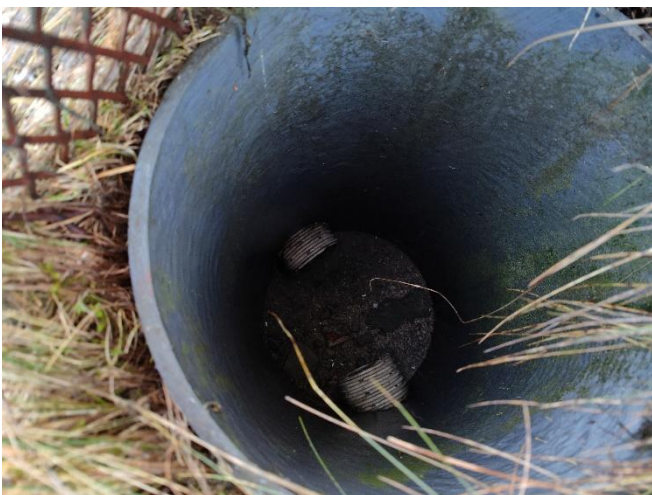
Kuva 7. Yhdistetty rännikaivo ja salaojan tarkastuskaivo.
