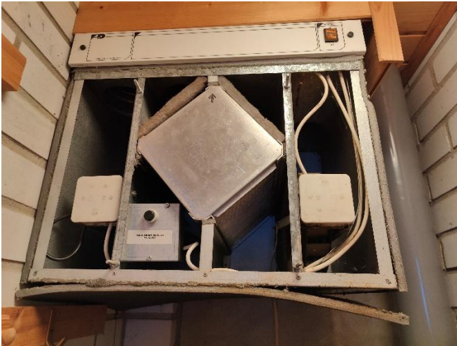
Kuva 65. Yleiskuva IV-koneen sisältä.
