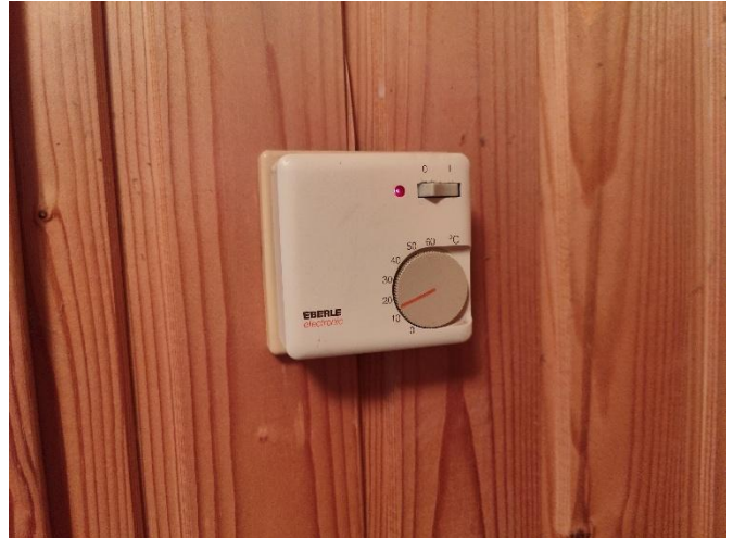
Kuva 56. Yleiskuva lattialämmityksen termostaatista.
