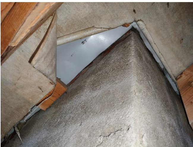
Kuva 35. Savuhormin läpivienti, aluskate puutteellinen.
