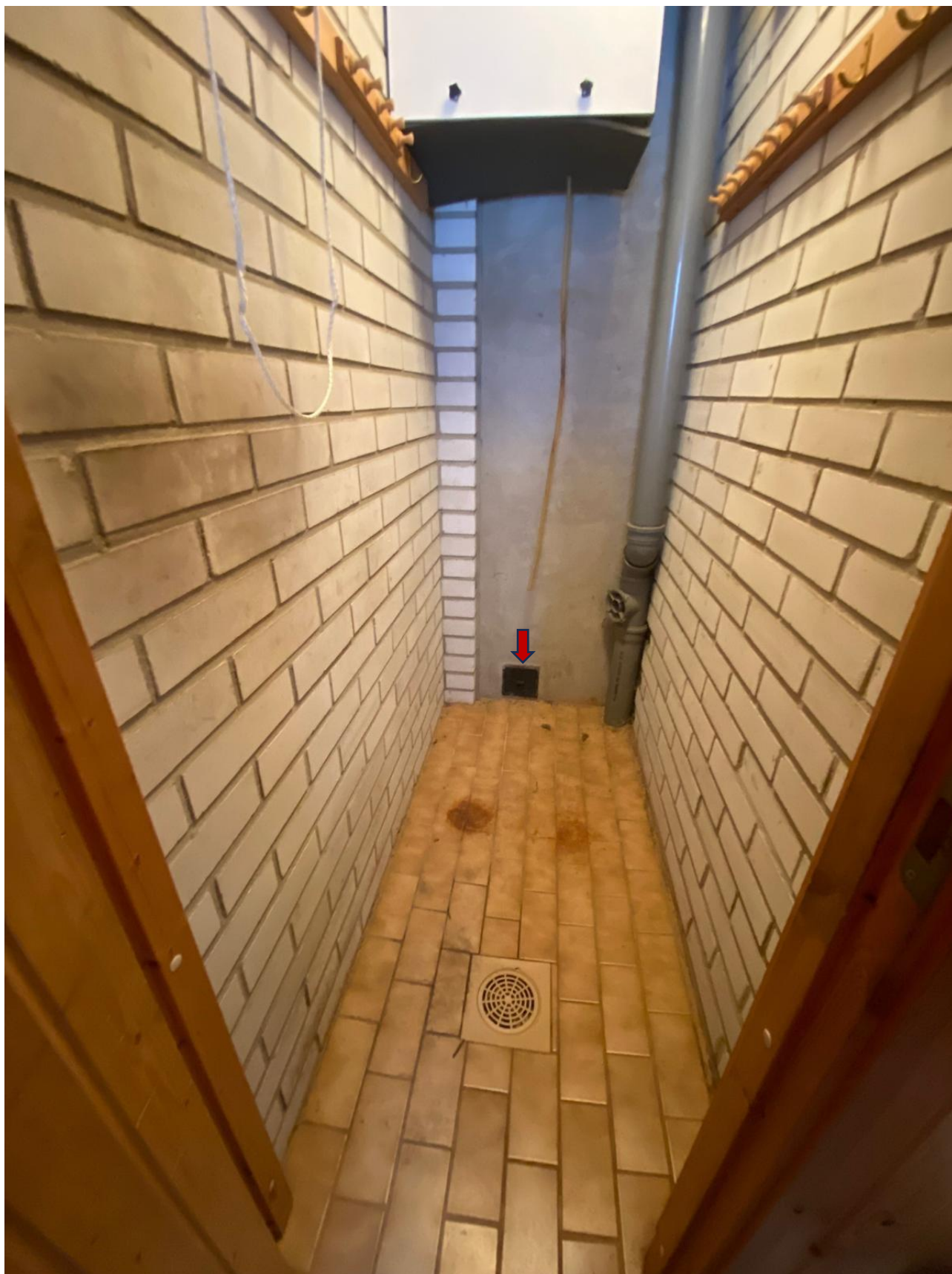
IV-koneen laitetila ilmaisu 17
