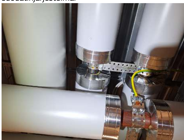
88. Lämpöjohdot ovat yleisesti terästä.
