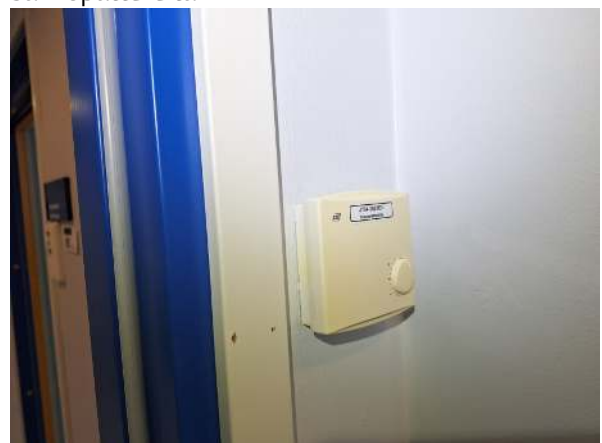
99. Laajennusosalla on huonelämpösäätimet.
