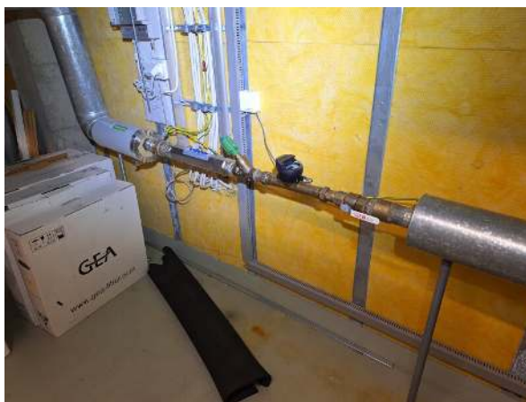
104. Yleiskuva alkuperäisen rakennusosan päävesimittarista.
