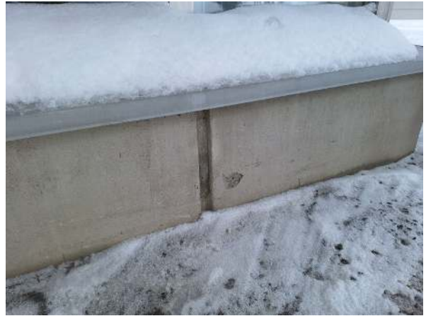
19. Betonirakenteisessa sokkelissa yksittäinen pinnoitevaurio
