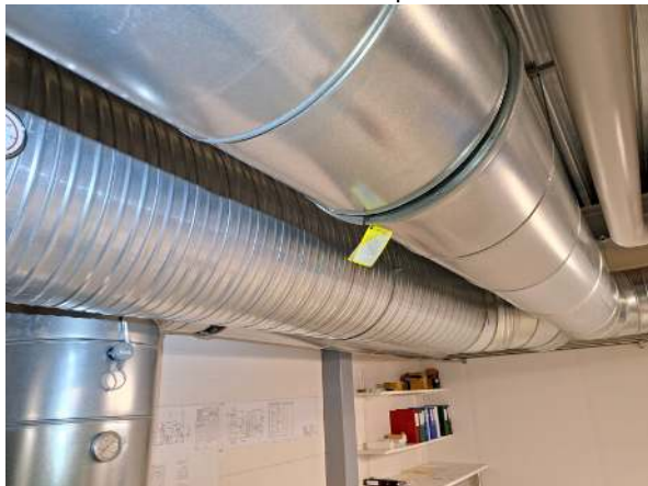
140. Ilmanvaihtokanavat ovat peltiä.
