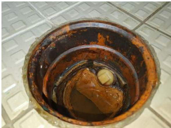
120. Alkuperäisen osan lattiakaivot ovat valurautaa.
