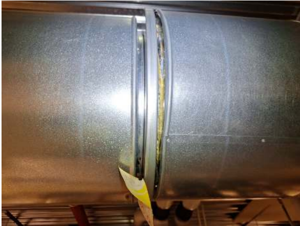
148. Tuloilmakanavat on eristetty, koska tuloilmaa jäähdytetään.
