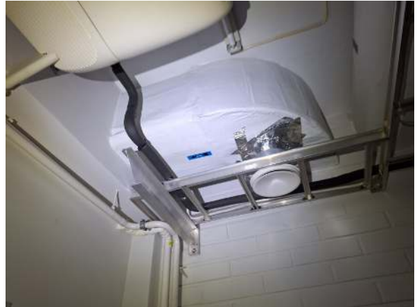
149. Tuloilmakanavat on eristetty, koska tuloilmaa jäähdytetään.
