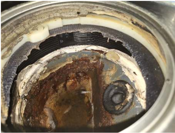
72. Kaivon korokerenkaan liittymäkohtaa on tiivistetty liimatiivistemassalla, massauksessa havaittiin epätiiveyttä.
