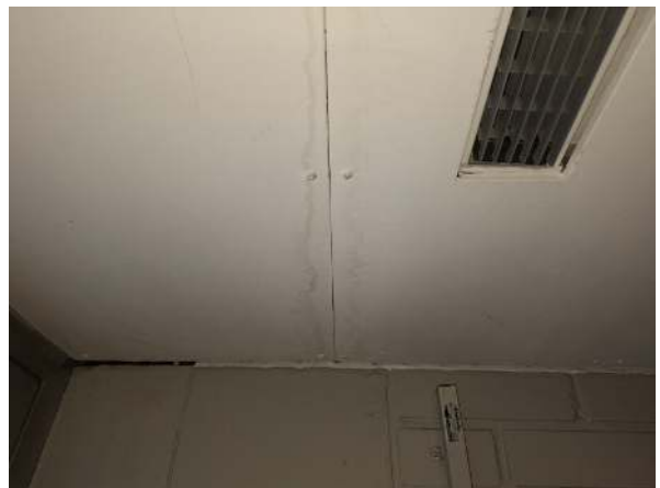
3. Kosteuden aiheuttamia jälkiä tuulikaapissa
