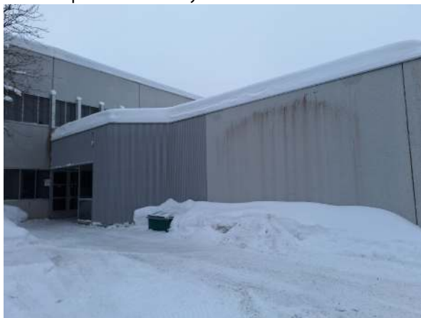
29. Julkisivun betoniosissa paikoin värjäytymää.
