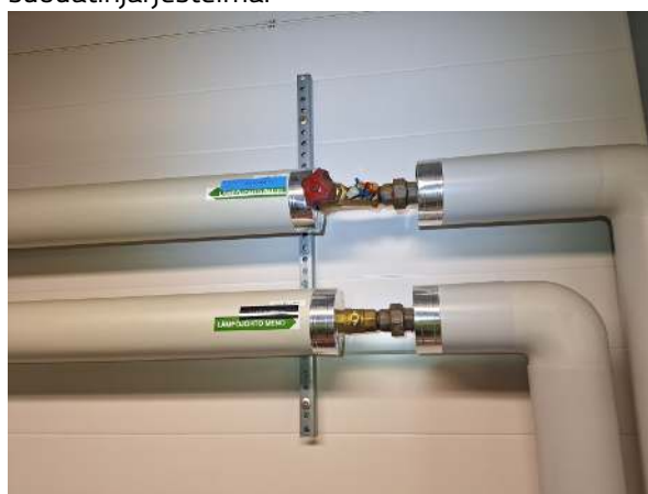
89. Laajennusosan sulku- ja linjasäätöventtiilit ovat rakennusvuodelta.
