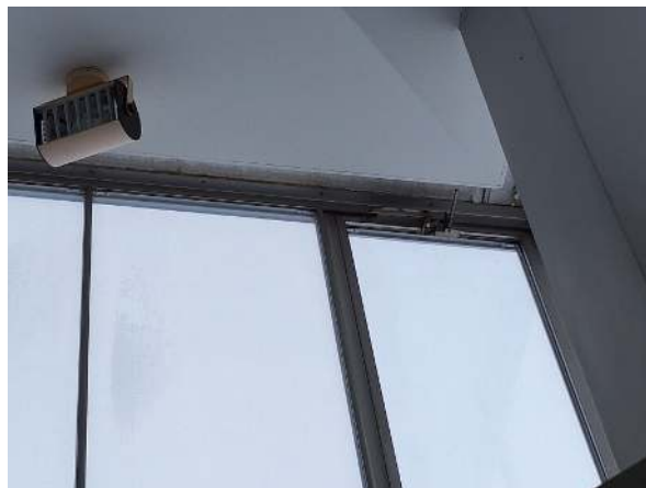
40. Valo-aukon ikkunaliittymässä levyrakenteissa kosteusjälkeä.
