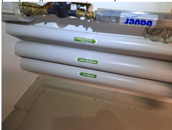
124. Vesijohtojen putkieristykset ovat päällystettyjä mineraalivillakouruja.
