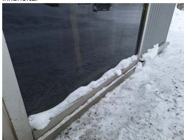
38. Kiinteässä ikkunassa halkeama lasissa.
