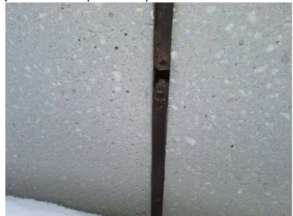
15. Alkuperäisellä osalla elastisissa saumoissa epätiiveyttä (halkeilua sekä reikä)
