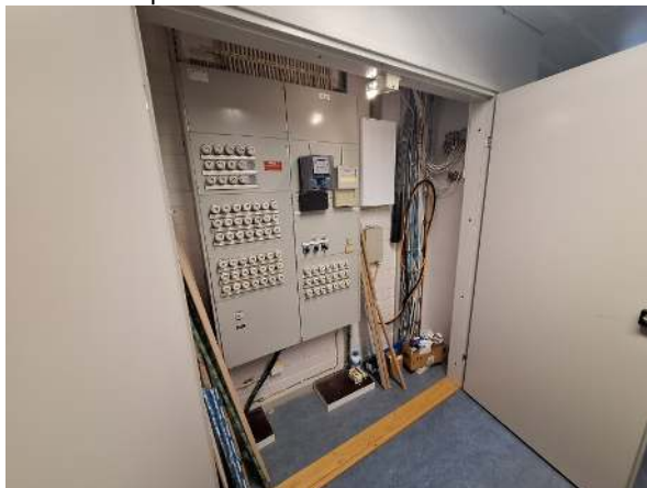
171. Alkuperäisen osan sähkökeskus.
