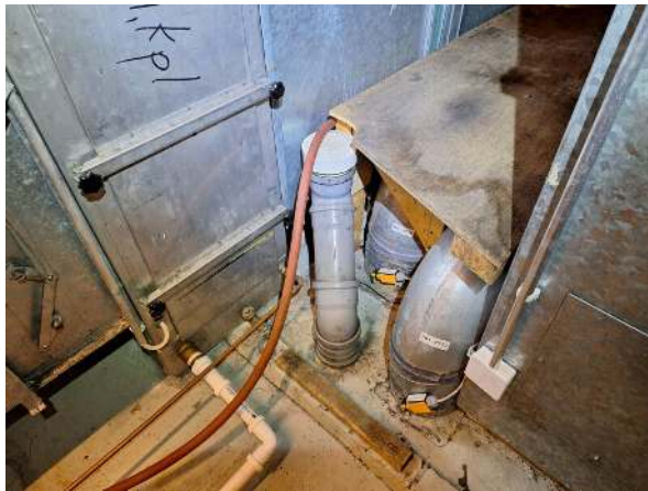
112. Alkuperäisen osan tuuletusviemäriin on asennettu alipaineventtiili.
