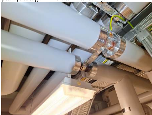
102. Lämpöjohtojen putkieristykset ovat päällystettyjä mineraalivillakouruja.
