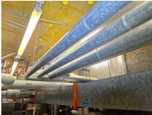
122. Vesijohtojen putkieristykset ovat päällystettyjä mineraalivillakouruja.
