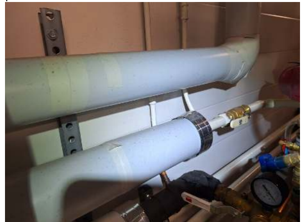
111. Laajennusosan vesijohdot ovat kuparia.
