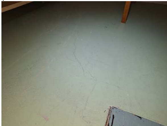
22. Alapohjarakenteessa pienimuotoinen halkeama
