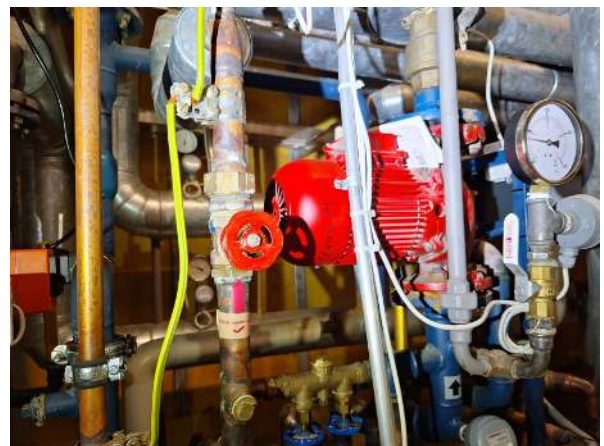
83. Alkuperäisen osan toimilaitteita, kuten pumppuja, on uusittu tarpeen mukaan.
