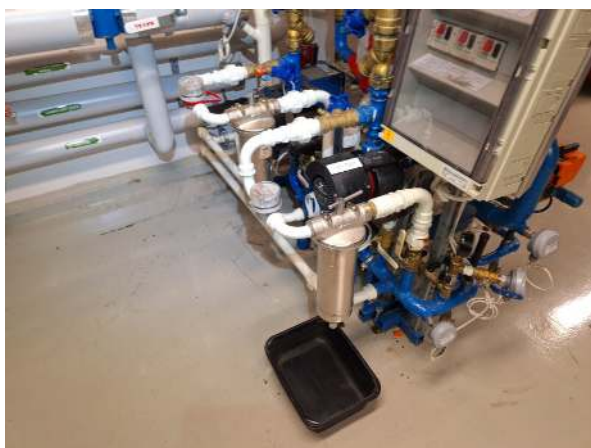
86. Laajennusosan lämpöverkostossa on suodatinjärjestelmä.
