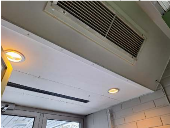
96. Eteisissä on kiertoilmakoneita.
