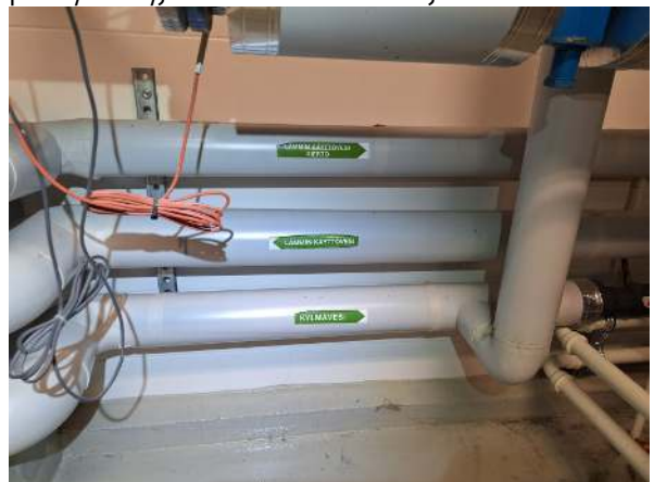
125. Vesijohtojen putkieristykset ovat päällystettyjä mineraalivillakouruja.
