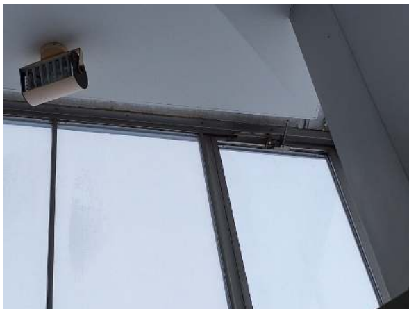
2. Kosteusjälkiä levyrakenteissa valoaukon kohdalla.
