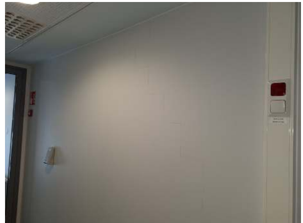
62. Rakenteiden elämisestä johtuva halkeama laajennusosan tuulikaapissa.
