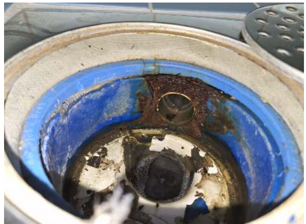
121. Laajennusosan lattiakaivoissa on havaittavissa ruostetta.
