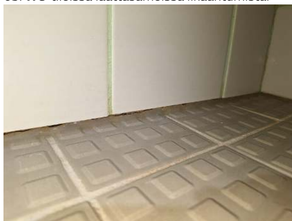
67. Alkuperäinen osa: Pesuhuoneen silikonisaumoissa tiiveyspuutteita.
