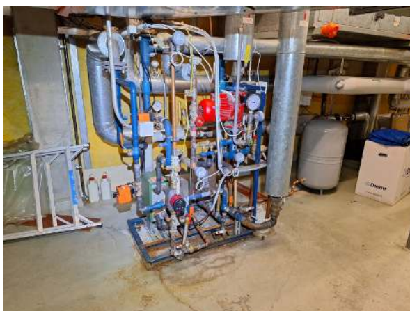
74. Yleiskuva alkuperäisen osan lämmönjakokeskuksesta.
