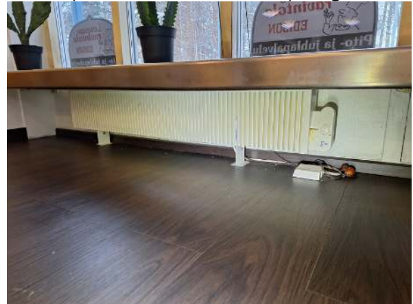
97. Alkuperäisellä osalla on paikon sähköpattereita.
