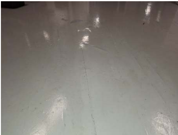
53. Laajennusosa: Lattiapinnoitteissa paikoin pinnoitevaurioita/halkeamia.
