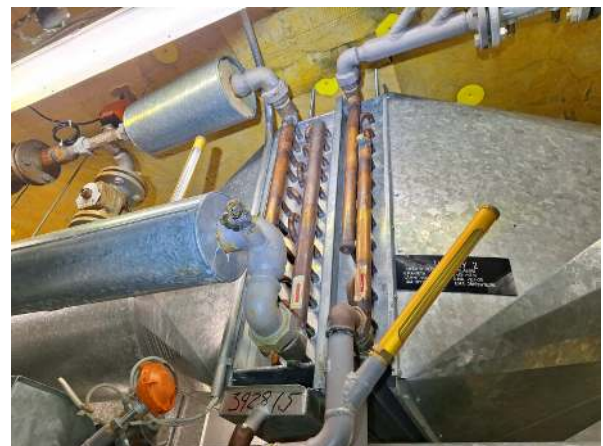
133. Ilmanvaihtokone TK1 on jaettu kolmeen eri alueeseen. Alueiden kanavistossa on lämmitys- ja jäähdytyspatterit.
