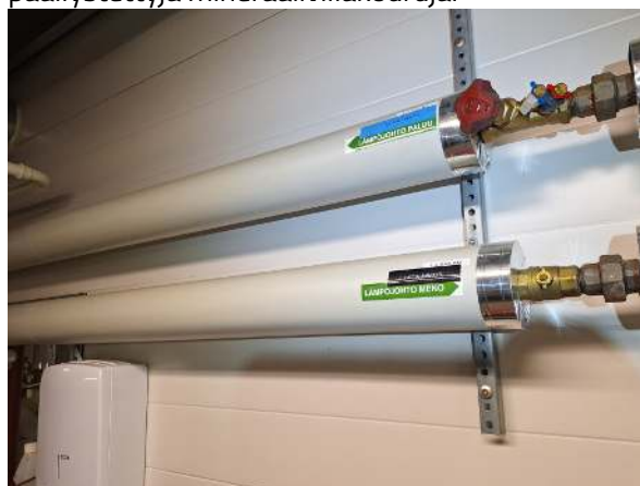
103. Lämpöjohtojen putkieristykset ovat päällystettyjä mineraalivillakouruja.
