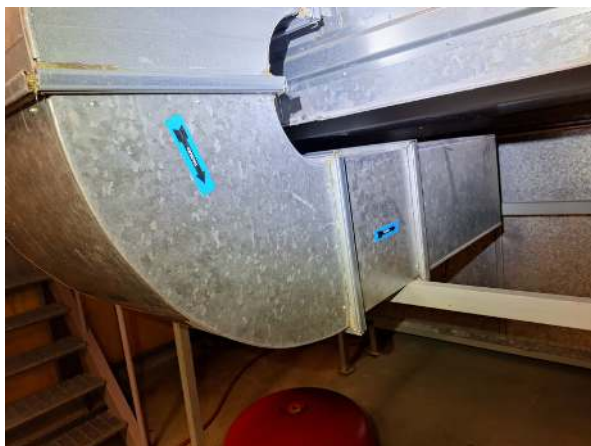
138. Ilmanvaihtokanavat ovat peltiä.
