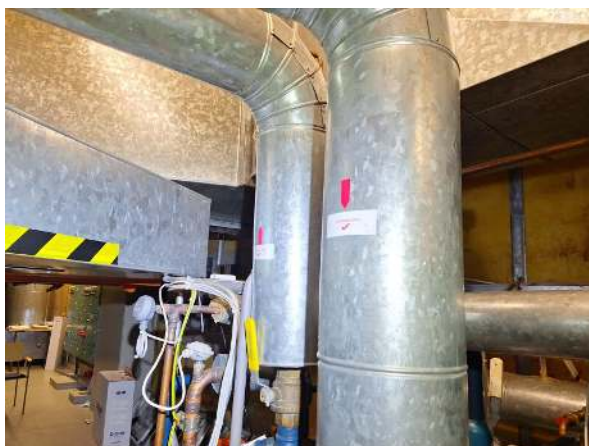
100. Lämpöjohtojen putkieristykset ovat päällystettyjä mineraalivillakouruja.
