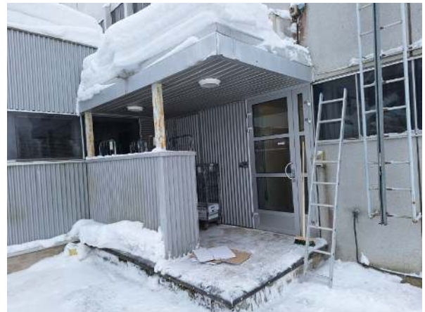
9. Katoksen metallirakenteissa ruostumista
