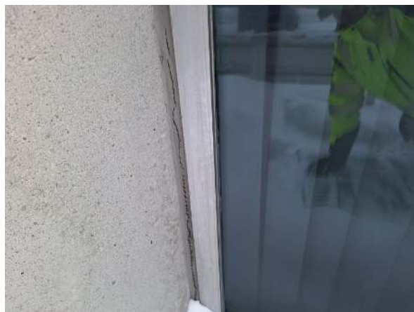
26. Ikkunan saumassa halkeilua.
