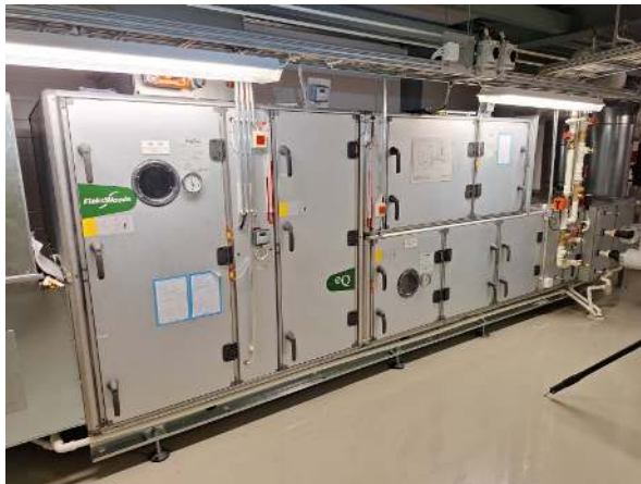
130. Laajennusosan ilmanvaihtokone TK1.
