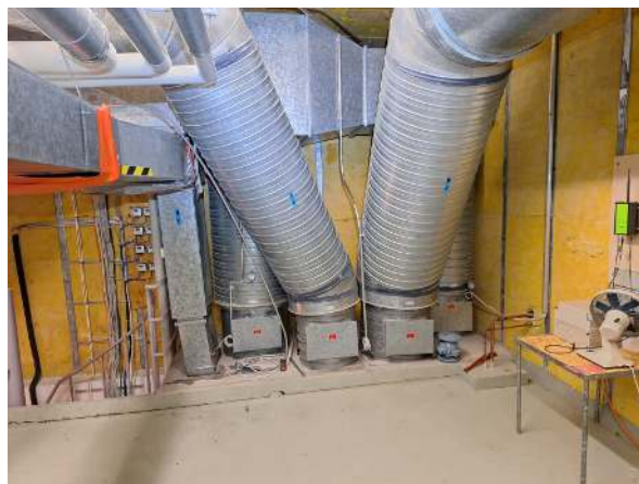
139. Ilmanvaihtokanavat ovat peltiä.
