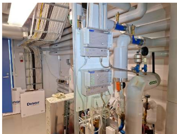
87. Laajennusosan lämpöverkostossa on suodatinjärjestelmä.
