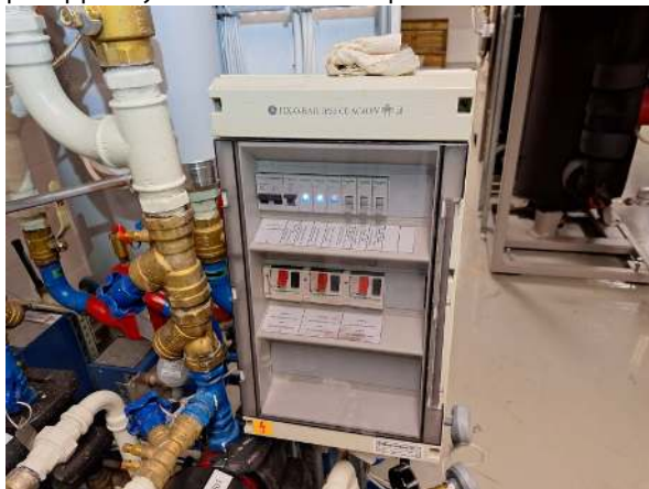
92. Laajennusosan pumppuohjauskeskus on rakennusvuodelta.
