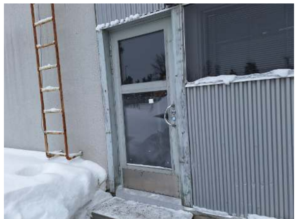
42. Ulko-oven pielilautojen maalipinnoitteet haalistuneet.
