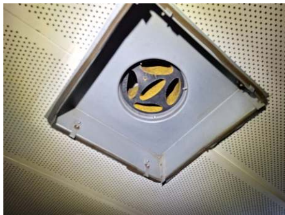
143. Alkuperäisen osan tuloilman kattohajottajien kokoojalaatikoissa havaittiin avointa mineraalivillaa.
