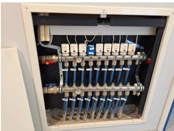
98. Laajennusosalla lämmitys tapahtuu lattialämmityksen kautta.
