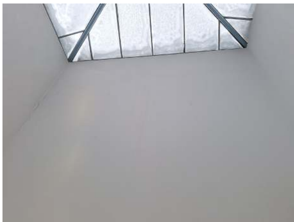
47. Porrashuoneen seinällä ikkunan alla kosteuteen viittaavaa jälkeä.
