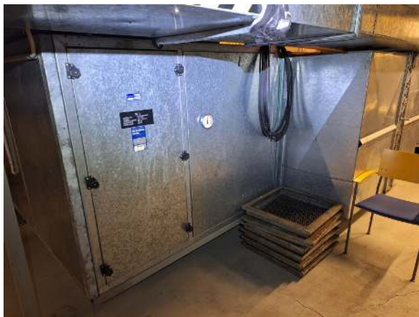
126. Yleiskuva alkuperäisen rakennusosan ilmanvaihtokoneesta TK1.
