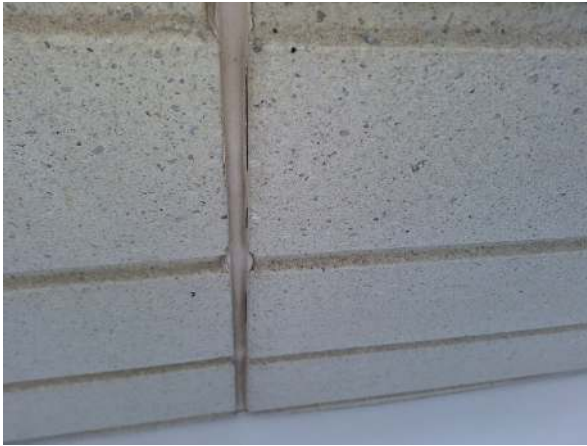
18. Laajennusosalla havaittiin elastisissa samoissa tartuntapuutteita yksittäisessä saumassa
