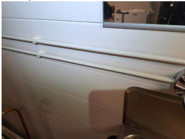
110. Laajennusosan vesijohdot ovat kuparia.
