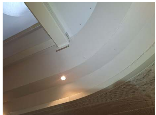
48. Kattokuvun alapuolella levyrakenteessa kosteuteen viittaavia jälkiä.
