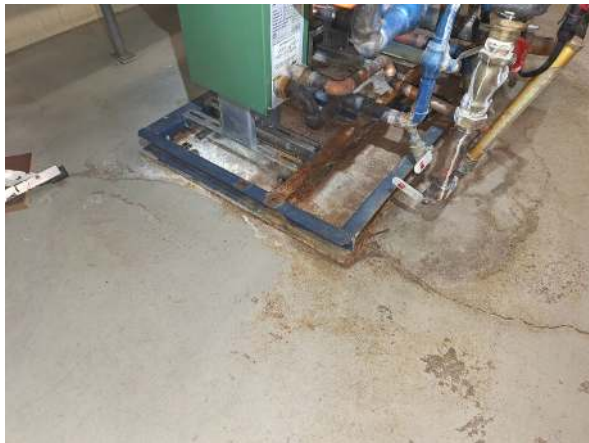
51. Alkuperäinen osa: Lattiapinnoitteet kuluneet ja lattiarakenteessa halkeamia.
