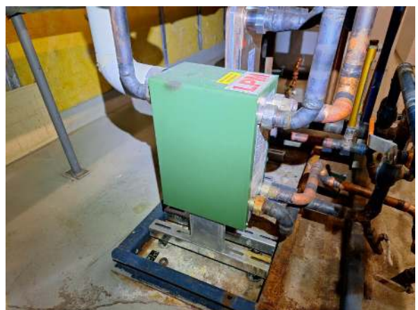
75. Lämmityksen uusittu lämmönsiirrin.
