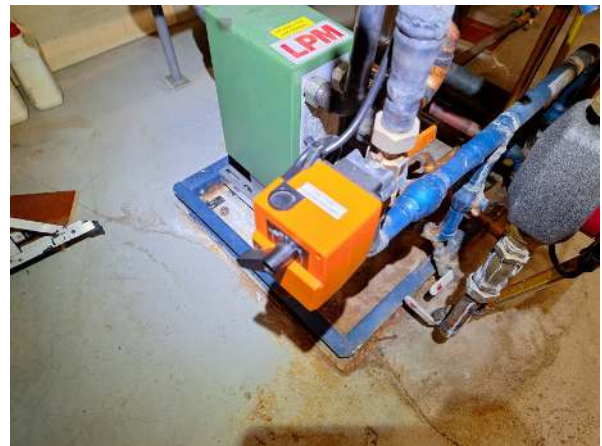
91. Moottoriventtiilit on uusittu vuonna 2010.
