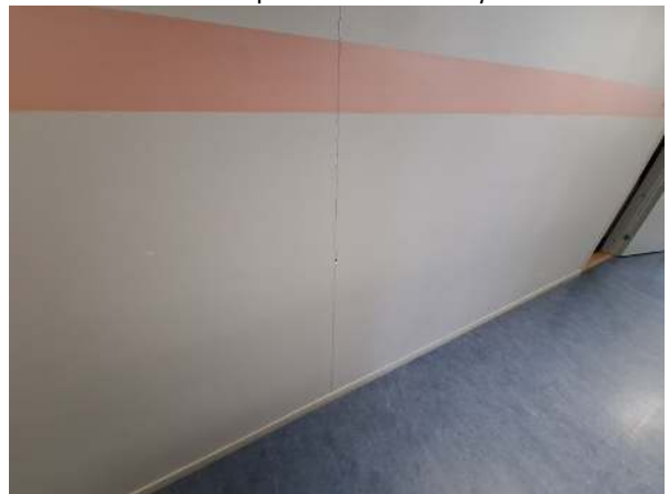
58. Halkeama seinässä alkuperäisen osan käytävällä, 2.krs.
