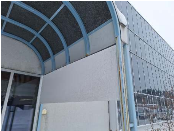
8. Lounasravintolan katoksen metallirakenteissa ruostumista ja maalipintojen haalistumista
