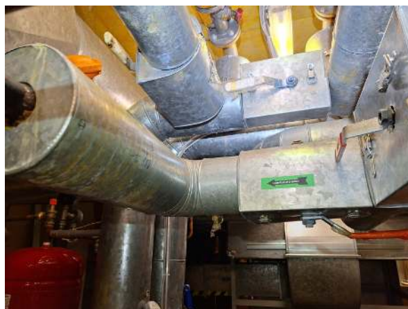
101. Lämpöjohtojen putkieristykset ovat päällystettyjä mineraalivillakouruja.
