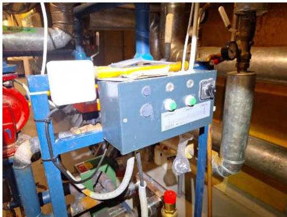
90. Alkuperäisen rakennusosan pumppuohjauskeskus on alkuperäinen.
