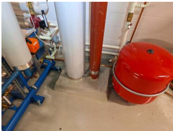
114. Laajennusosalla viemärit ovat paikoin valurautaa.
