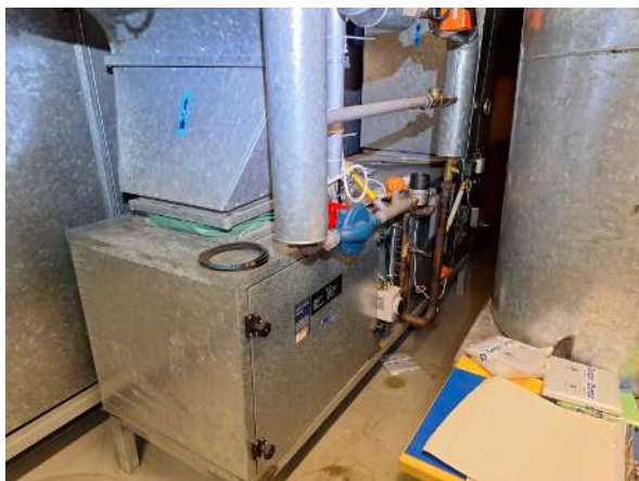
128. Yleiskuva ilmanvaihtokoneesta TK2.
