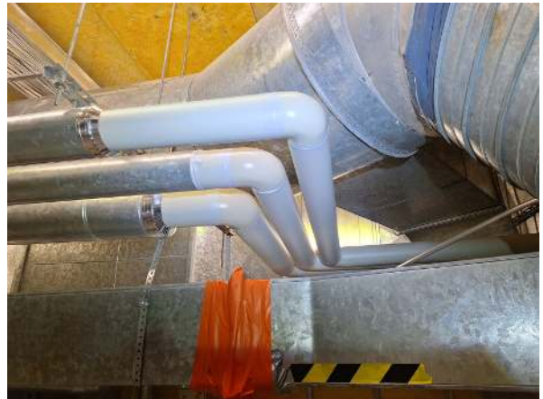
123. Vesijohtojen putkieristykset ovat päällystettyjä mineraalivillakouruja.
