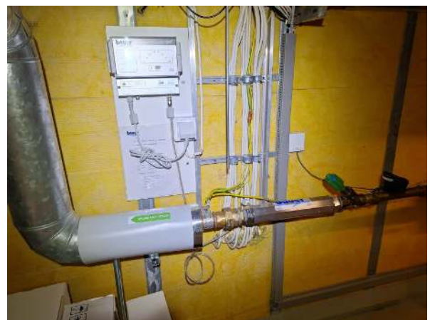
105. Alkuperäisen osalla oleva veden suodatusjärjestelmä.
