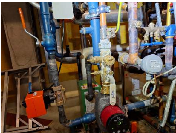
84. Alkuperäisen osan sulku- ja linjasäätöventtiilit ovat pääosin alkuperäisiä.
