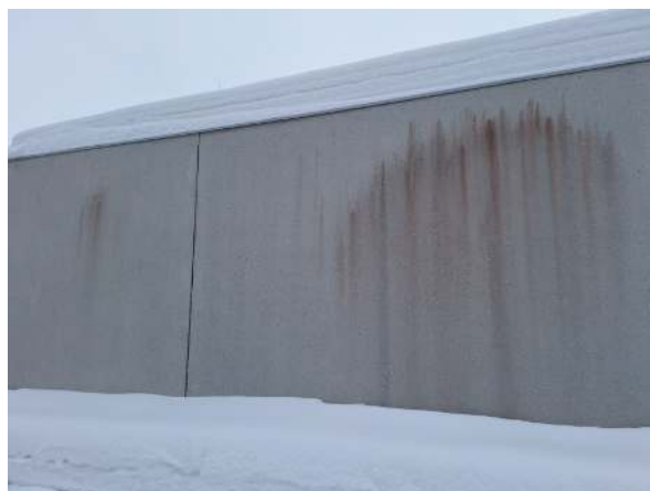
28. Julkisivun betoniosissa paikoin värjäytymää.
