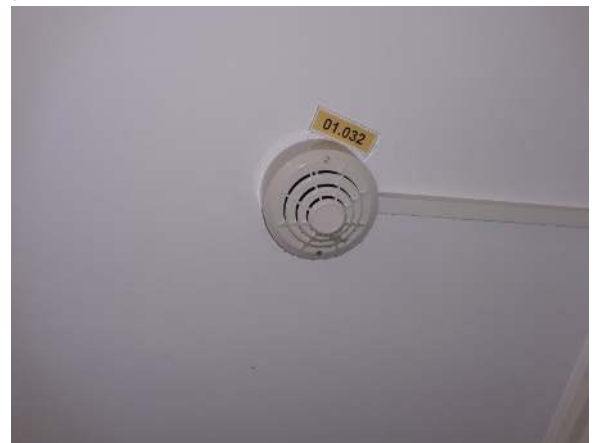
101. Sähköverkkoon liitetty palovaroitin.
