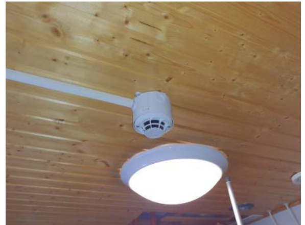
103. Sähköverkkoon liitetty palovaroitin.
