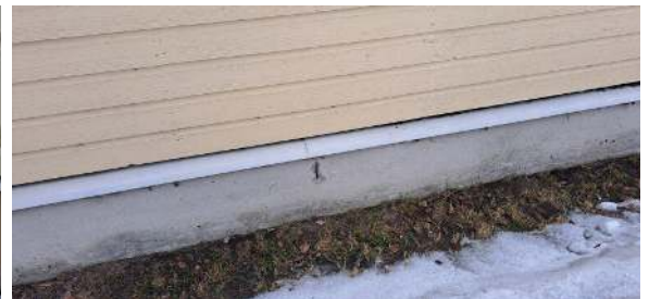
6. Sokkelin raudoitteita näkyvissä
