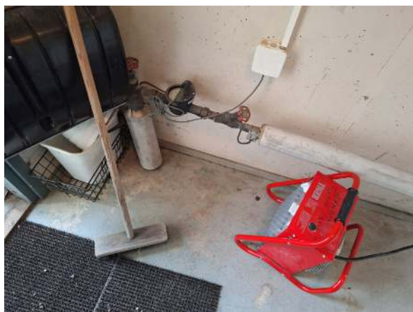
21. Päävesimittari sijaitsee varastossa.
