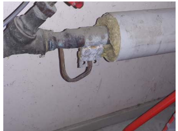
61. Putkiston maadoitus. Hapettunut liitos.
