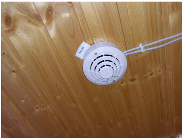
104. Sähköverkkoon liitetty palovaroitin.
