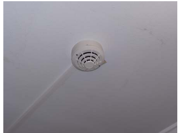
97. Sähköverkkoon liitetty palovaroitin.
