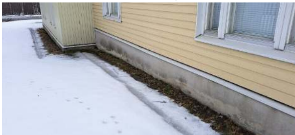
7. Sokkelin betonirappaus paikoin irronnut
