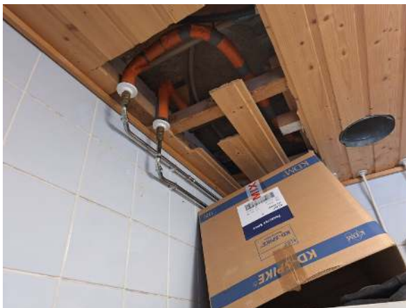
26. Vesijohdot ovat päässeet jäätymään alakattotilassa.
