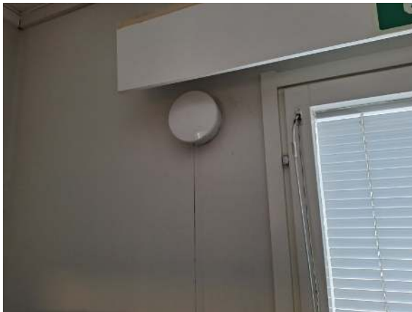
37. Ulkoseinässä oleva korvausilmaventtiili.
