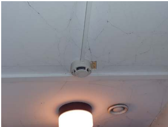
98. Sähköverkkoon liitetty palovaroitin.
