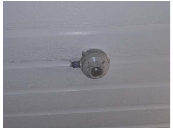
99. Sähköverkkoon liitetty palovaroitin.
