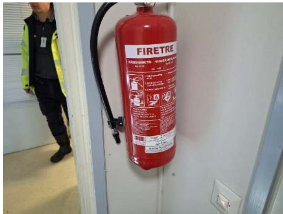
43. Kiinteistössä on alkusammutuskalusteina käsisammuttimia.
