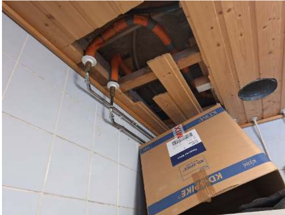
31. Vesijohtoeristeet ovat tyydyttävässä kunnossa.
