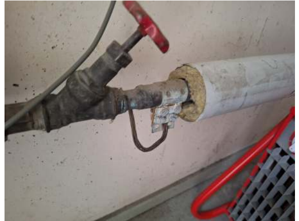
32. Vesijohtoeristeet ovat tyydyttävässä kunnossa.
