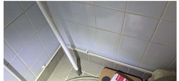
20. Seinän laatoituksessa halkeilua
