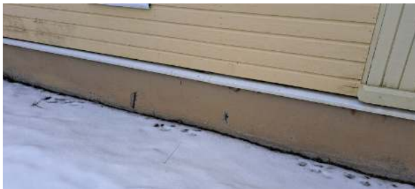
5. Sokkelin raudoitteita näkyvissä
