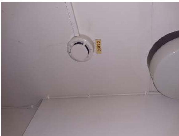
100. Sähköverkkoon liitetty palovaroitin.
