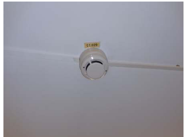
105. Sähköverkkoon liitetty palovaroitin.
