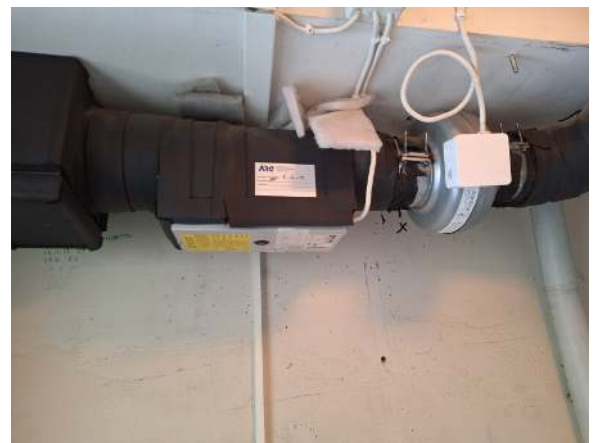
34. Yhteen tilaan johdetaan tuloilmaa kanavapuhaltimella.
