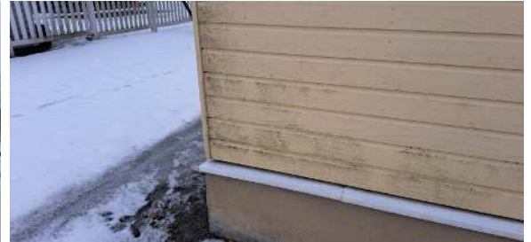
10. Ulkoseinässä paikoin tummentumaa
