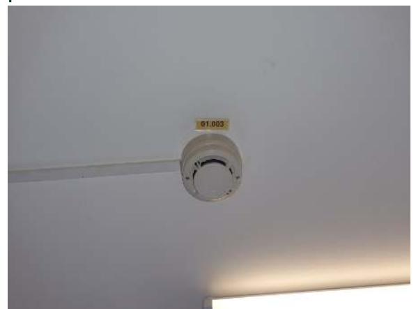
107. Sähköverkkoon liitetty palovaroitin.
