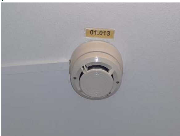
106. Sähköverkkoon liitetty palovaroitin.
