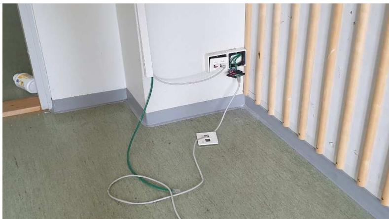
Kuva 11. Yleiskaapelointijärjestelmän kalusteet ja kaapeloinnit irronneena, mahdollisesti ilkvallan seurauksena.
