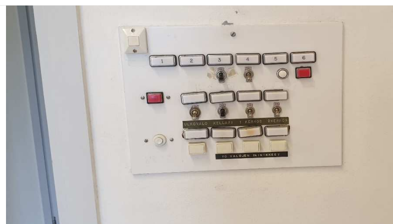
Kuva 4. Heikkokuntoinen valaistuksen ohjauskeskus.
