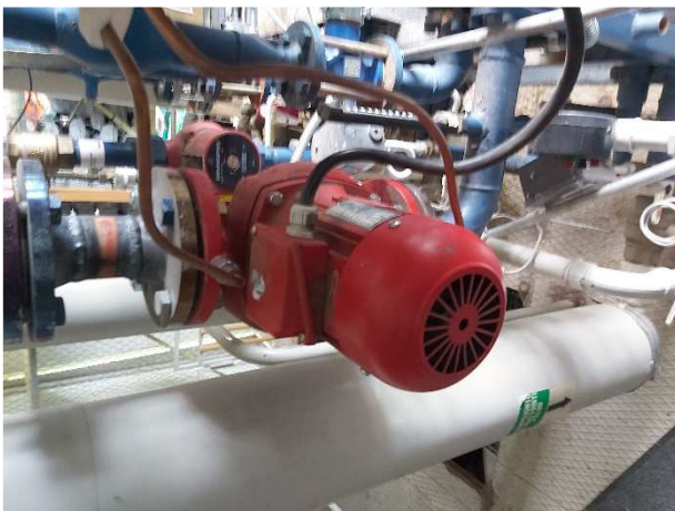
Kuva 86. Ilmanvaihtopiirin pumppu lämmönjako- huoneessa.
