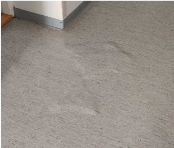
Kuva 22. Alapohjan pintamateriaalina olevassa muovimatossa havaittiin useita kupruja. Viiltokosteusmittauksissa sen maton alusta todettiin selvästi kosteaksi.
