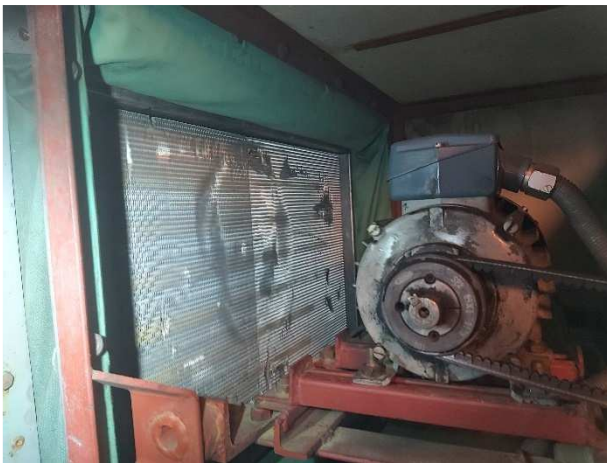
Kuva 130. Lämmityspatterin puhallinkammion puoli. Kuvassa myös moottori ja voimansiirtohihnat.
