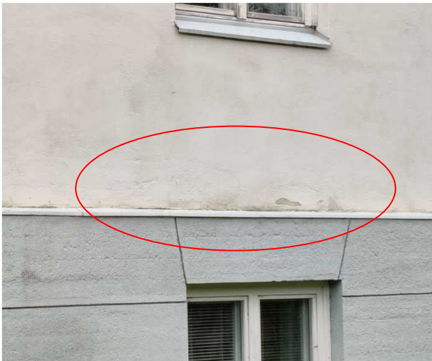
Kuva 20. Pellityksen ja rapatun julkisivun liittymässä on paikoin rapautumaa.
