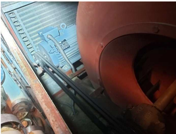
Kuva 148. Lämmityspatterin puhallinkammion puoli. Kuvassa myös moottori ja voimansiirtohihnat.
