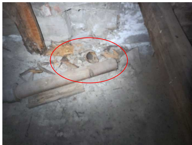
Kuva 113. Katkaistu viemäri yläpohjatilassa.
