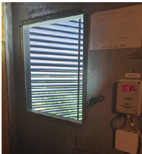
Kuva 144. Raitisilmakammiossa ei ole viemäröintiä.
