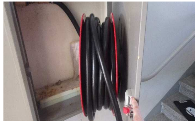
Kuva 171. Porrashuoneissa olevat palopostit.
