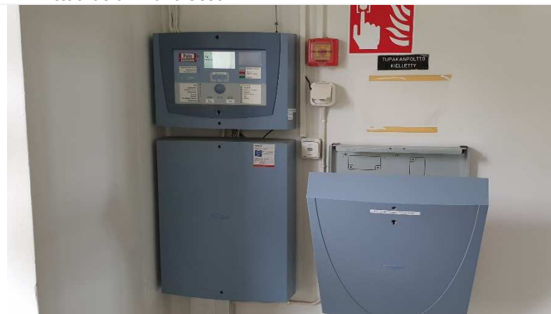
Kuva 16. 2010-Luvulla uusittu paloilmoitinjärjestelmä.
