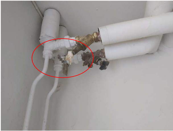
Kuva 94. Runkolinjan linjasäätöventtiili. Venttiili kalkkiutunut.
