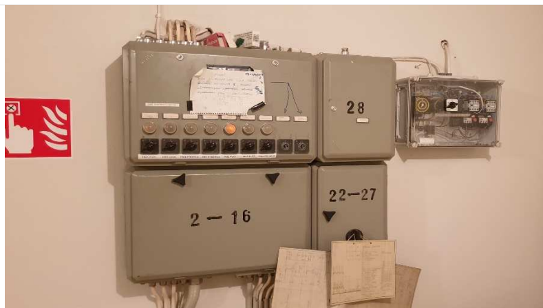
Kuva 1. Rakennuksen tyypillinen jakokeskus 1960-luvun lopusta.
