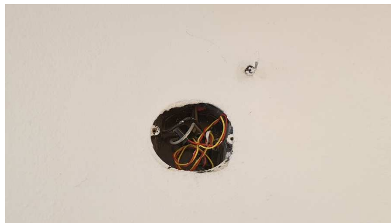
Kuva 8. Jakorasia, josta puuttuu rasiakansi. Kaapelit maallikon kosketeltavissa.
