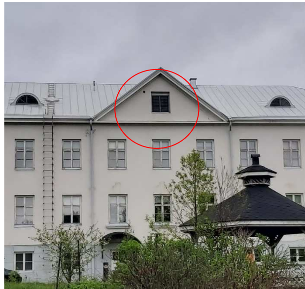
Kuva 153. Jäteilmasäleikkö on rakennuksen takapihan puolella.
