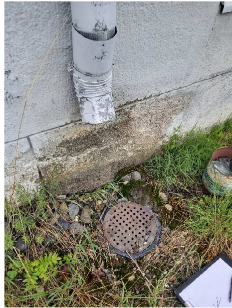
Kuva 19. Perusmuurissa kosteuden aiheuttamia jälkiä.
