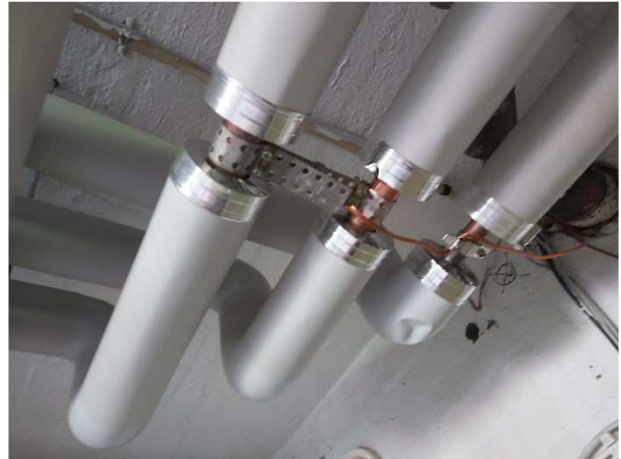
Kuva 107. Käyttövesiputkia teknisessä tilassa.
