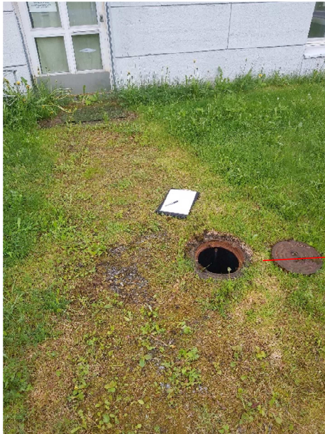
Kuva 114. Toisella lyhyellä sivulla oleva viemärin tarkastuskaivo.
