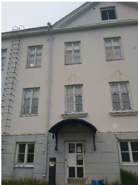
Kuva 36. Ulko-ovet ovat metallirakenteisia. Useasta ovesta on rikottu laseja.
