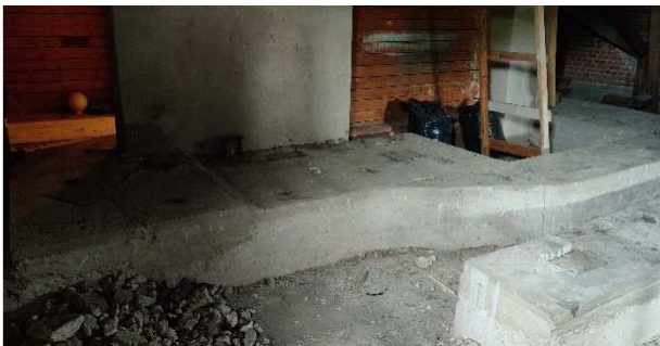
Kuva 58. Yläpohjassa olevat hormit eivät ulotu vesikatolle saakka.
