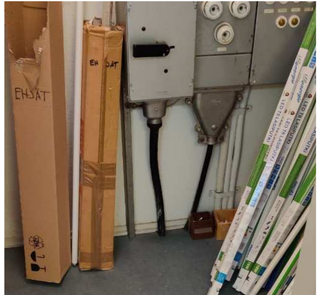
Kuva 27. Tilassa 012 poikkeava haju ja todennäköinen maaperäyhteys
