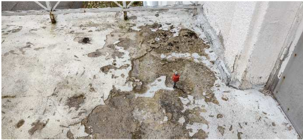
Kuva 44. Parvekkeiden yläpinta on rapautunut.
