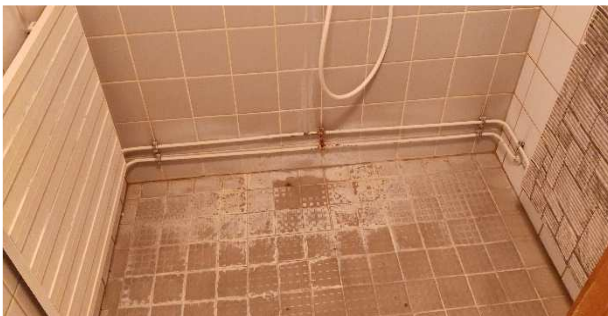
Kuva 72. Pohjakerroksen pesutiloissa havaittiin pintakosteuspoikkeamaa. Lisäksi laatoitus osittain irronnut.
