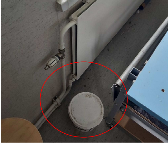
Kuva 122. Tiloissa on alipaineventtiilejä.
