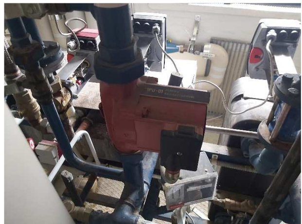
Kuva 87. Patteriverkoston pumppu lämmönjako- huoneessa.
