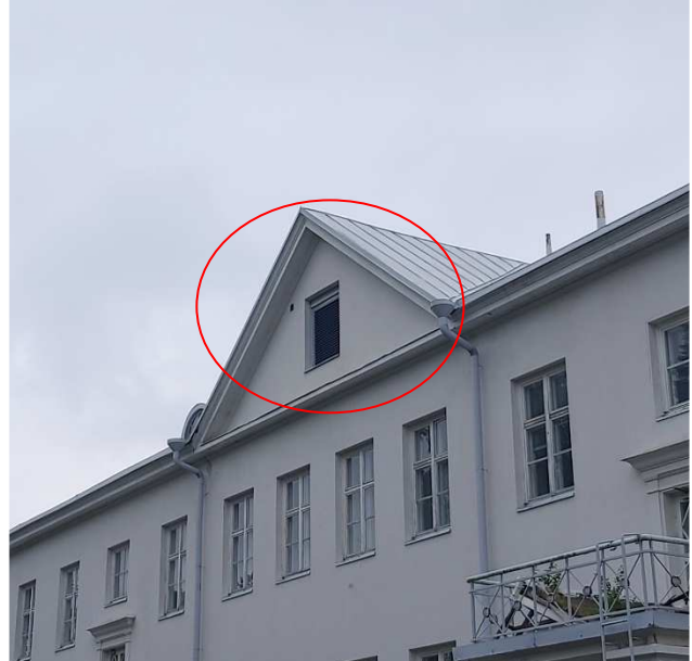
Kuva 125. Raitisilmasäleikkö on rakennuksen etupihan puolella. Säleikössä ei ole lumisieppoa.
