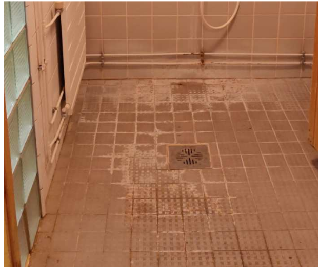
Kuva 23. Tilan 008 laatoitus havaittiin paikoin irronneeksi.
