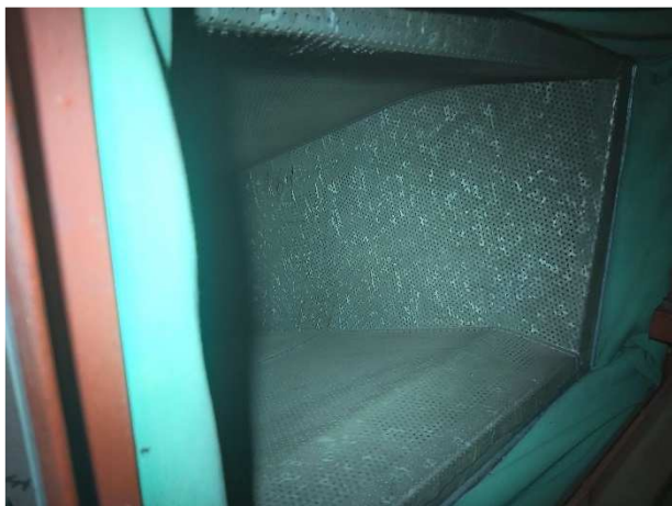
Kuva 138. Poistoilmakammio puhallinkammioista katsottuna.
