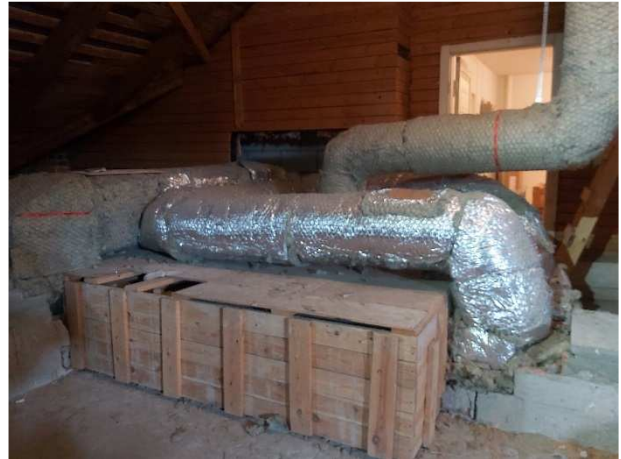
Kuva 159. Yläpohjassa olevat kanavat on eristetty, osasta puuttuu kondenssieristys.
