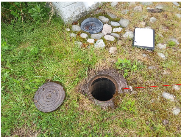
Kuva 11. Etupihan nurkalla oleva salaojan tarkastuskaivo.
