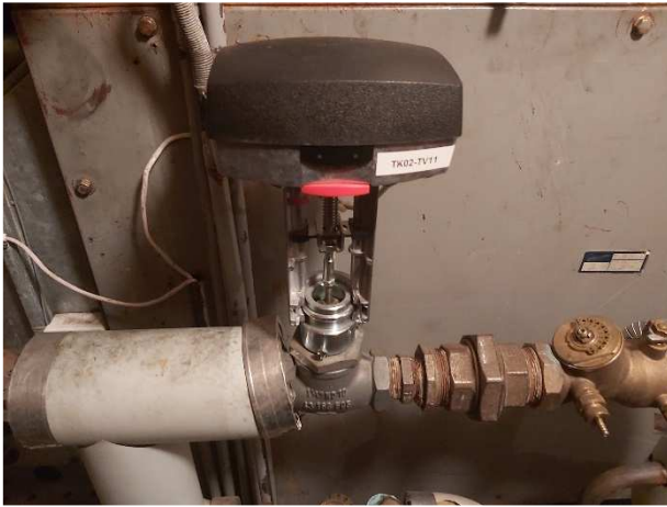
Kuva 98. Ilmanvaihtokoneen TK02 moottoriventtiili.
