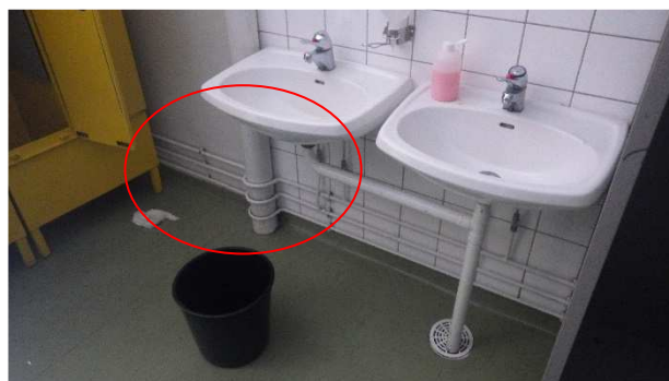
Kuva 111. Tilassa kulkeva pystyviemäri. Viemäri valurautaa.
