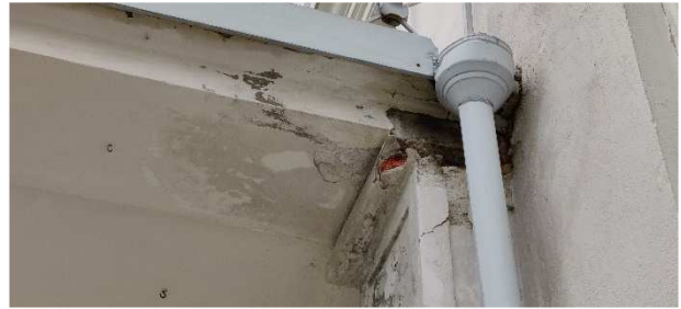
Kuva 45. Syöksytorven liittymässä kosteuden aiheuttamia jälkiä.
