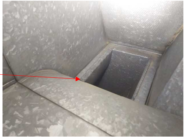
Kuva 133. Kammiossa on reikäpelti-villa-peltirakenne. Kuitujen leviäminen todennäköistä.
