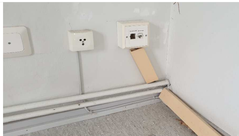
Kuva 12. Yleiskaapelointijärjestelmän kaapelointi asennettu heikkolaatuisesti. Listat kiinnitetty huonosti ja kaapeli vedetty lämpöputkien välistä.
