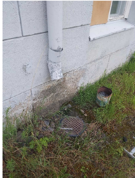
Kuva 10. Takapihalla syöksytorvi on liian korkealla sadevesikaivoon nähden. Seinän alaosa on kosteusjälkiä.
