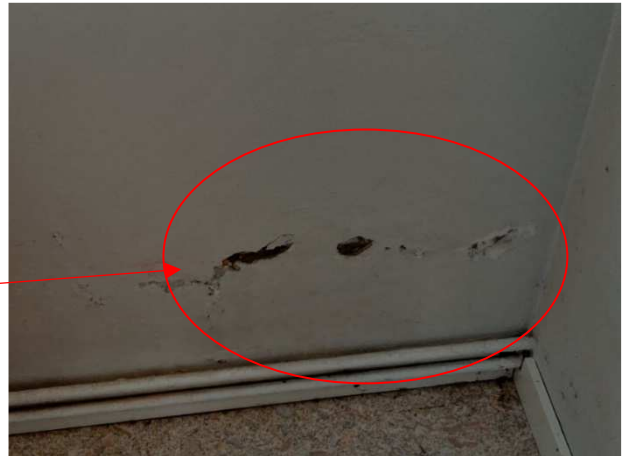
Kuva 31. Sisäpuolella maanvastaisissa ulkoseinissä todettiin pintakosteuspoikkeamaa ja kosteuden aiheuttamia jälkiä.
