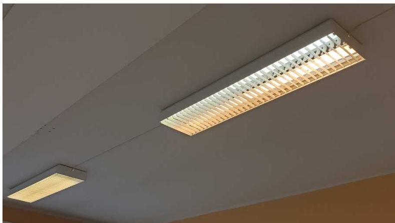
Kuva 5. Lamppuja vaihdettaessa ei ole kiinnitetty huomiota eri sävyisiin loisteputkiin.
