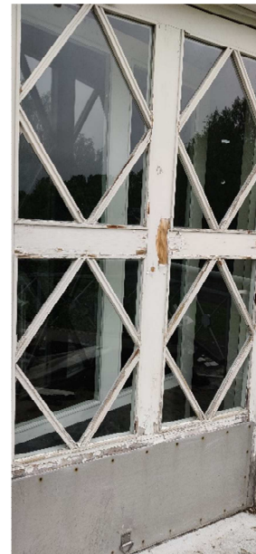
Kuva 39. Kaksiosainen parvekkeen puuovi. Ulkopuoliset osat kuluneet.
