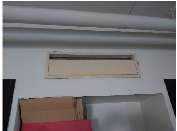
Kuva 165. Siirtoilmasäleikkö. Säleikön sisällä avoimia mineraalivillapintoja.
