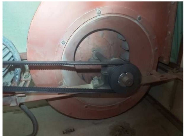
Kuva 157. Kaavullinen radiaalipuhallin. Puhaltimen siivekkeissä reilusti likaa/pölyä.
