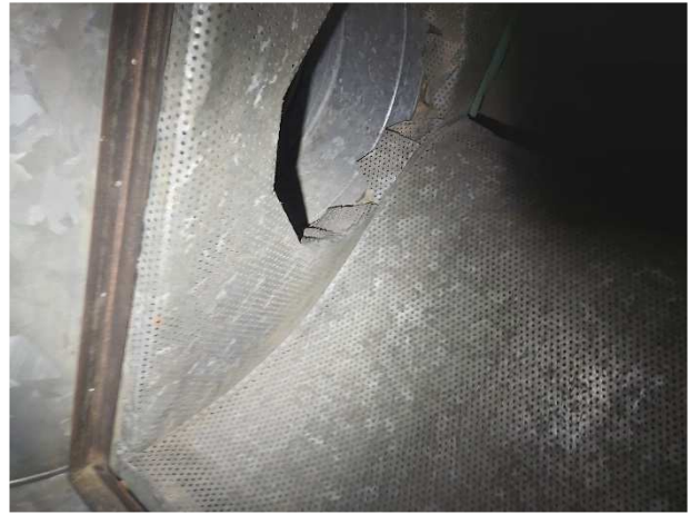
Kuva 155. Kammiossa on reikäpelti-villa-peltirakenne. Kuitujen irtoaminen todennäköistä.
