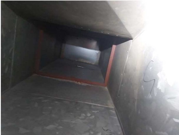
Kuva 158. Kanavistossa havaittiin lievää pölykertymää.
