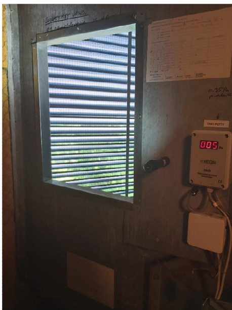
Kuva 126. Raitisilmakammiossa ei ole viemäröintiä.
