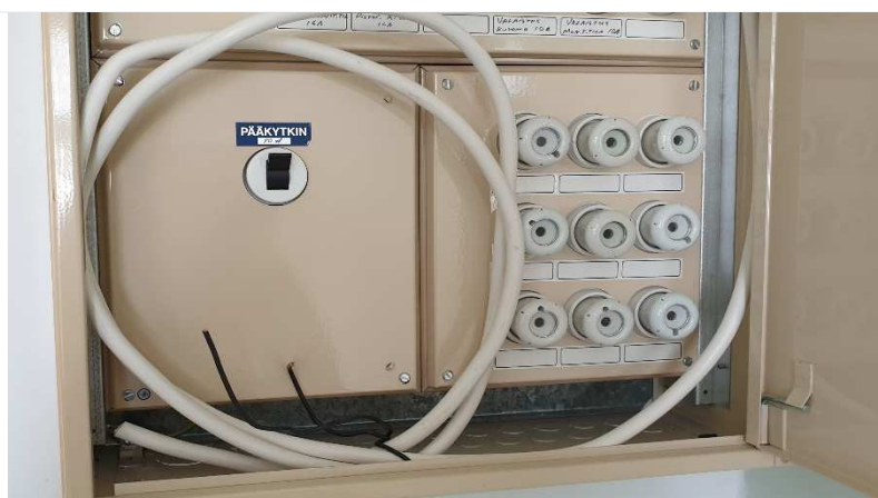
Kuva 3. Uudempi jakokeskus 1980-luvun lopusta. Keskukseen sisällä kytkemätön irtokaapeli.
