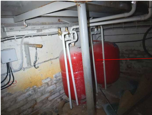
Kuva 90. Paisuntasäiliöt ovat lämmönjakohuoneen alapuolella.
