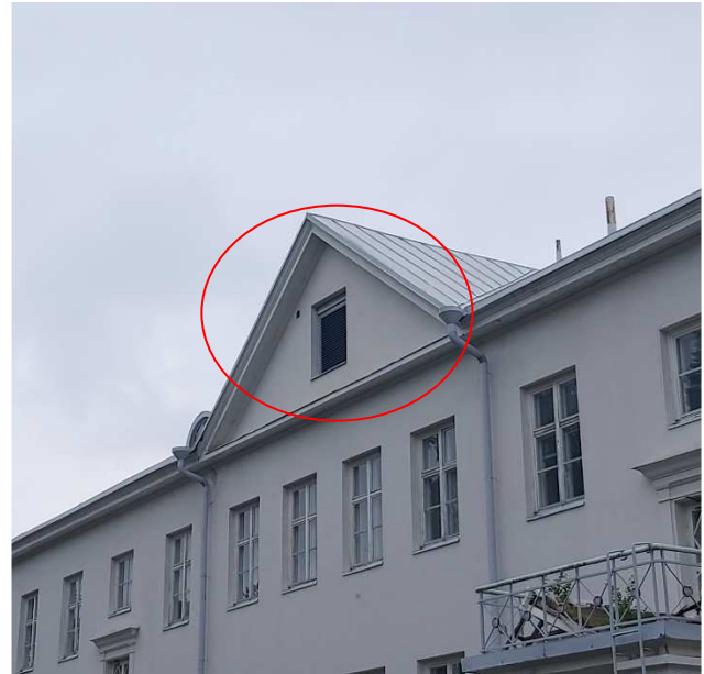
Kuva 143. Raitisilmasäleikkö on rakennuksen etupihan puolella. Säleikössä ei ole lumisieppoa.
