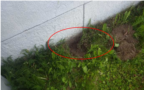
Kuva 13. Takapihalla ja rakennuksen lyhyillä sivuilla ei ole ulkopuolista kosteuseristystä.
