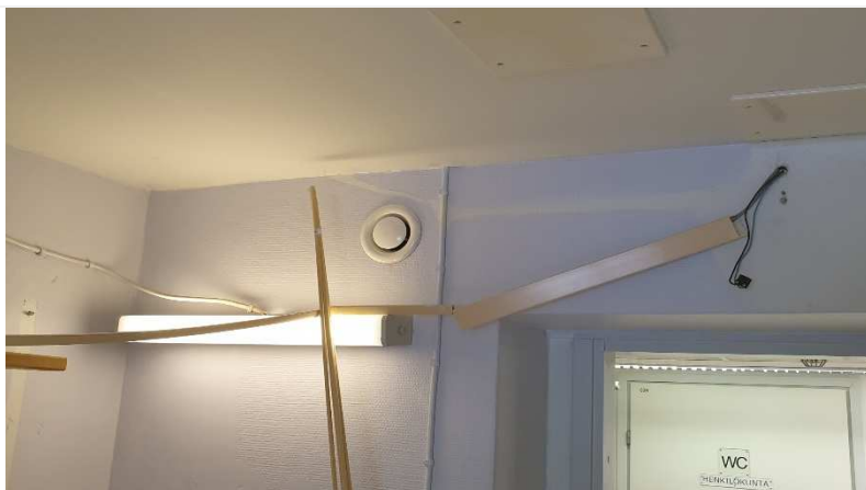
Kuva 15. Sosiaalitilojen irronneita asennuksia.
