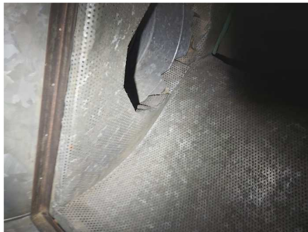
Kuva 137. Kammiossa on reikäpelti-villa-peltirakenne. Kuitujen irtoaminen todennäköistä.
