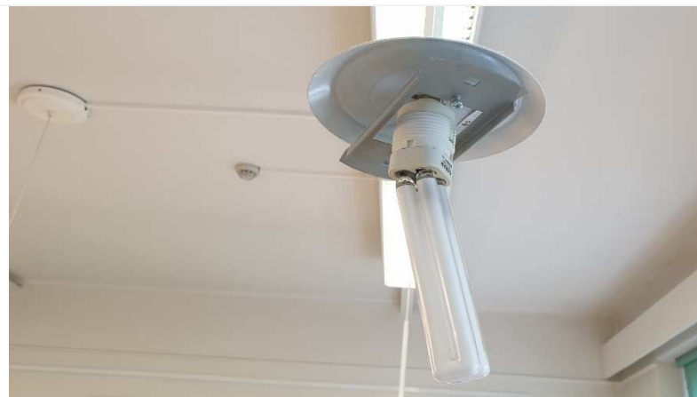
Kuva 6. Pimeänä olevan valaisimen syyksi selvisi vaurioitunut pienoisloisteputkilamppu.
