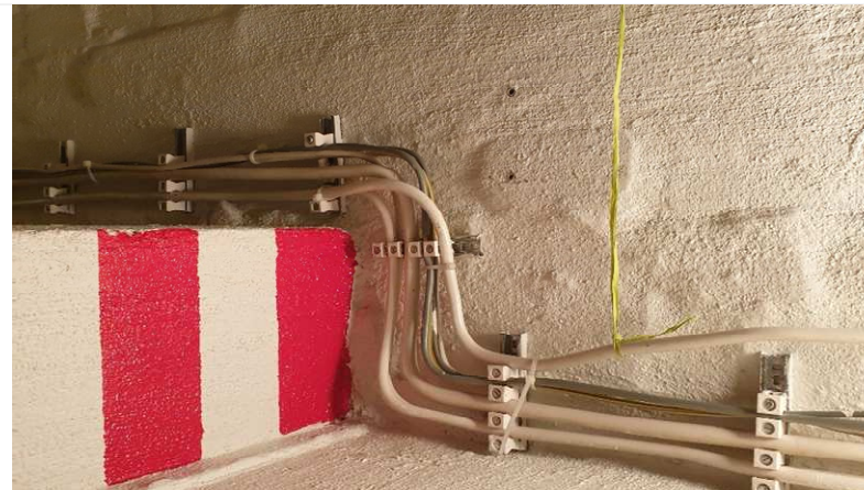
Kuva 14. Kellarikerroksen jälkikäteen tehtyjä sähköasennuksia. Kaapelit tulisi kiinnittää asianmukaisesti.
