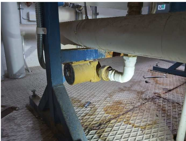
Kuva 92. Lämpimän veden kiertopumppu.
