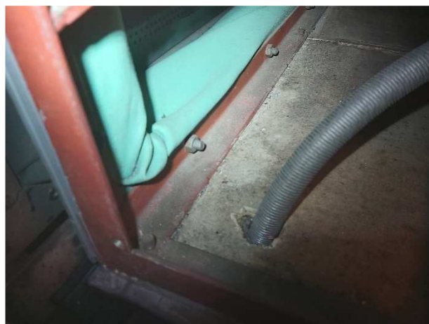
Kuva 141. Ilmanvaihtokoneen sisällä avoimia villapintoja, myös läpiviennit epätiivtiä.
