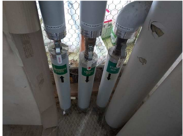
Kuva 105. Viereisen päiväkodin vedenjakelu tapahtuu tutkittavana olevan rakennuksen kautta.
