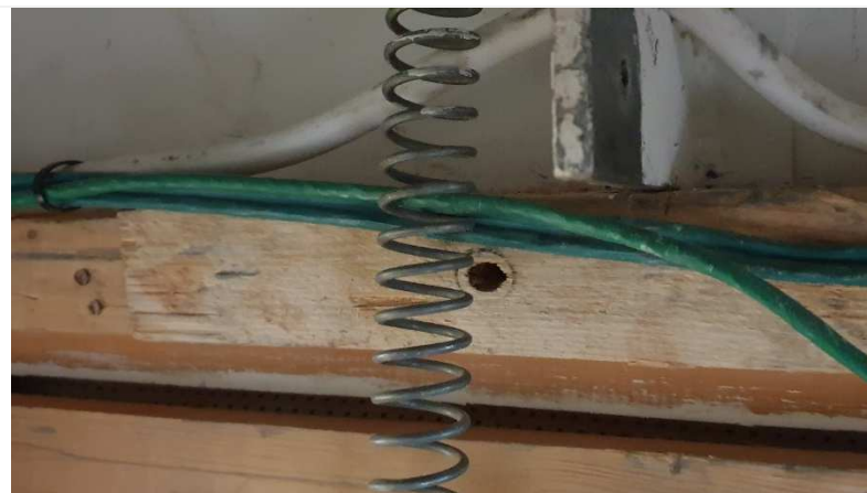
Kuva 10. ATK-kaapeli jumittuneena ullakon luukun jousen väliin.
