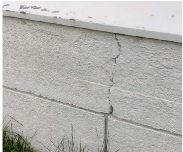
Kuva 21. Perusmuurissa on havaittavissa yksittäisiä halkeamia.
