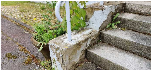
Kuva 46. Parvekkeisiin liittyvissä portaissa on selvää rapautumaa.
