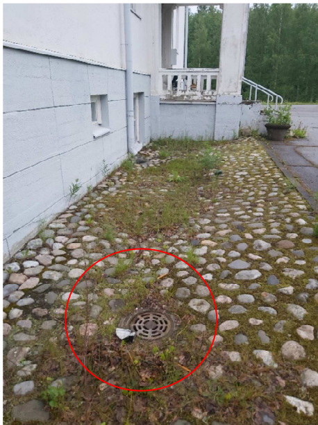
Kuva 7. Etupihan maanpinta kaataa rakennukseen päin. Rakennuksen vierustalla on pintavesikaivo.
