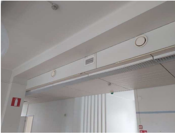
Kuva 162. Tulo- ja poistoilmanpätelaitteet ovat pääsääntöisesti 1990-luvun alkupuolelta.
