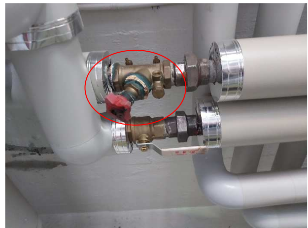
Kuva 93. Lämmönjakohuoneen linjansäätöventtiili. Venttiilissä hapettumaa.
