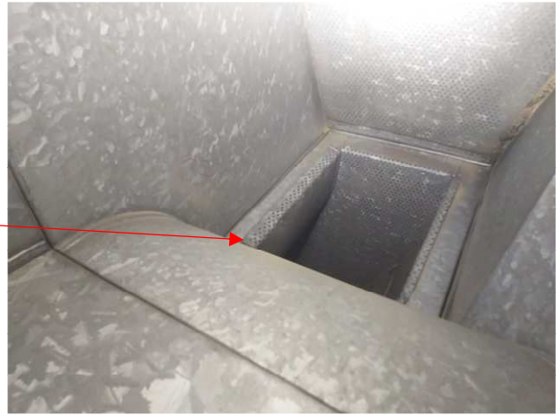
Kuva 151. Kammiossa on reikäpelti-villa-peltirakenne. Kuitujen leviäminen todennäköistä.
