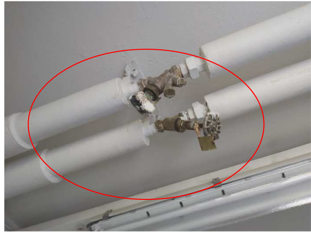
Kuva 95. Runkolinjan linjasäätöventtiili. Linjan eriytykset todennäköisesti asbestipahvia.
