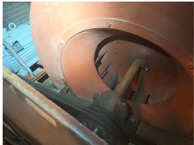
Kuva 149. Kaavullinen radiaalipuhallin. Puhaltimen siivekkeissä reilusti pölyä/likaa.
