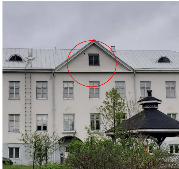
Kuva 135. Jäteilmasäleikkö on rakennuksen takapihan puolella.
