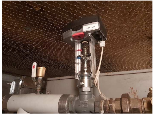
Kuva 99. Ilmanvaihtokoneen TK01 moottoriventtiili.
