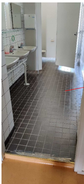
Kuva 78. Toisen kerroksen wc-tiloissa ja viereisessä pyykinhuoltotilassa poikkeavaa hajua.
