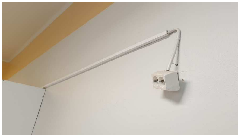
Kuva 7. Keittiön pistorasia irronneena. Puutteellisia asennuksia näkyi kenttäkierroksella enemmänkin.
