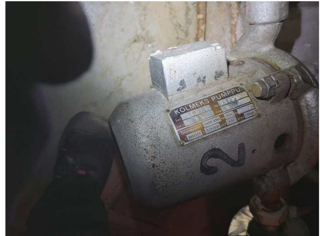
Kuva 89. Ilmanvaihtokoneen TK02 pumppu ilmanvaihtokonehuoneessa.
