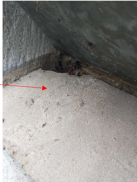
Kuva 35. Vesipenkkipeltien kiinnitykset ja liittymät ulkoseinään nähden puutteelliset.
