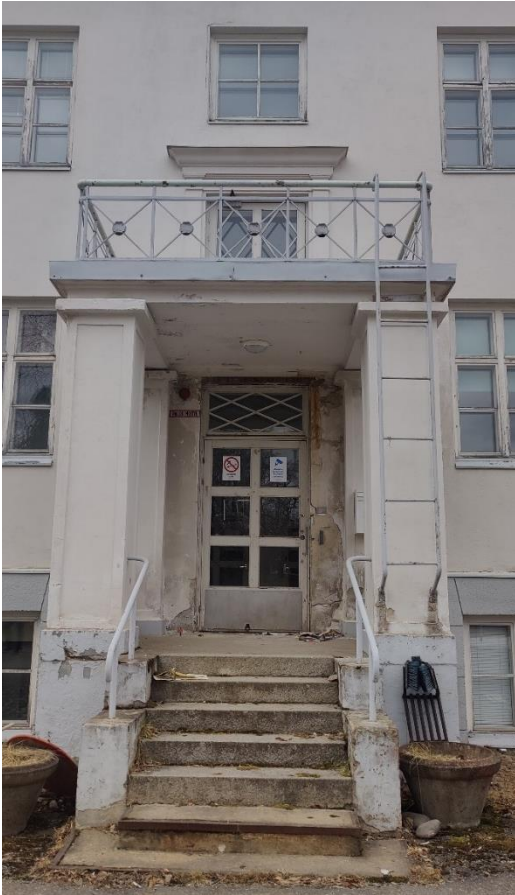
Kuva 6. Toinen pääsisäänkäynneistä. Suojelukohteet vaativat kunnostamista.
