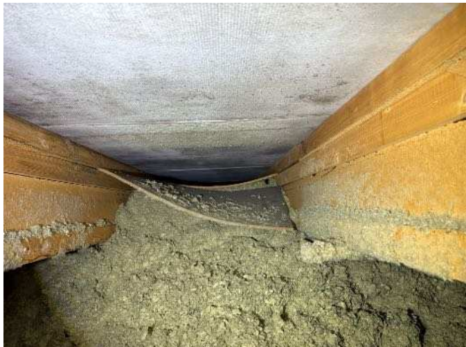
Yläpohjan tuuletuksessa ei havaittu puutteita. Muutamia tuulenhajaimia on irti.
