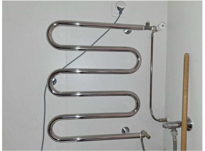
Kuva 15 Kylpyhuoneeseen on asennettu käyttövesi kiertoinen pyyhepatteri.
