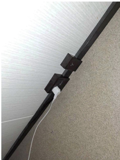
Kuva 6 Sähköjärjestelmä on alkuperäinen, pinta-asennusjärjestelmä.
