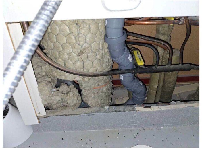
Kuva 19 Hormiin on yhteys huoltoluukusta.
