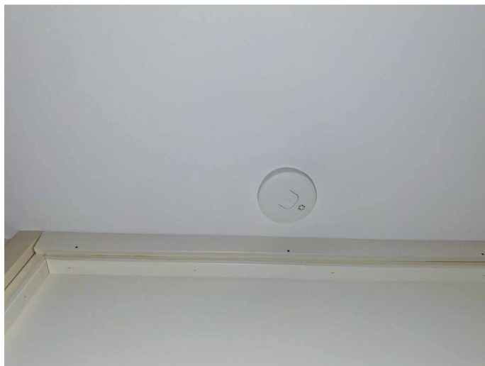
Kuva 7 Huoneistossa on toimiva palovaroitin.
