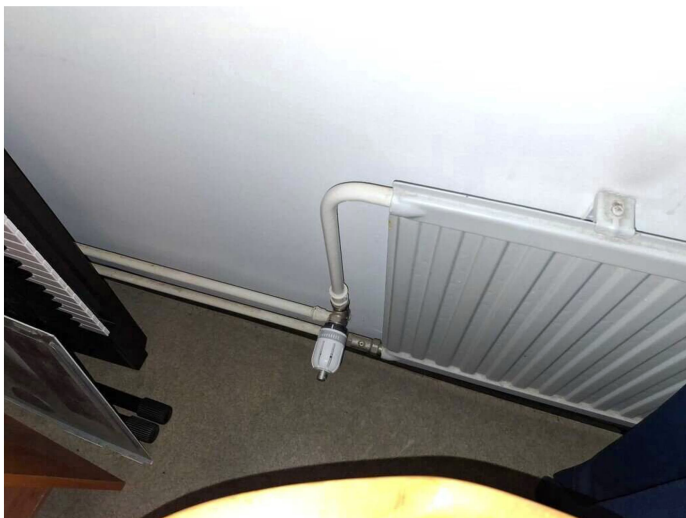
Kuva 12 Lämmitysjärjestelmän alkuperäinen putkisto on terästä , asennettuna pintaan. Pattereissa on termostaatit.
