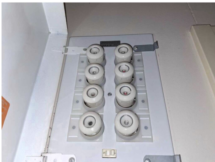
Kuva 8 Huoneiston sähköjärjestelmä on alluperäinen.
