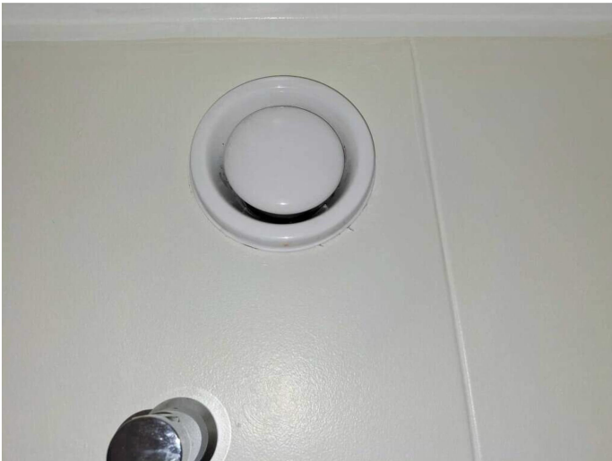
Kuva 24 Kylpyhuoneen poistoilma venttiili on puhdas.
