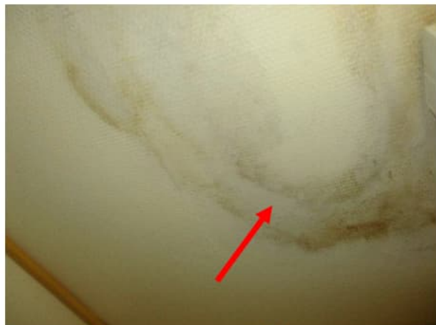
Laipiossa oli havaittavissa vuotojälkiä.
