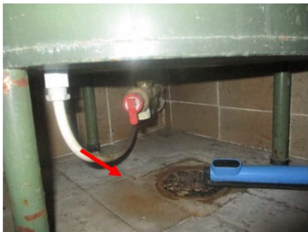
Etenkin lattiakaivon ympärillä lattiassa havaittiin kohonneita pintakosteuksia.
