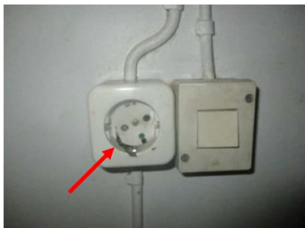
Kellarikerroksen käytävässä oli pistorasia, jonka pohja oli rikki, ja se on korjattava välittömästi (käyttöturvallisuus!).
