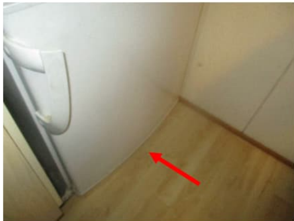
Kylmälaitteen alta puuttuu vuotokaukalo.
