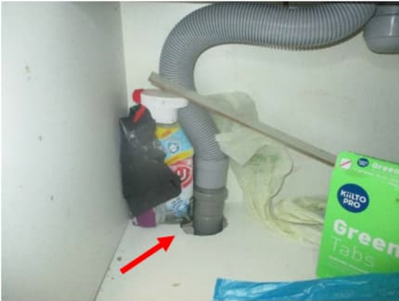
Yleisesti ottaen allaskaapin pohjan läpiviennit / liittymät olisivat suositeltavaa olla tiiviitä.
