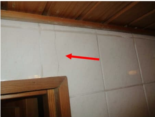
Pesuhuoneen seinälatoitus on halki oviaukkojen kohdalla.
