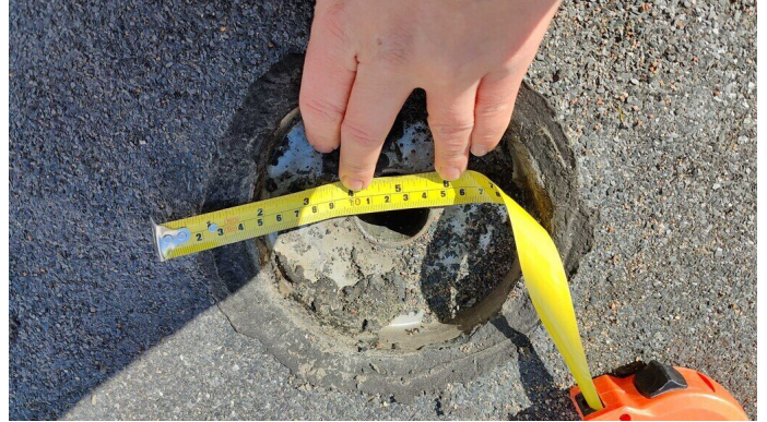
Kuva 18 Sadevesikaivo kermikatto-osuudella on arviolta saneerauskaivo.
