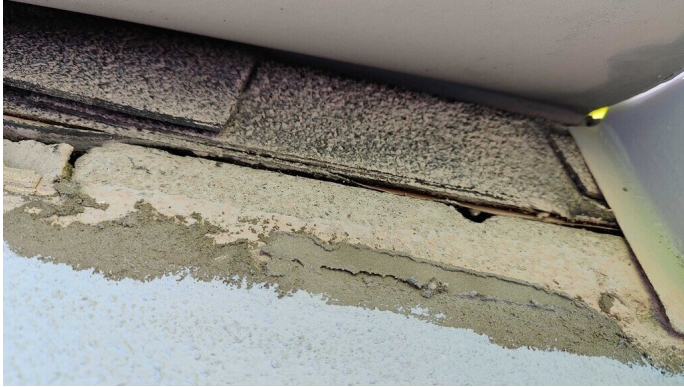
Kuva 17 YP3 räystäs peltiä raottamalla, yksittäisellä kohdalla vaikuttaisi puuttuvan myrskypellitys.
