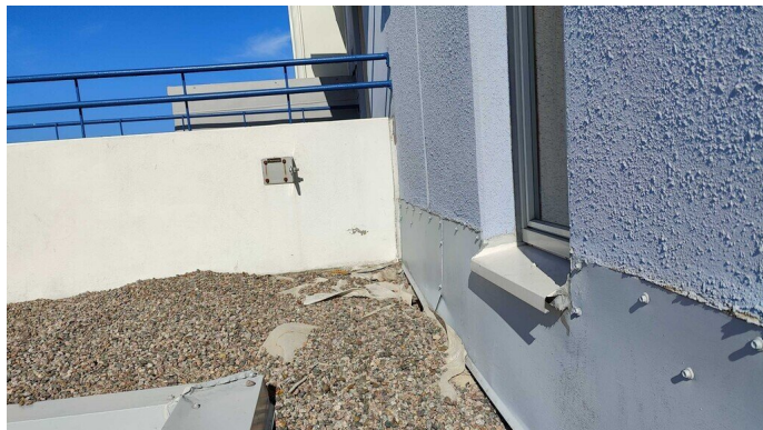
Kuva 12 Käännetyn rakenteen lämmöneristeet ja suodatinkangas puutteellisesti asennettu syksyn 2023 B50-52 vuotokohdan rakenneavausten jäljiltä.
