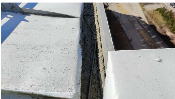
Kuva 15 Peltikatteen alaräystäään sadevesikourussa erityisesti A-portaan kohdalla likaa ja kerrostumaa.
