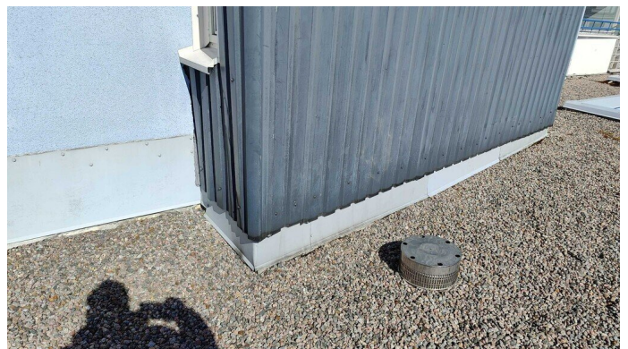
Kuva 22 B-portaan eteläjulkisivulla osittain peltiprofiililla verhottu osuus. Kermiylösnosto sekä profiilipellin tiiveys tarkastettava.
