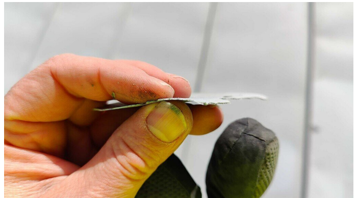
Kuva 8 Pinnoite on paikoin paksu ja lohkeaa taitettaessa.
