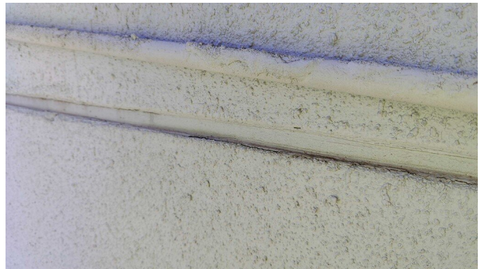
Kuva 20 B50-52 kohdalla elementtisaumojen tiiveys tarkistettava.
