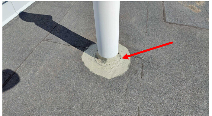
Kuva 10 Kermikatteen läpivientiä paikattu päältäpäin. Tiivistysmassa haljennut.
