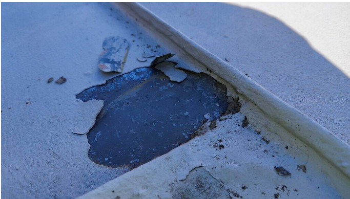
Kuva 7 Pinnoitteen irtoamista peltikaton sauman kohdalla.
