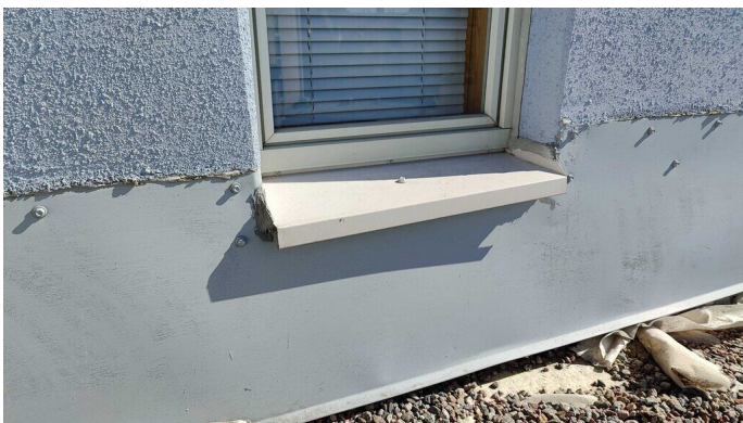
Kuva 21 B50-52 kohdalla ikkunan vesipellin alapuolen tiiveys tarkastettava ylösnoston avauksen yhteydessä.
