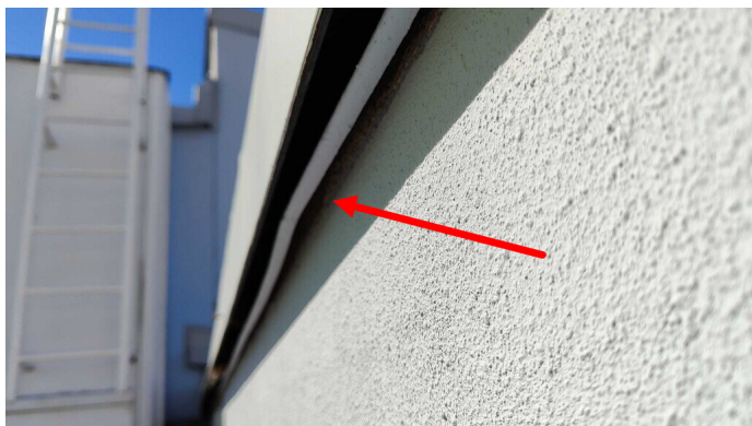
Kuva 13 Peltikaton yläräystäällä myrskypellin ja kuorielementin väli on paikoin auki, ja yleisesti tiivistystä ei ole.
