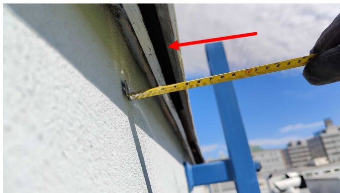
Kuva 14 Peltikaton yläräystäällä tuuletusrako peltikatteen räystääspellin sekä myrskypellin välillä on leveä, suuri riski tuiskulumelle.
