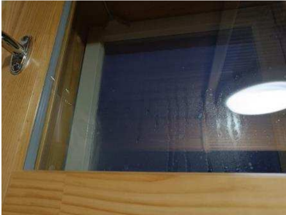
Kuva R27. Yhtiön saunaosaston ikkunan väliin kertyy kosteutta
