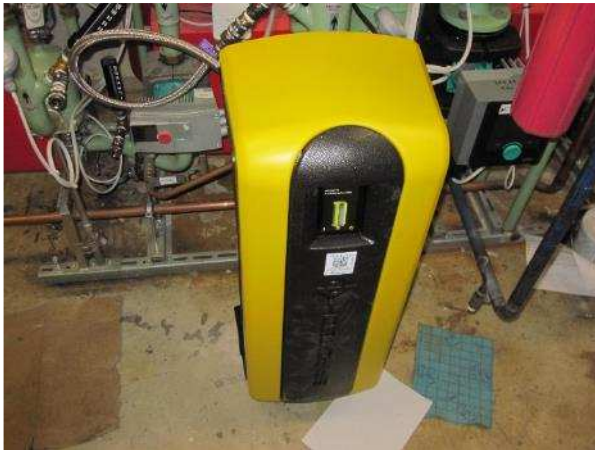
Kuva LVI-3. Patteriverkoston automaattinen koneellinen ilmanpoistolaitteisto.
