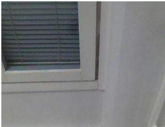
Kuva R29. Kerhuhuoneen ikkunan alareunasta vetää
