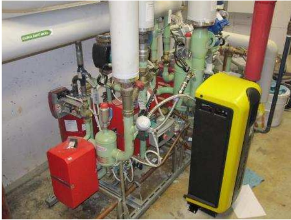
Kuva LVI-1. Lämmönjakokeskus on vuodelta 2010.
