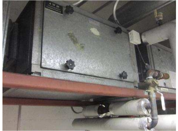
Kuva LVI-18. Varastotilojen tuloilmakojet 4TK.
