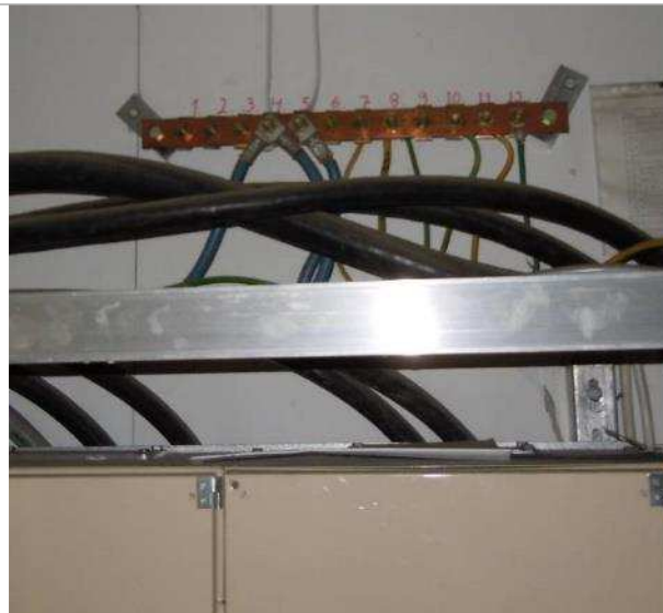
Kuva S-1, Pääkeskustilan päämaadoituskisko
