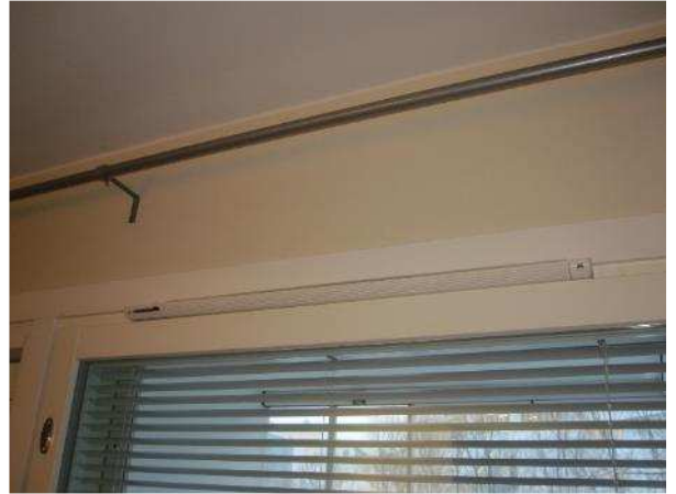
Kuva LVI-20. Korvausilmaventtiili ikkunan karmissa.
