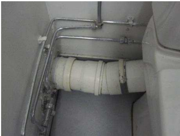
Kuva LVI-13. Kytchentäviemärinä PVC- muoviviemäri.
