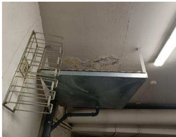
Kuva R38. Pinnoitteiden hilseilyä sadevesikailon alapuolella, vuotojen takia lisätty kaukalo.
