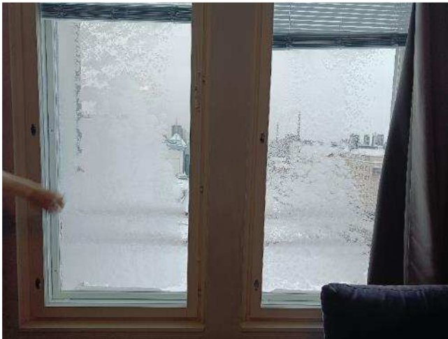
Kuva R26. Yleiskuvaa ikkunoista sisäpuolelta, ikkunaväliin on jäänyt kosteutta ulkolasin sisäpintaan
