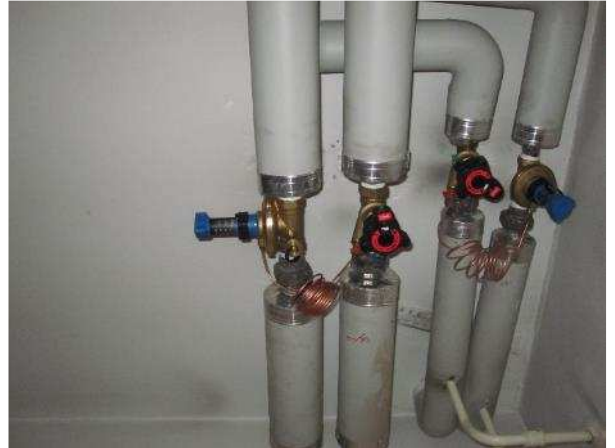
Kuva LVI-6. Sulku- ja linjasäätöventtiilit on uusittu vuonna 2023.
