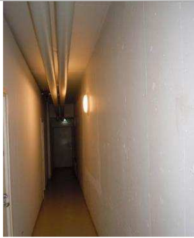
Kuva S-19, Kellarikäytävän uusittuja valaisimia
