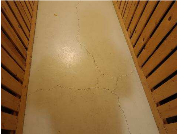
Kuva R10. Halkeilua kellarin lattiassa
