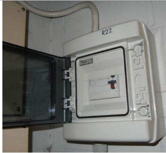
Kuva S-9, Lisätty vikavirtasuoja
