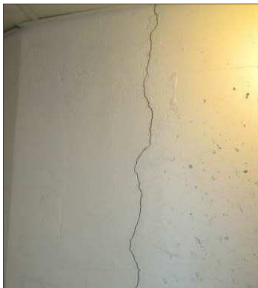
Kuva R40. Kellarin seinän halkeama kuvattu 2017
