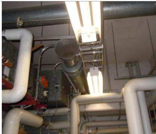
Kuva S-21, Lämmönjakohuoneen valaisin
