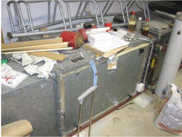
Kuva LVI-17. Myymälän ja työtilojen tuloilmakojet 3TK.
