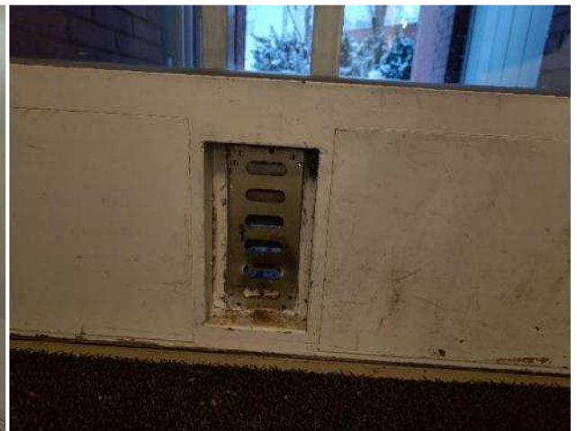
Kuva R33. Kellarikerroksen ulko-oven tuuletus-säleikkö on rikki
