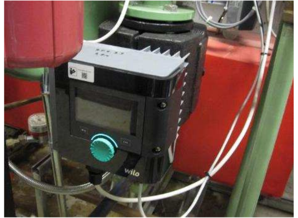
Kuva LVI-2. Lämmitysverkoston kiertovesipumppu on uusittu vuonna 2023.
