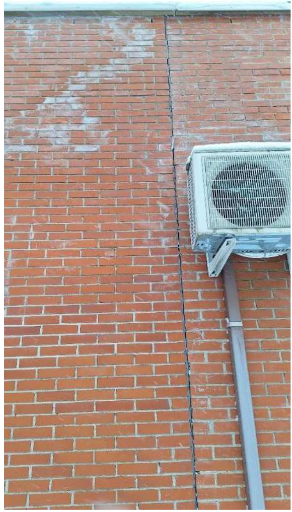
R18. Tiilijulkisivun liikuntasaumot ovat epätiivit
