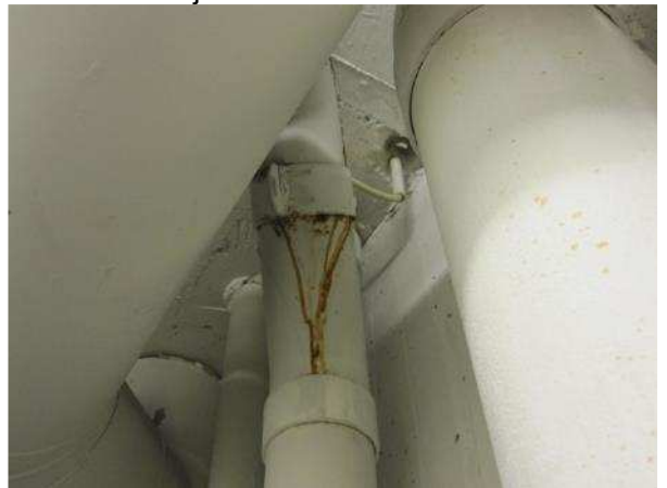
Kuva LVI-14. Valurautaviemäri pantaliitoksin kellarissa. Vanhoja vuotojälkiä.
