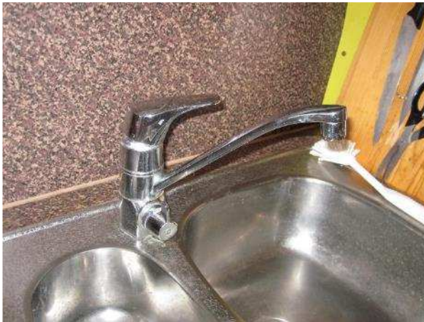
Kuva LVI-15. Kuvassa on keittiöhana pesukoneventtiilein.
