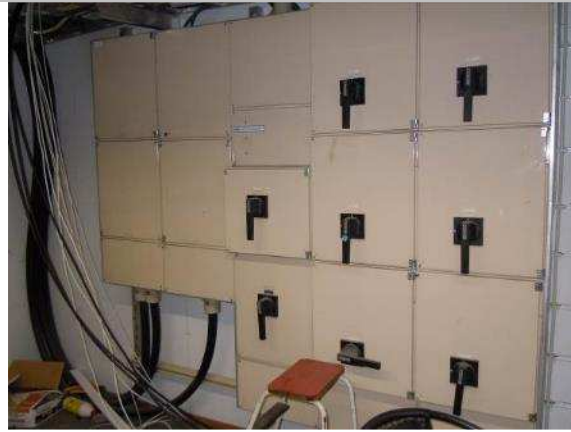
Kuva S-3, Pääkeskus PK
