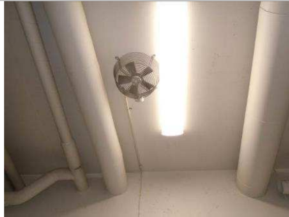
Kuva S-17, Kuivaushuoneen loisteputkivalaisin
