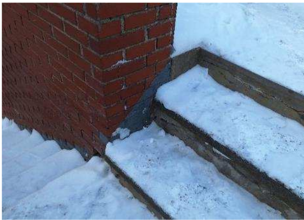
Kuva R2. Pihakannen portaiden vedeneristeet ovat puutteelliset.
