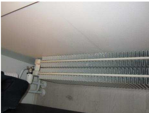
Kuva LVI-7. Lämmityspatterit ovat teräslevypattereita ja kuvan tyyppisiä konvektoreita.
