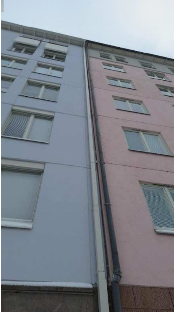
Kuva R17. Rakennusten välinen sauma on epätiivis
