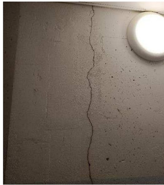
Kuva R41. Sama halkeama kuvattu 2024
