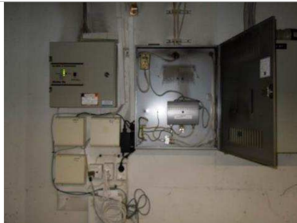
Kuva S-27, Antennivahvistinkaappi pääkeskustilassa
