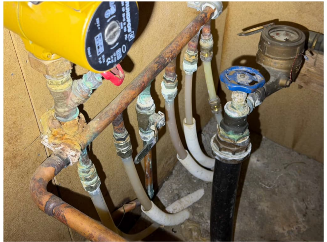
Kuva 18. Putkistot koostuvat kupari- ja muoviputkista, paikallista korroosiota ja ruostetta jakotukkien kohdalla.
