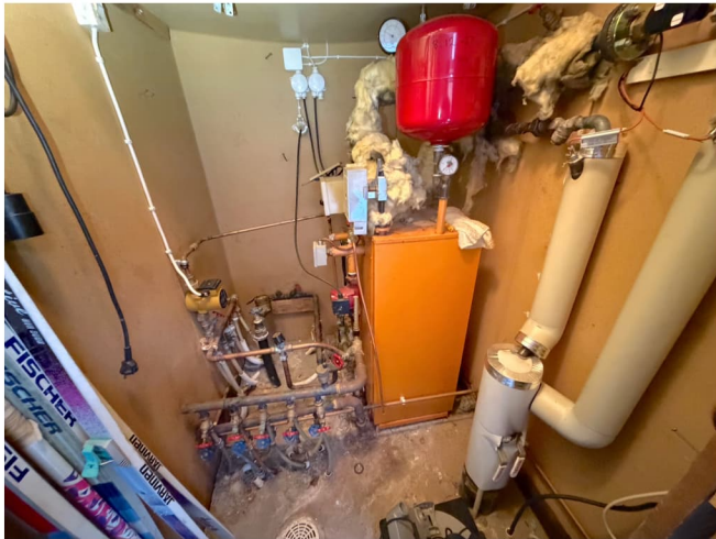
Kuva 17. Kaukolämpö, lämmönvaihdin vuodelta 1979.
