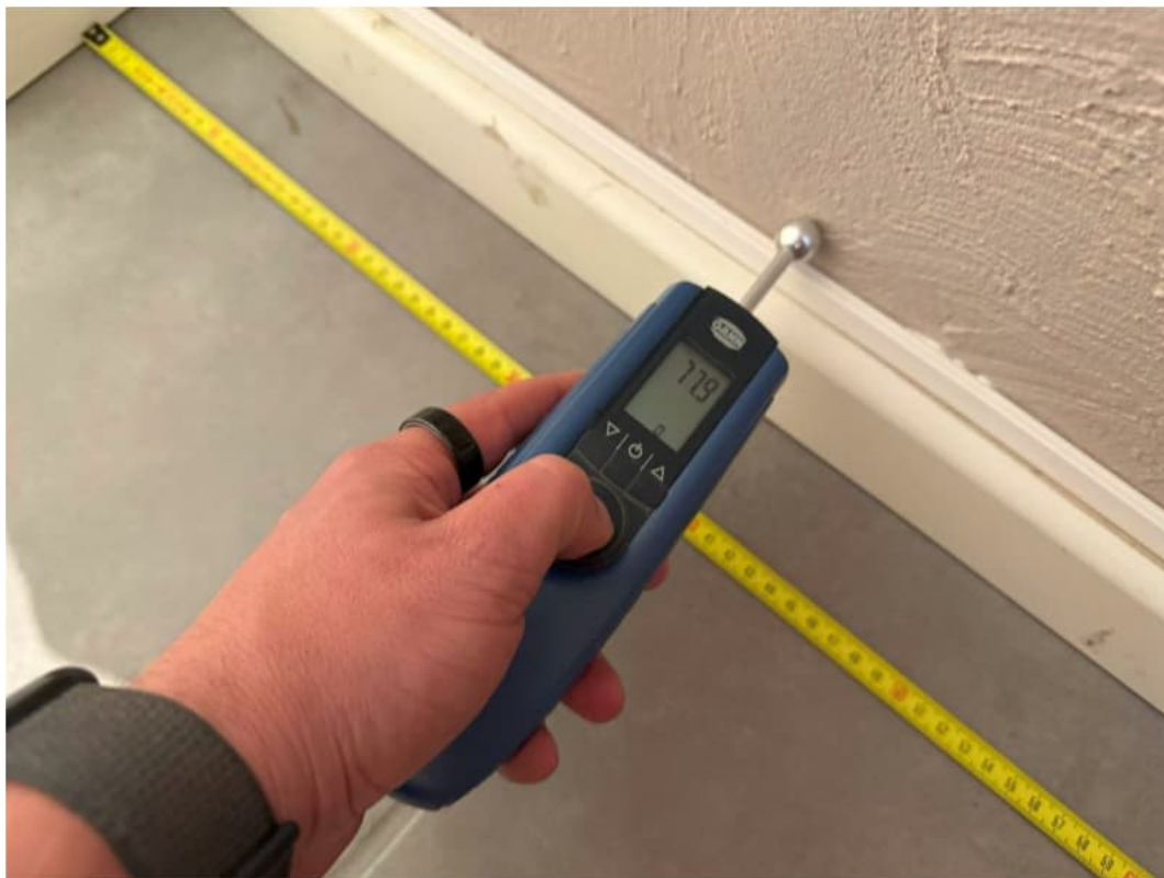
Kuva 8. Päätyseinän osalla kosteusarvot tippuvat normaaliksi noin 40 cm jälkeen
