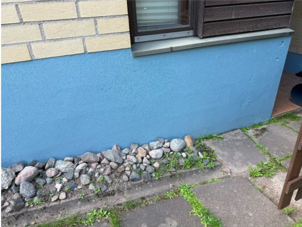
Kuva 13. Ulkonurkka etupihan puolella märkä alapäästään
