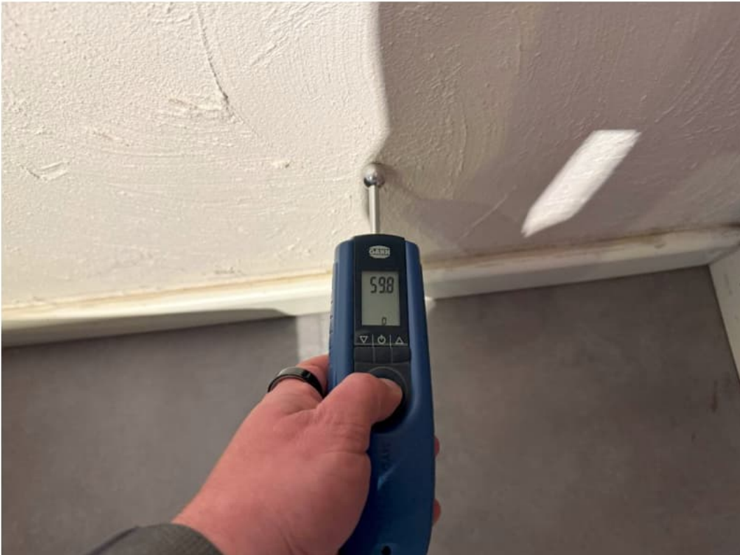
Kuva 10. Takapihan seinän alapäätä noin 20 cm korkeudelta lattiasta
