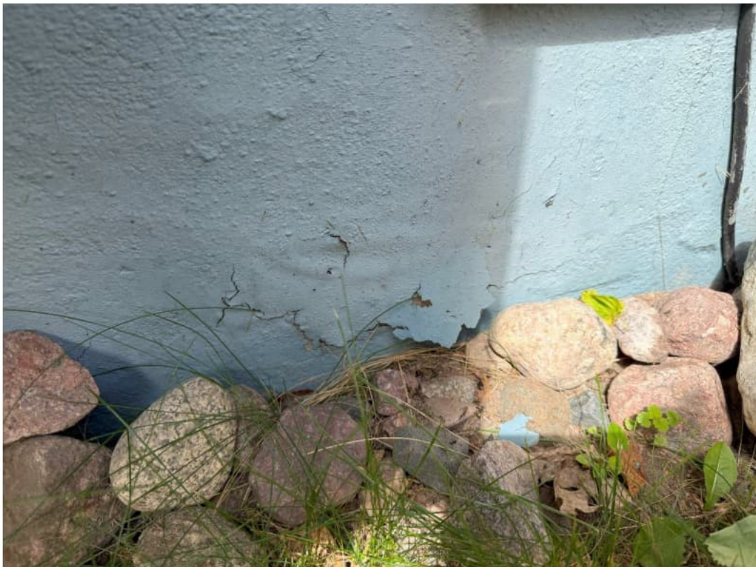
Kuva 16. Maalipinnoite irronnut ilmalämpöpumpun alapuolelta
