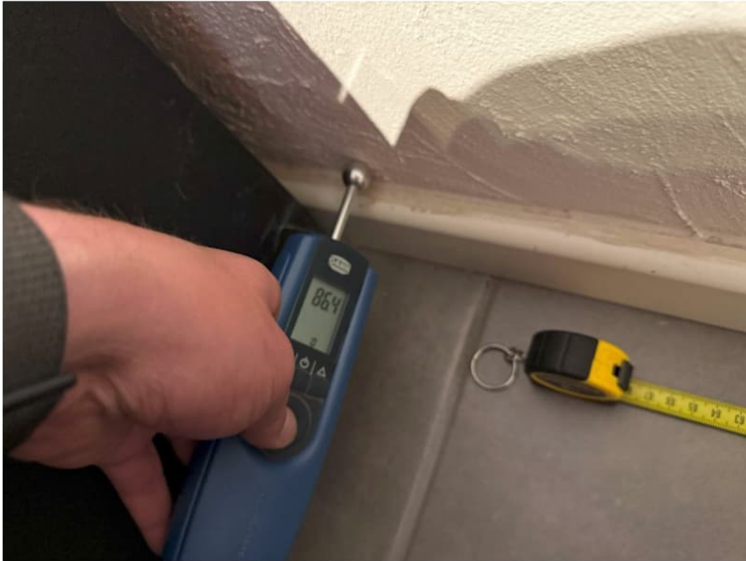
Kuva 7. Takapihan seinässä kosteus tippuu arvoon noin 80 cm päässä ulkonurkassa
