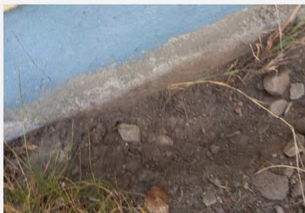
Liiketila ei patolevyä.
