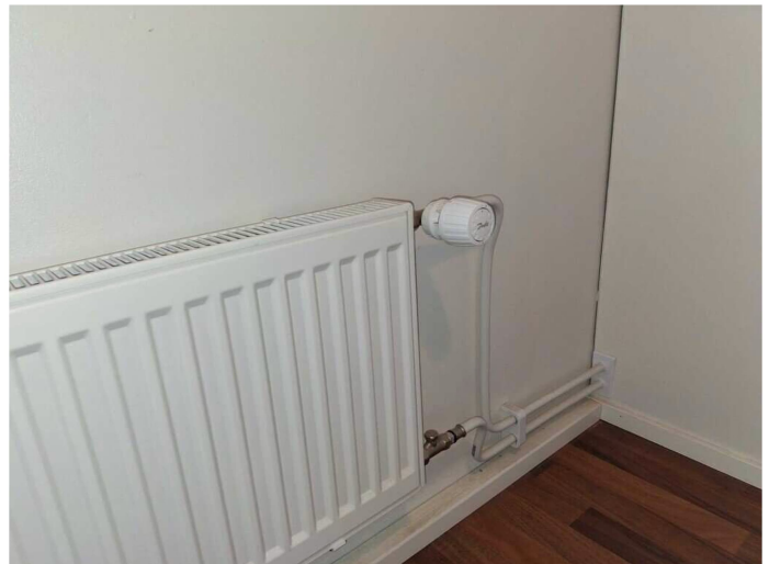
Kuva 7 Keittiön patteri, termostaatti ja putkisto on uusittu.
