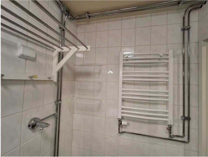
Kuva 8 Kylpyhuoneeseen on asennettu käyttövesi kiertoinen pyyhepatteri.
