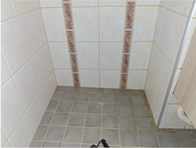
Kuva 20 Kylpyhuoneen lattia ja seinälaattojen saumat osittain tummuneita.
