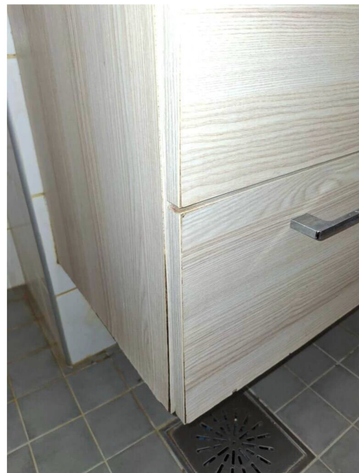
Kuva 19 Kylpyhuoneen altaan kalusterunko ovilevyineen on vaurioitunut suihkuvesistä.
