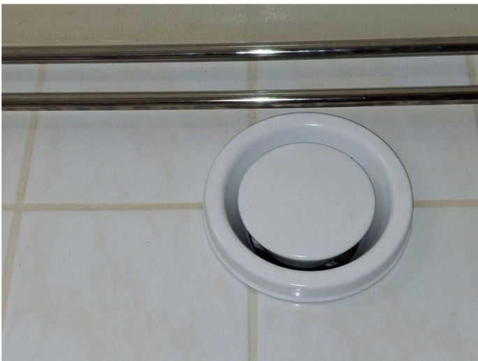
Kuva 10 Kylpyhuoneessa on poistoilma venttiili.
