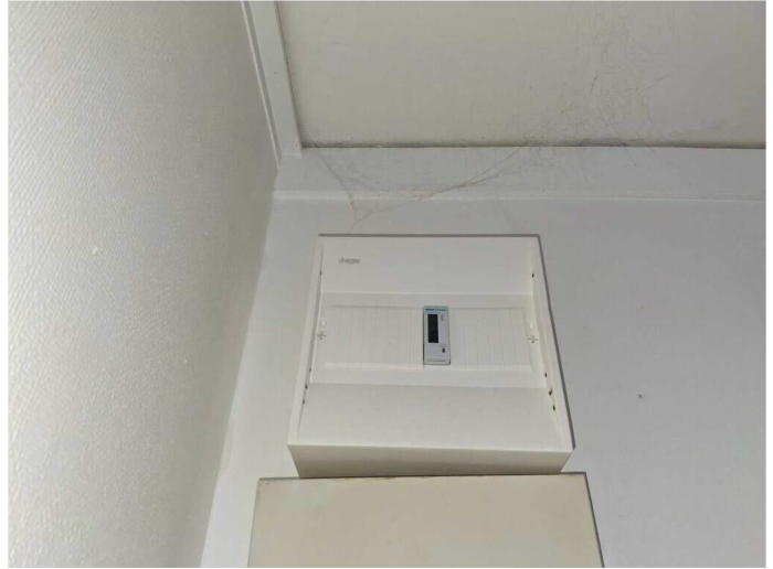
Kuva 9 Keittiön seinässä on vikavirta suoja.
