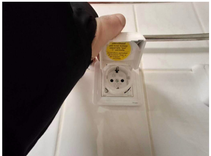
Kuva 11 Kylpyhuoneen vikavirta suojattu pistorasia.
