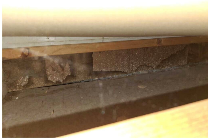
Kuva 13 Keittiön allaskaapin sokkelitilassa kylpyhuoneen vastaisen seinän alaosassa vanhoja vuotojälkiä.
