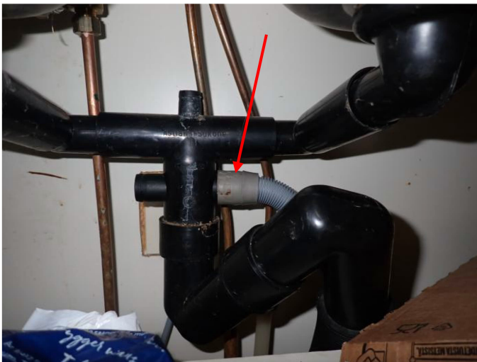
Astianpesukoneen poistoletkun kiinnitystä hajulukkoon ei ole varmistettu kiristysklemmarilla.
