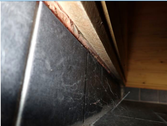
Saunan seinäpaneelien takana tuuletusrako.
