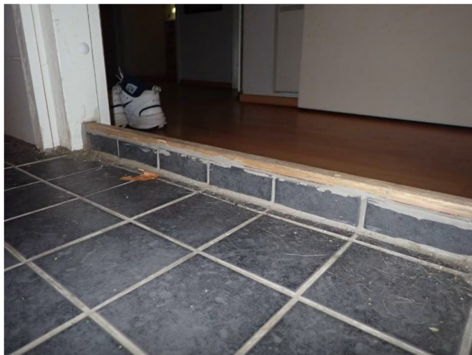
Pesuhuoneen oviaukossa tulvakynnys.
