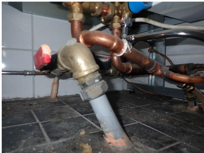
Näkymä lämminvesivaraajan alustilaan.
