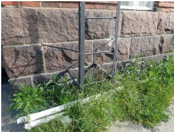
35. Tikkaiden kiipeilyuojapelti puuttuu
