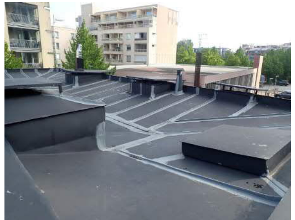
34. Vesikattoa on paikkakorjattu saumojen kohdilta.
