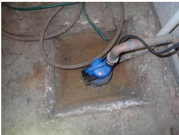
41. Teknisen tilan lattiassa oleva uppopumppu.
