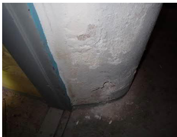
2. Kosteuden aiheuttama vaurio.
