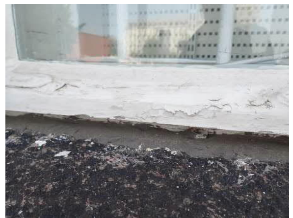
30. Maalipintaa hieman irtoaa alapuitteesta
