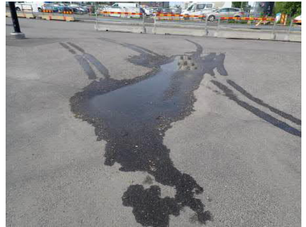
12. Pihapäällysteissä on havaittavissa paikoin painumaa.
