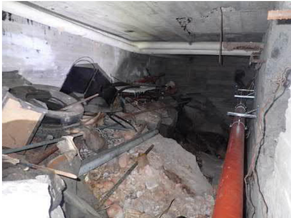
45. Alapohjatilassa on vanhaa rakennusjätettä.
