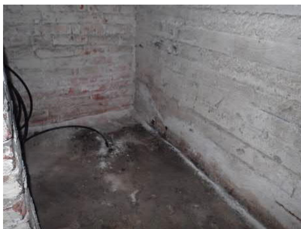
1. Kosteuden aiheuttama vaurio.
