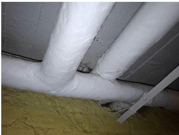
58. Mahdollisesti asbestia sisältäviä eristeitä.
