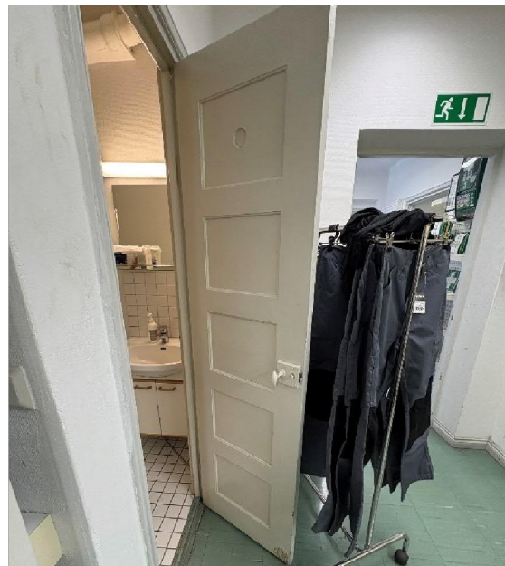
Kuva 15. Harmaa alkuperäisen oven maali sisältää sinkkiä yli vaarallisen jätteen raja-arvon.
