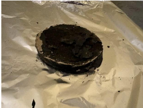
Kuva 6. Kellarin maanvastaisen seinän vedeneriste sisältää asbestia. Asbestikuitu on bitumin seassa. (Näyte 12).
