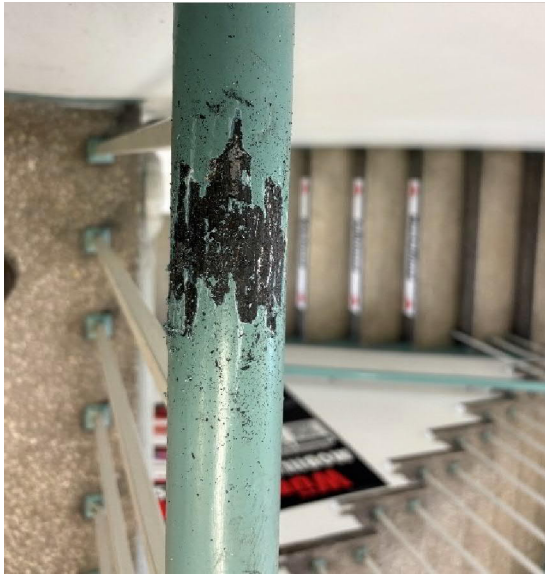
Kuva 16. Porraskäytävän käsijohteen maali sisältää lyijyä ja sinkkiä yli vaarallisen jätteen raja-arvon.
