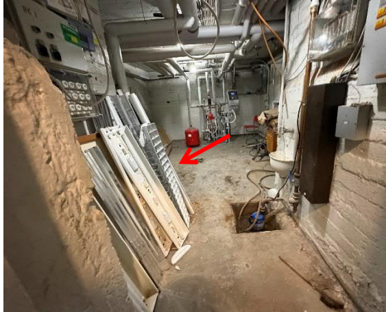
Kuva 25. Käytöstä poistettuja sähkölaitteita on varastoitu kellarikerrokseen. Ne ovat SER-jätettä.
