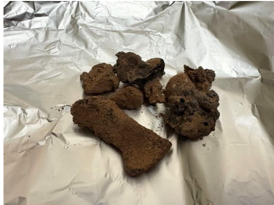
Kuva 7. Välipohjan koksikuona sisältää asbestia (Näyte 16).
