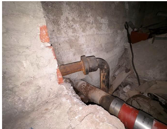
Kuva 19. Viemärin liittosmuhveja havaittiin myös matalassa kellariosassa.
