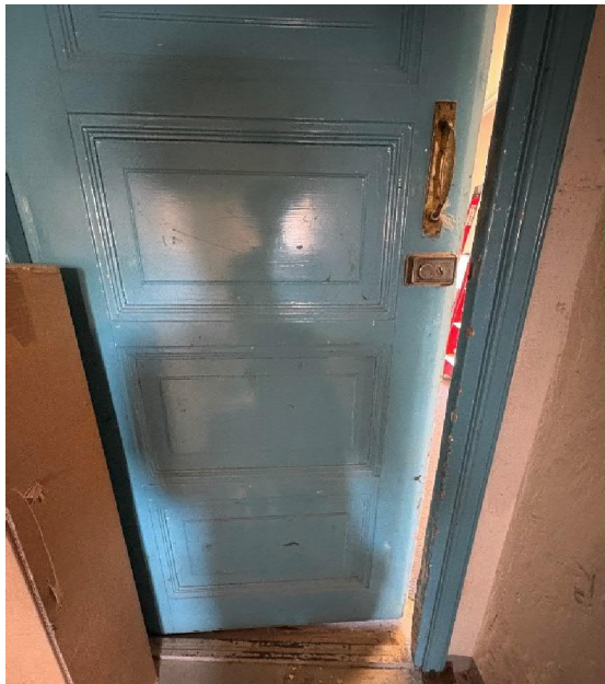
Kuva 14. Kellarin johtava sininen puuoven maali sisältää sinkkiä yli vaarallisen jätteen raja-arvon.
