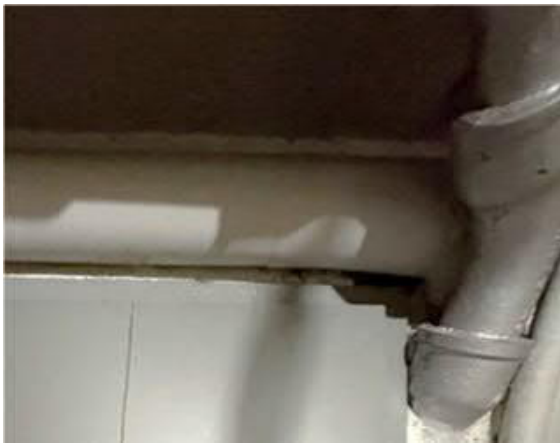
Kuva 18. Alkuperäisissä pystyviemärin liittosmuhveissa on raskasmetalleja.
