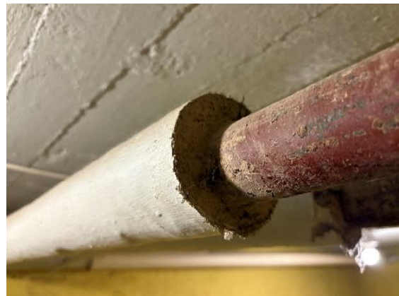
Kuva 9. Osa vanhoista putkieristeistä on purettu, mutta putkien ympärille on jäänyt kuitumaista purkujätettä, joka voi olla asbestipitoista. Asbestia voi löytyä myös uusitun mineraalivillaeristeen alta.
