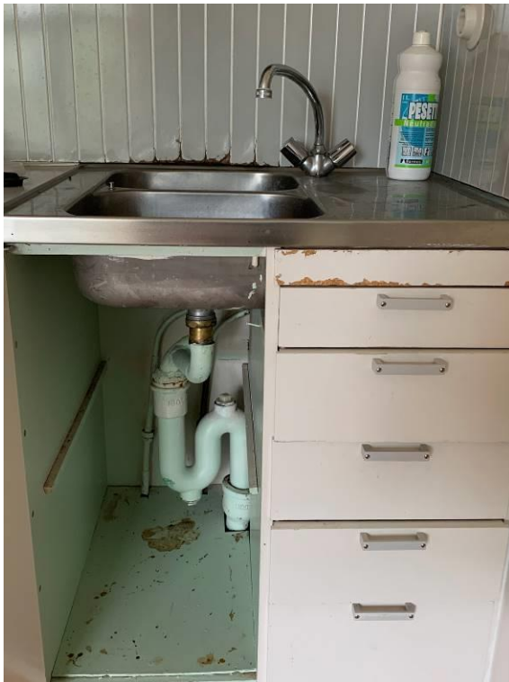
Kuva 4. Keittiöaltaan vanha valurautainen kytkeväviemäri
