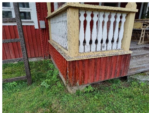
Kuistin rakenteissa alkavaa lahovauriota
