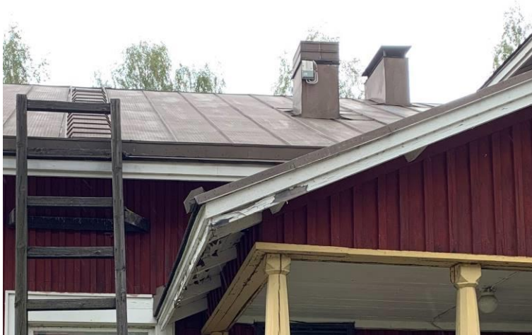
Kuva 6. Vesikatolla oleva huippuimuri
