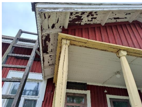
Räystäään aluslaudoitukset huonokuntoiset
