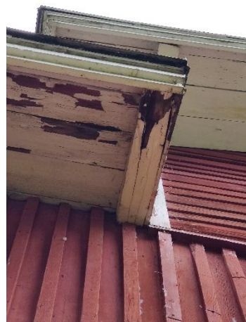
Aluslaudoituksissa ja poikasissa lahovaurioita
