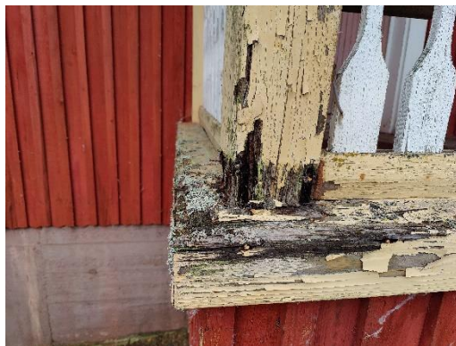
Kuistin rakenteissa lahovaurioita
