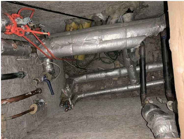
Kuva 1. Koskelan lämpö- ja vesijohtoverkoston jakokaivo. Osa putkista on otettu irti verkostosta ja osasta putkia puuttuu eristeet.
