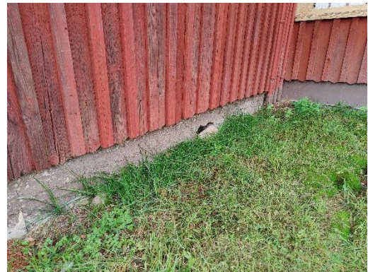
Sokkelikorkeus paikoin matala, maanpinnan kallistukset paikoin puutteelliset
