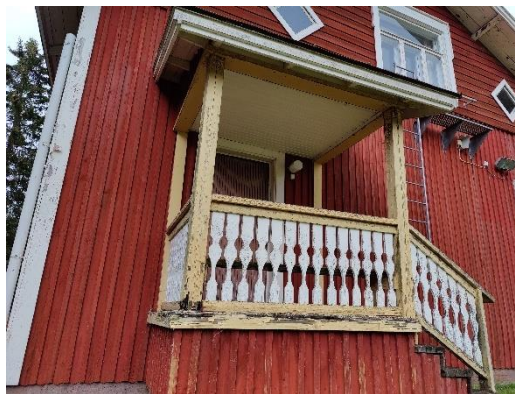
Kuistin rakenteissa lahovaurioita
