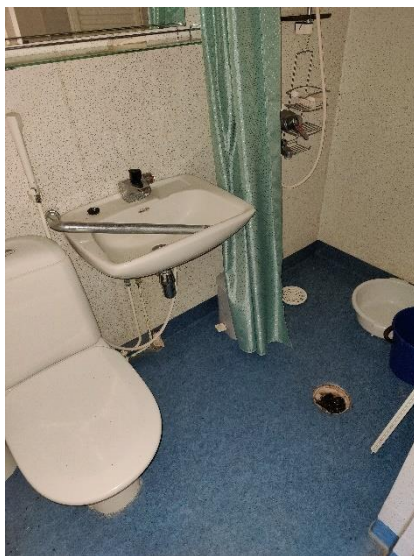
Yläkerran pesuhuone, 2kpl
