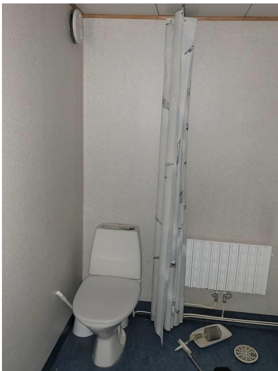
Kuva 4. Kytchentävesijohdot kulkevat pinnassa ja käyttöveteen kytketty patteri.
