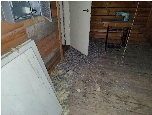
Vieriullakot täynnä lintujen jätöksiä sekä yksi kuollut lintu.
