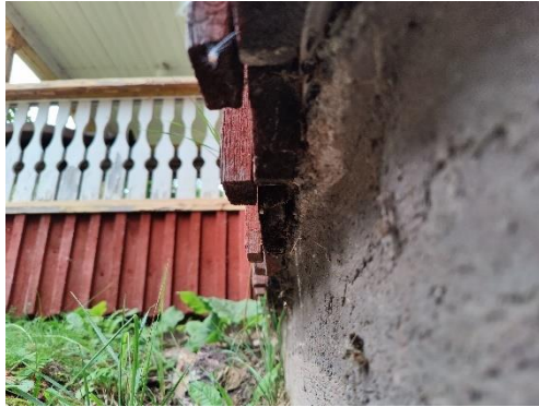
Verhouksen tausta ei ole tuulettuva
