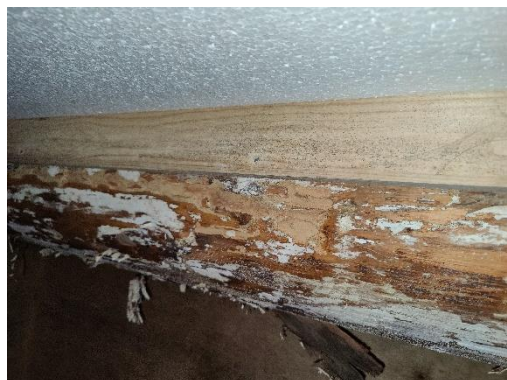
Alapohjapalkeissa ja seinävanereissa alkavia homeitiöitä.
