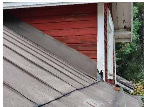
Rintataitepellistä puuttuu tiivistysmassaus
