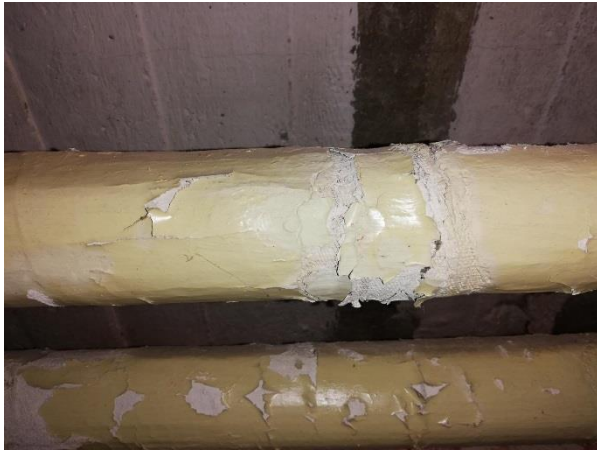
Kuva 6: Kellaritiloissa havaittiin putkieristysiä, jotka todennäköisesti sisältävät asbestia.
