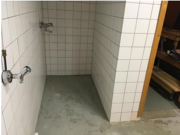
Kuva 2: Pesuhuoneen lattiapinnoilla esiintyi kosteuspoikkeamia.
