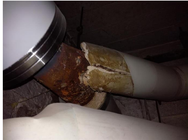
Kuva 7: Putkieristykset olivat paikoin huonokuntoisia.
