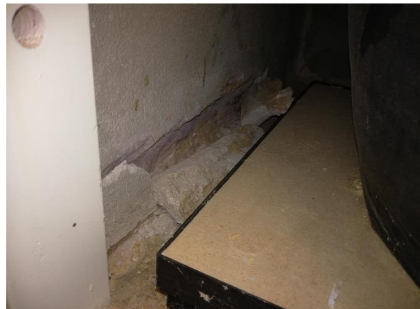
Kuva 5: Komeroiden osalla lattian ja seinän liitoskohdat ovat epätiivit.
