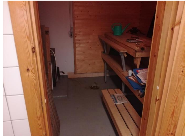
Kuva 20: Saunan lattiamaalit eivät sisällä lyijyä.
