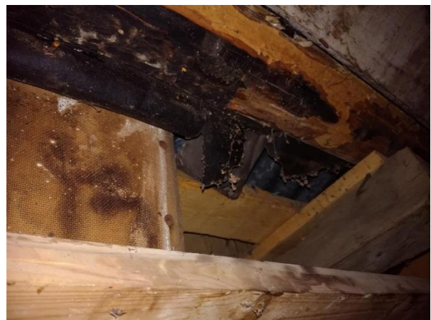
Kuva 2: Alkuperäisenä vesikaton aluskatteena käytetty bitumihuopa sisältää asbestia.
