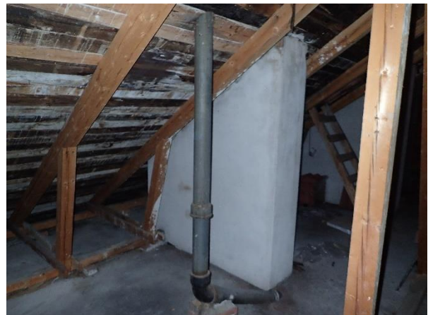
Kuva 22: Ullakolla viemärin tuuletusputki valu-rautaa.
