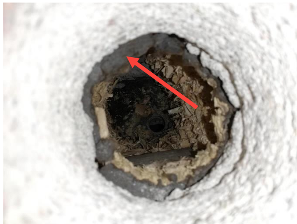
Kuva 16: 1. kerroksessa alapohjarakenteessa PAH-yhdisteitä sisältävä tervapaperi.
