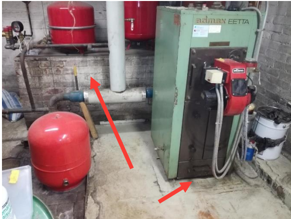
Kuva 14: Asbestia sisältävää paloeristettä on mahdollisesti käytetty myös palohormikanavien vaakavetojen rakenteissa sekä uusittujen lämmityslaitteiden kohdalla alapohjassa.
