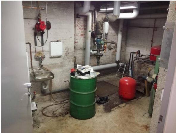
Kuva 3: Pannuhuoneen katto- ja seinäpinnoitteesta on todettu asbestia.
