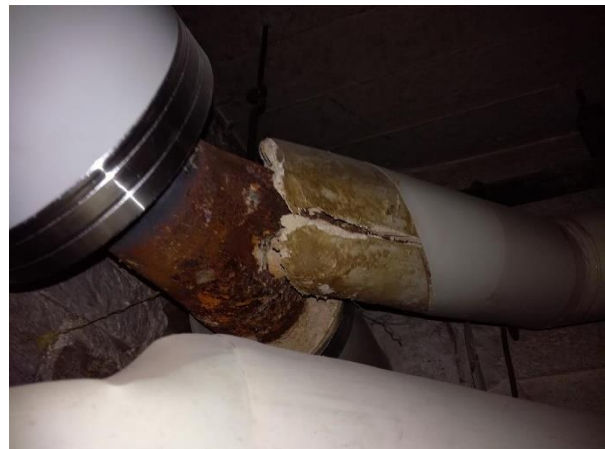
Kuva 6: Pannuhuoneessa asbestia sisältävä eriste pinnoittamatta.
