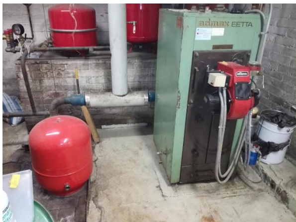
Kuva 23: Pannuhuoneen lattiabetoni on suositeltavaa käsitellä öljyhiilivetyjä sisältävänä materiaalina.
