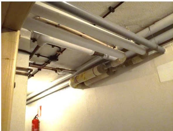
Kuva 5: Kellarikerroksessa osassa pinta-asennetuissa putkistoissa eristeenä asbestia sisältävä materiaali.
