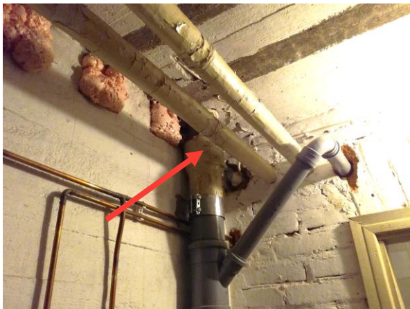
Kuva 21: Välipohjan läpi kellariin tuleva viemä-rönti valurautaa
