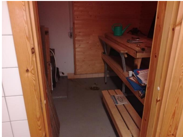
Kuva 18: Saunan lattiamaalit eivät sisällä PCB-yhdisteitä.
