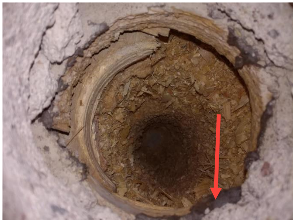
Kuva 15: Yläpohjarakenteessa palopermannon ja laudoituksen rajapinnassa PAH-yhdisteitä sisältävä tervapaperi.
