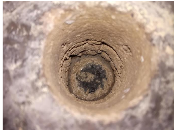
Kuva 13: Lattian tiililadonnan alla todennäköisesti asbestia sisältävä eristekerros.
