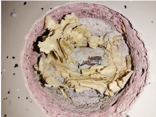
Kuva 7: Asbestieristeinen lämmitysputkisto välipohjarakenteessa.
