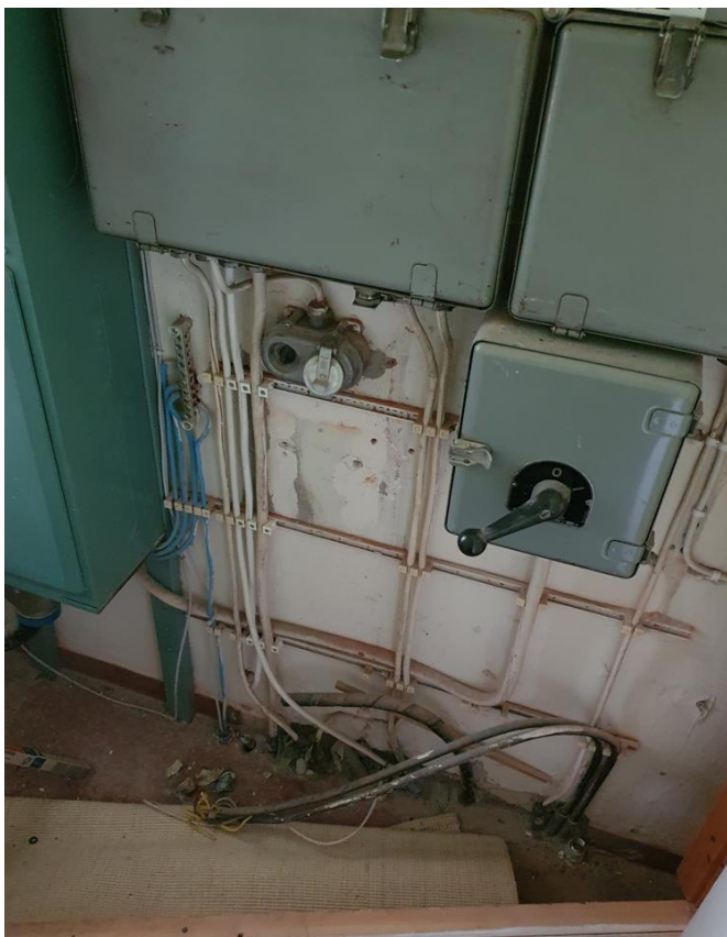
Kuva 6: Pääkeskustilassa vanhoja purkamattomia asennuksia.
