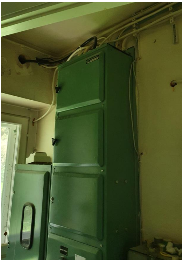
Kuva 9 Vanha pääkeskus. Elinkaarensa lopussa.
