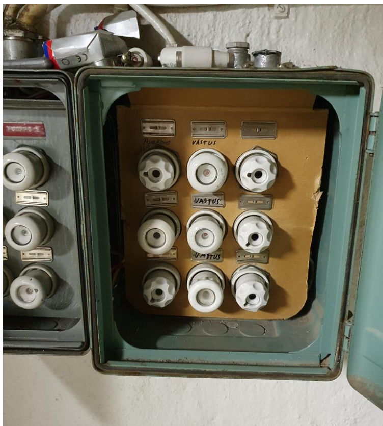
Kuva 1: Lämmönjakohuoneen vanha keskus. Elinkaarensa lopussa.
