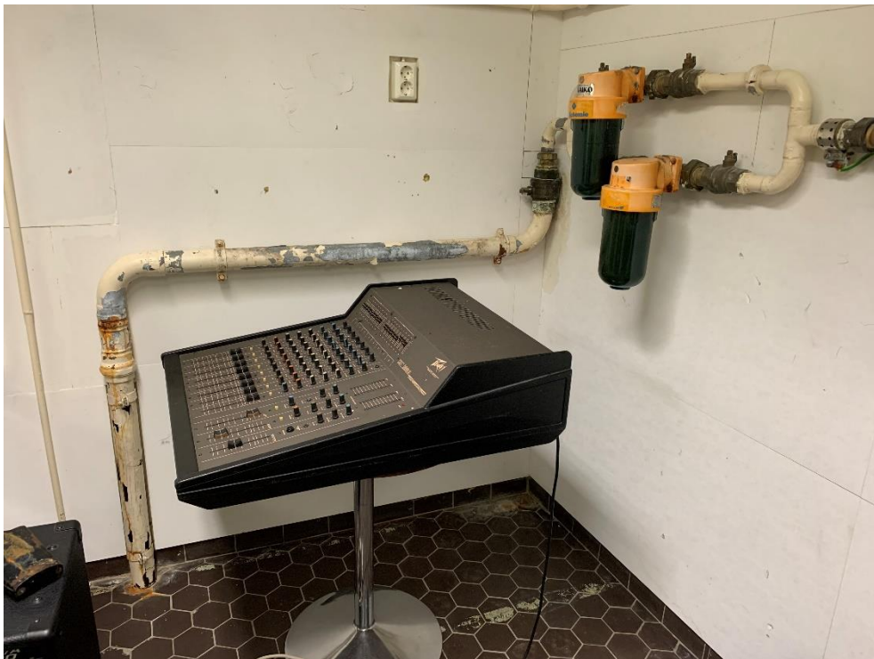
Kuva 6. Päävesimittari sijaitsee kellarikerroksen kerhotilassa. Runkovesilinja on teräsputkea ja se on varustettu lianerottimilla. Putkessa on näkyvillä vuodon jälkiä (KL 1).
