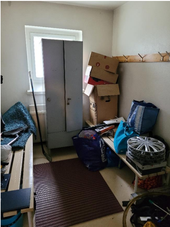
Kuva 26: Pukuhuone toimii varastona. Pinnat kuluneet.
