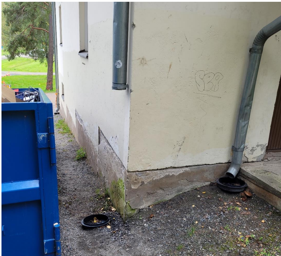
Kuva 5: Perusmuurin pinta rapautunut. Syöksytorven alaosa puuttuu.
