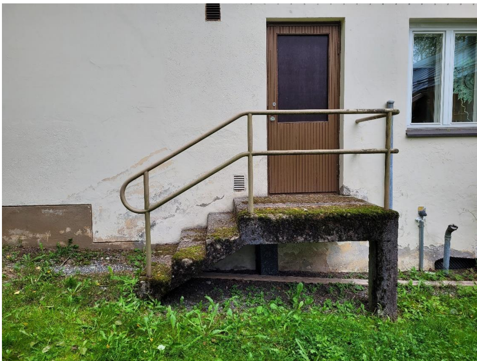
Kuva 8: Takapihan betoniportaavat huonossa kunnossa.
