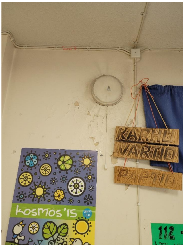
Kuva 19: Kerhuhuoneen ulkoseinässä maalipinta hilseilee
