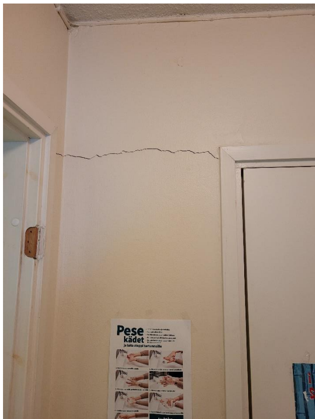
Kuva 27: Väliseinissä paikoitellen halkeamia
