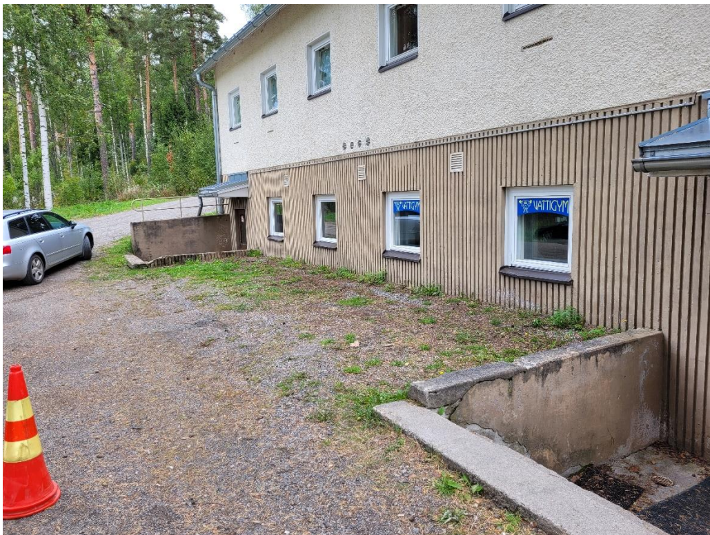
Kuva 1: Sora-alueella kasvillisuutta. Kaadot vähäisiä. Betoniset muurita ja portaat ovat rapautuneita.
