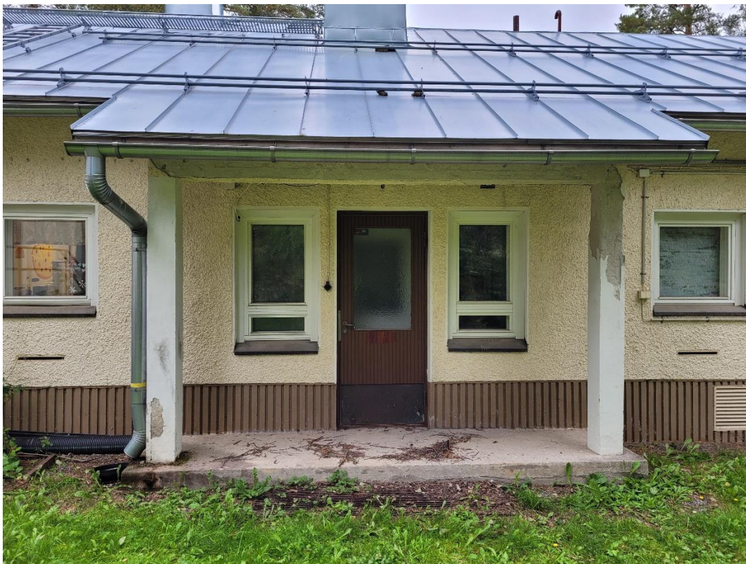
Kuva 9: Takapihan terassin betonirakenteiden kunto huono.
