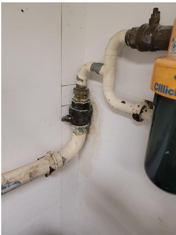
Kuva 30: Kuntoilu- ja kerhotilan seinä märkä putkiliitoksen kohdalta
