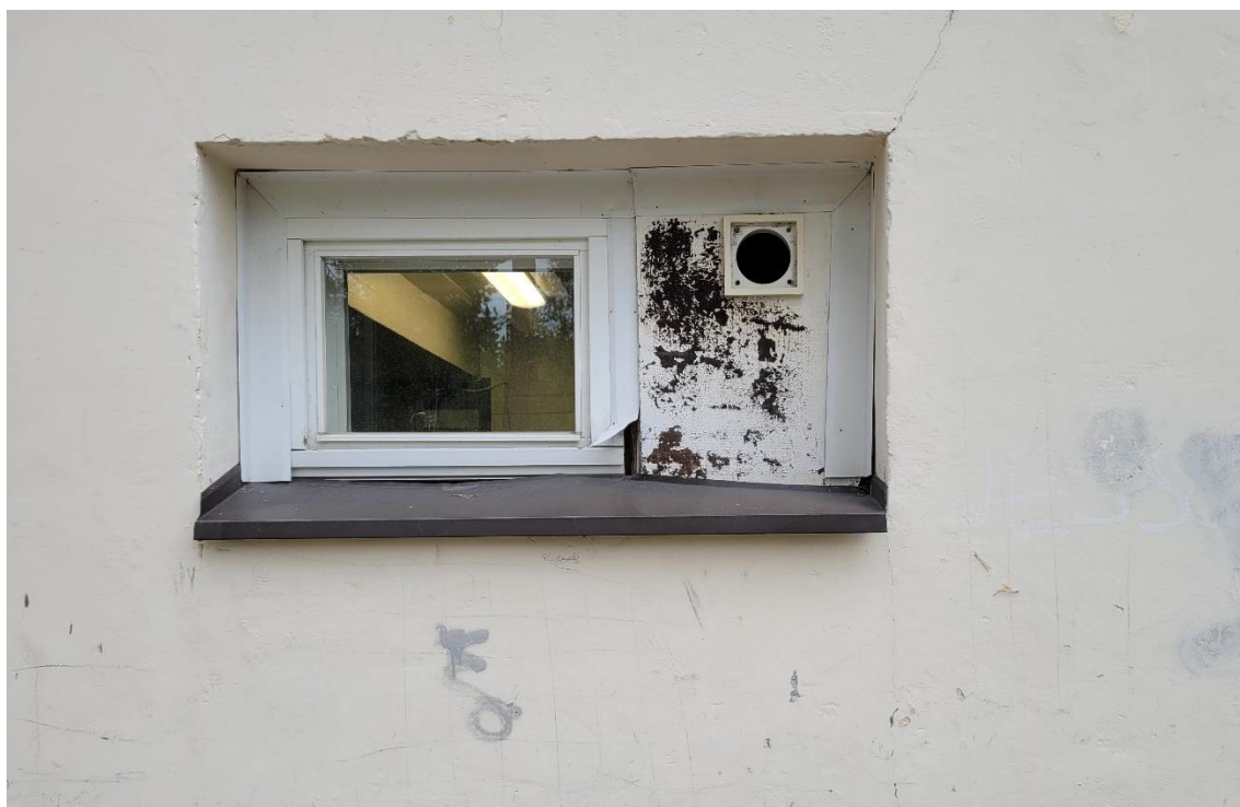
Kuva 4: Ikkunan pellit vääntyneet
