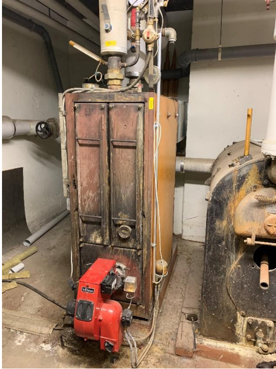
Kuva 1. Rakennuksen lämmönjakohuone sijaitsee pohjakerroksessa ja siellä on vm. 1982 oleva öljykattilalla. Öljypoltin on Oilon Oy:n valmistama vuosimallia 2006.
