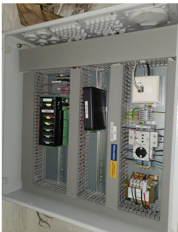
Kuva 2: Uusittu rakennusautomaation alakeskus
