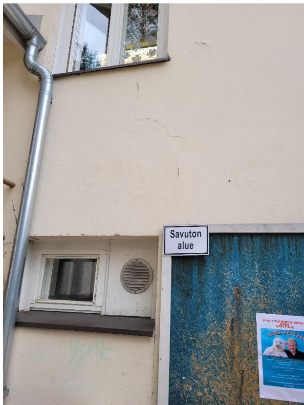
Kuva 3: Seinässä paikoitellen halkeamia ja pinta irttoilee
