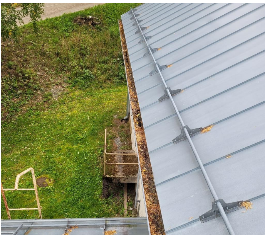
Kuva 10: Rästaskouruissa havunneulasia ja lehtiä
