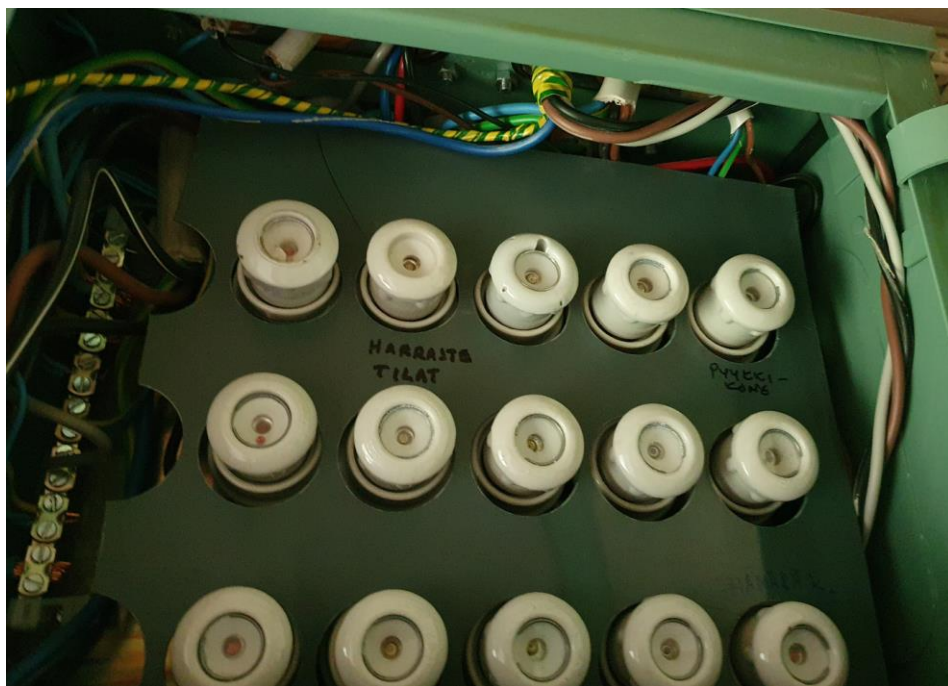
Kuva 4: Pääkeskuksen lähtöjä. Kosketussuojaus on puutteellinen.
