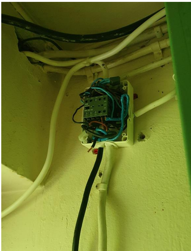
Kuva 5: Pääkeskustilan sähkökoje, kansi puuttuu. Jännitteelliset osat esillä.
