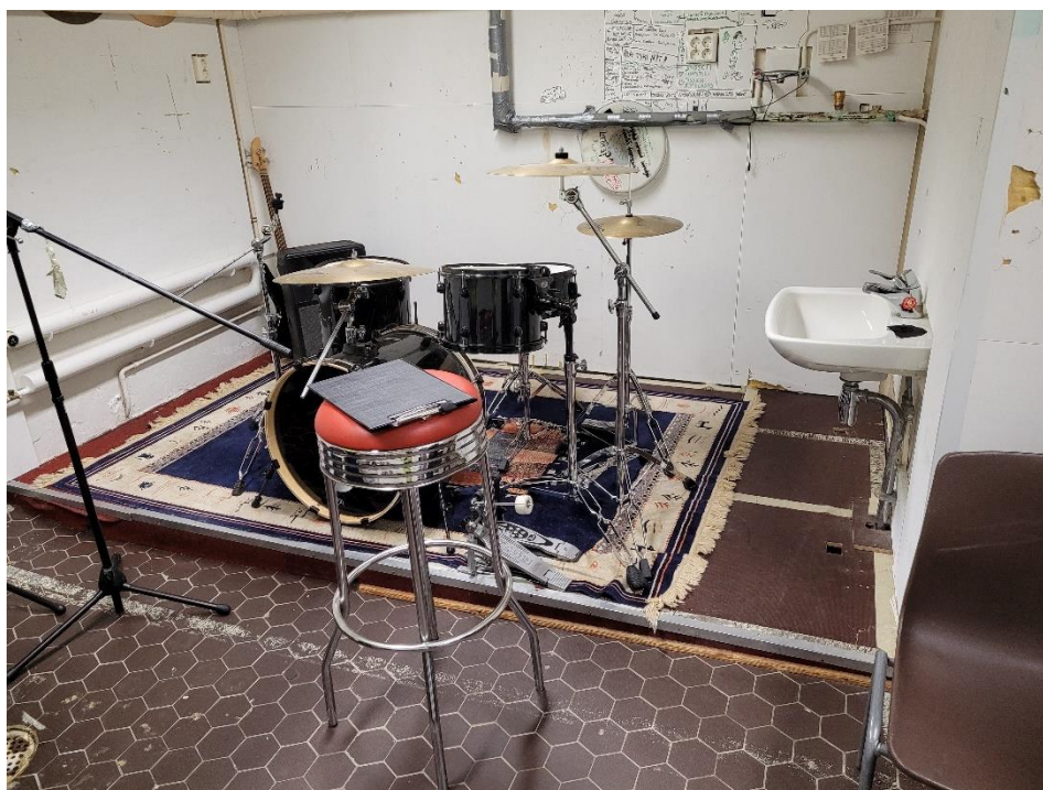
Kuva 28: Kuntoilu- ja kerhotila. Pinnat ovat kuluneet.
