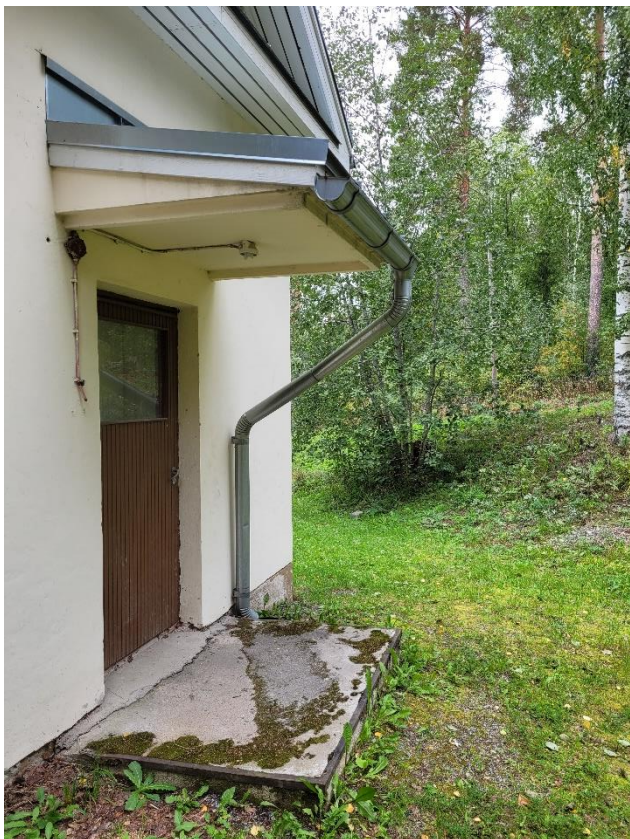
Kuva 7: Takapihan ovi. Laatta rapautunut ja sammaloitunut.
