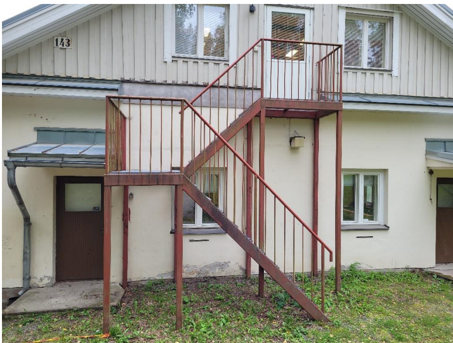
Kuva 6: Teräsportaan pinta huonossa kunnossa.
