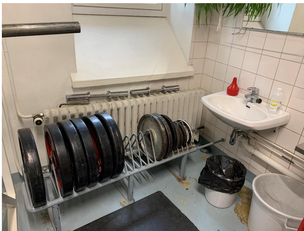
Kuva 4. Kuntosalissa on alkuperäiset ripaputkipatterit
