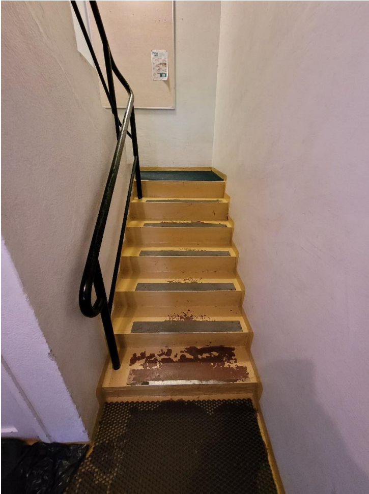
Kuva 17: Portaiden pinta kulunut
