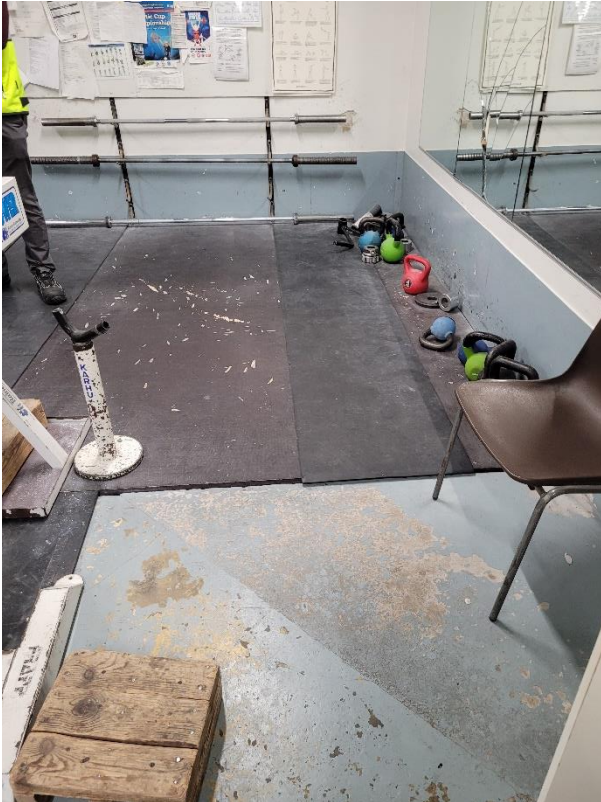
Kuva 15: Kellarin maalatut lattiapinnat huonossa kunnossa
