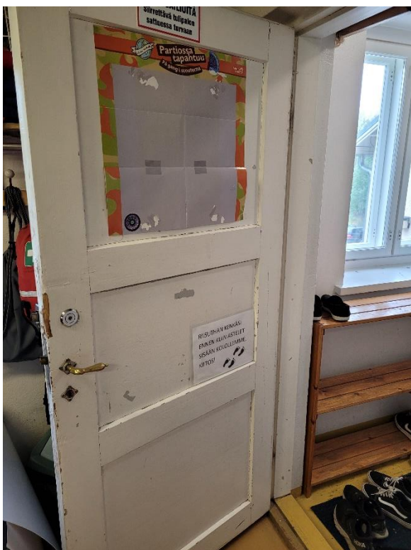
Kuva 20: Osa väliovista huonossa kunnossa
