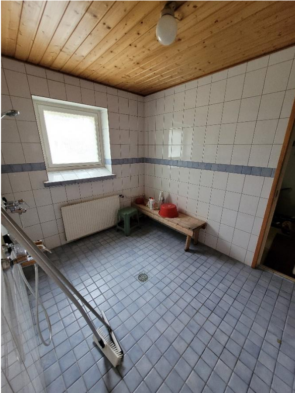
Kuva 23: Pesuhuone. Vedeneriste teknisen käyttöön päässä
