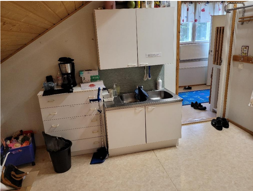
Kuva 18:2. kerroksen lattiamatto paikoitellen irti alustasta. Seinissä jälkiä.
