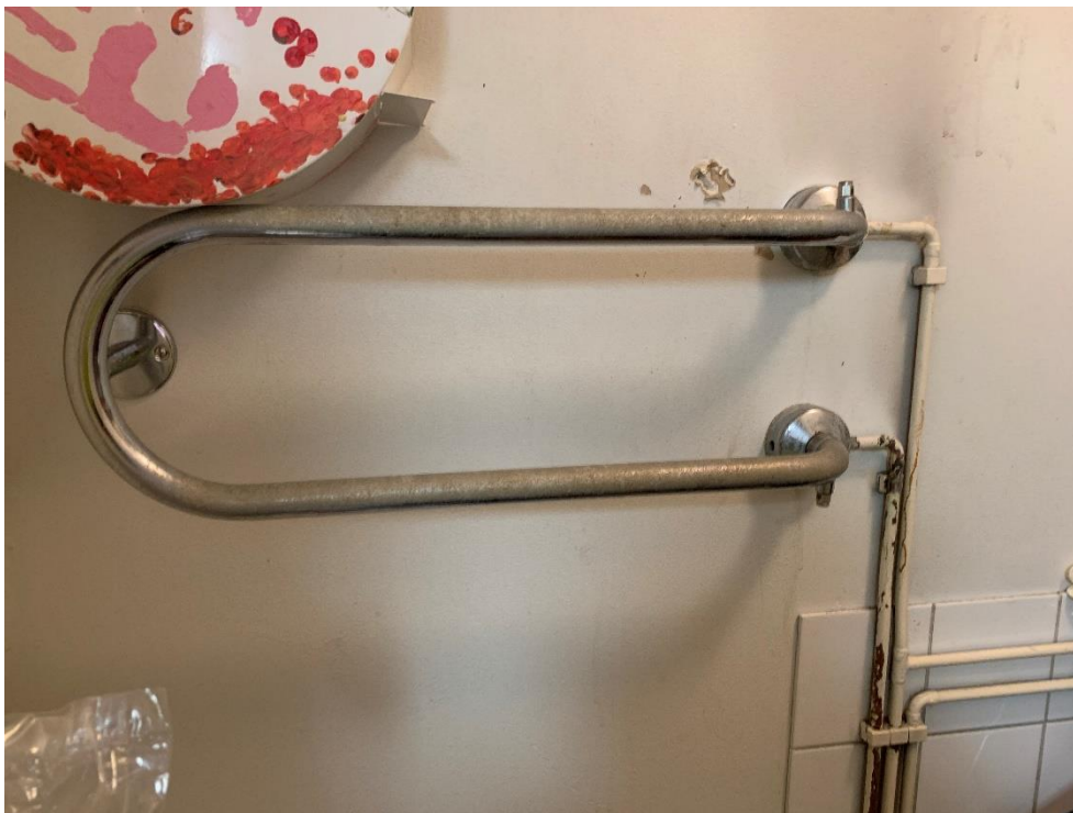
Kuva 7. Lämpimän käyttöveden kiertoverkoston on kytketty siivouskomerossa kuivauspatteri.
