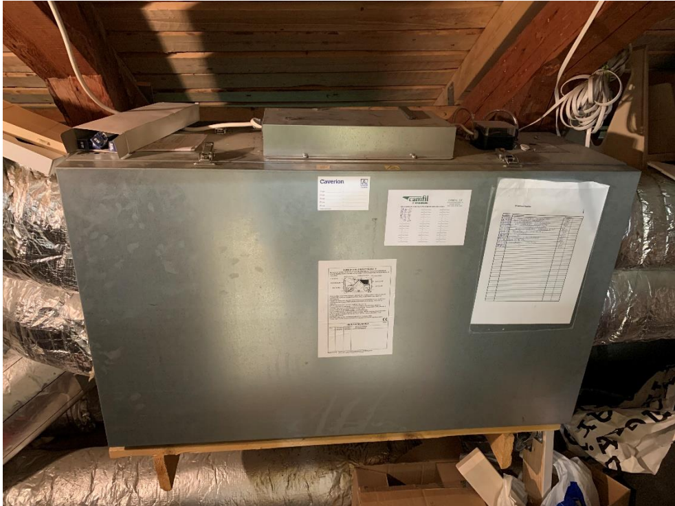
Kuva 9. 1- ja 2-kerroksen kerho- ja harrastetiloissa on koneellinen tulo- ja poistoilmavaihto, jotka on varustettu lämmön talteenotolla. Ilmanvaihtokojeet on sijoitettu 2.kerroksen kylmälle ullakolle "IV-konehuoneeseen".
