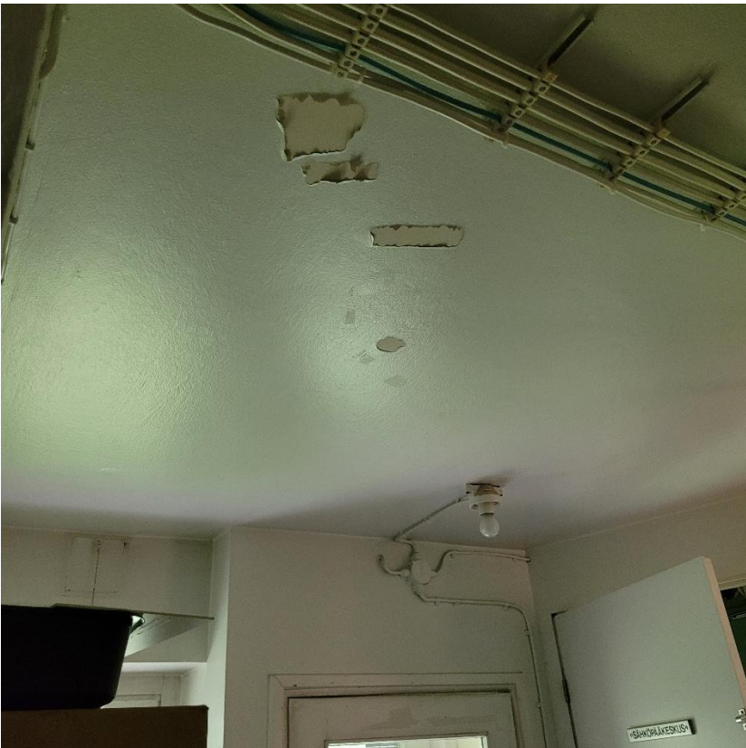
Kuva 24: Katon maalipinta irtoilee
