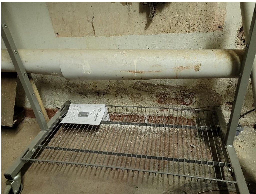
Kuva 14: Kellarin seinän alaosa rapautunut
