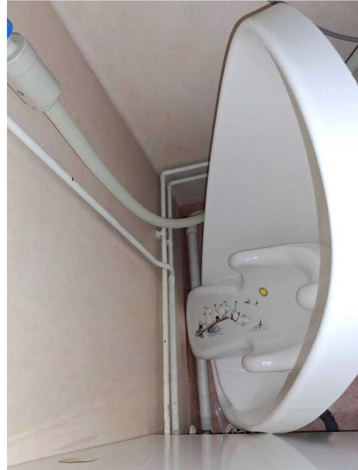
Kuva 11 Käyttövesiputkisto on asennettu kylpyhuoneessa pintaan kupariputkella.
