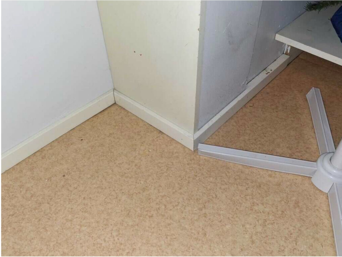
Kuva 14 Vaatehuoneessa kotelon ympärillä normaali pintakosteus.
