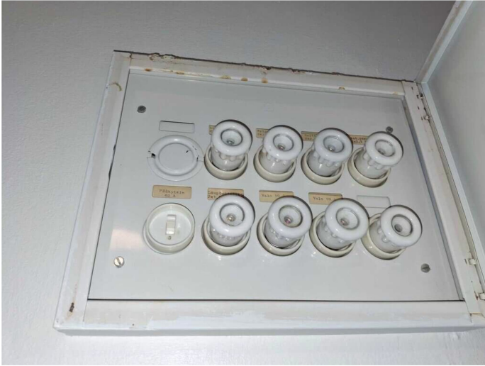
Kuva 6 Huoneiston sähköjärjestelmä on alkuperäinen. Sulaketaulussa on merkinnät.
