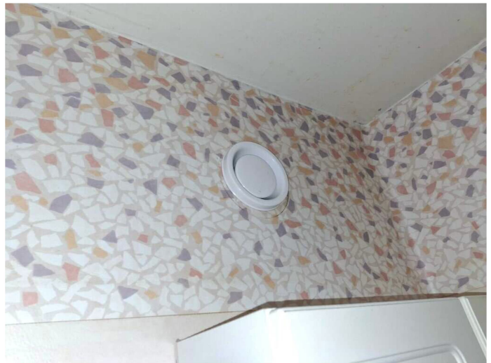
Kuva 9 Kylpyhuoneessa on koneellinen poistoilma venttiili.
