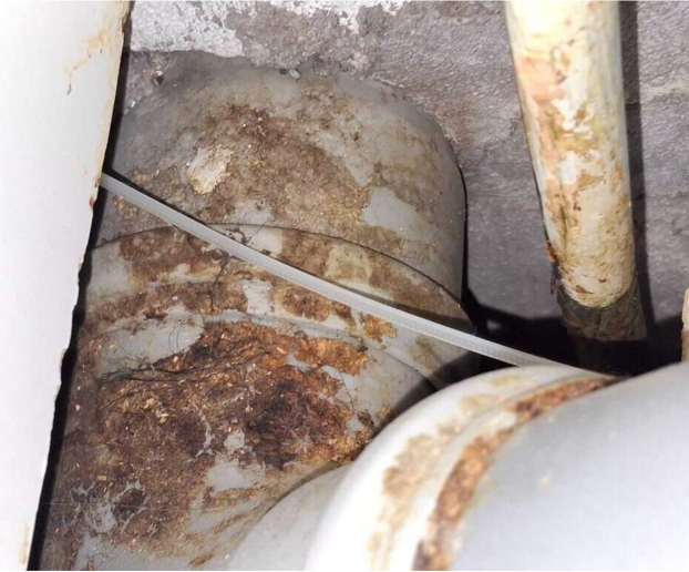
Kuva 18 Allaskaapin sokkelitilassa vanhoja vuotojälkiä.
