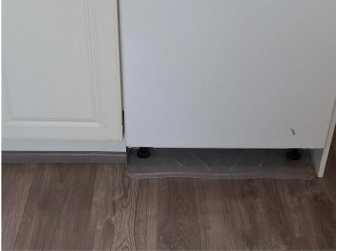
Kuva 15 Astiapesukoneen alla on tulva-allas.
