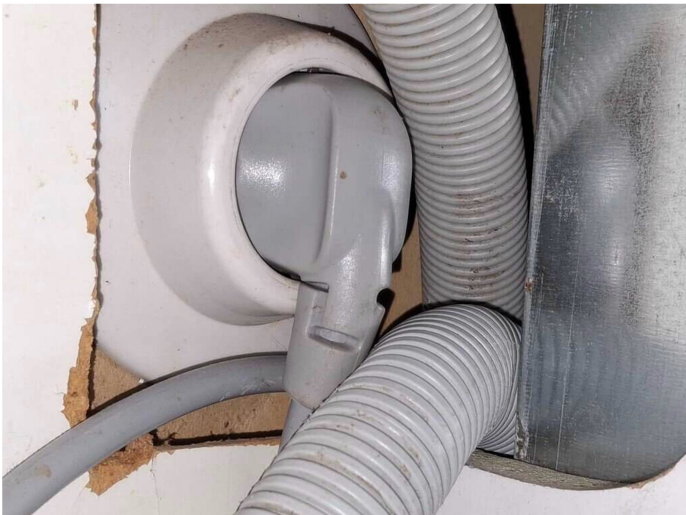
Kuva 16 Astiapesukoneen tulo- ja poistovesiletkut ovat puristuksissa koneen ja rungon välissä.
