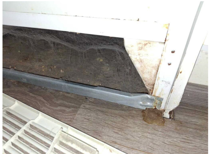
Kuva 21 Jääkaapin etureunassa lauhdevesi valumajälkiä. Sivulevyjen alaosissa vaurioita.
