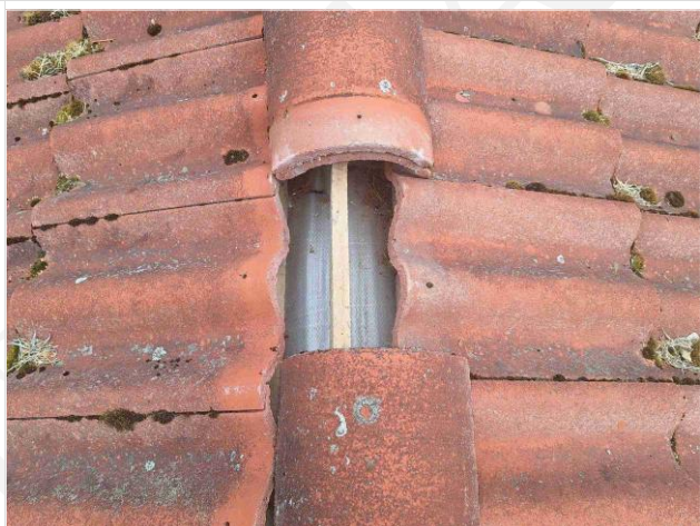
Kuva 94 Harjatiiliä ei ollut kiinnitetty
