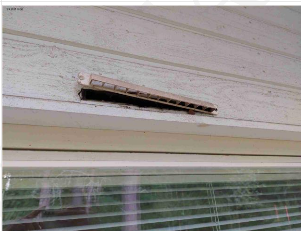
Kuva 173 Korvausilmaventtiilien kiinnitykset irronneet
