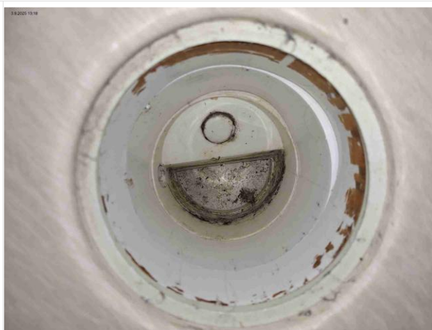
Kuva 155 Lattiakaivo, rivitalo. Korokerenkaassa vääntymiä
