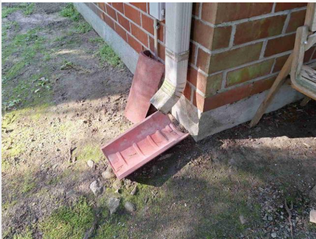
Kuva 26 Sadevedet ohjautuivat lähelle perustuksia
