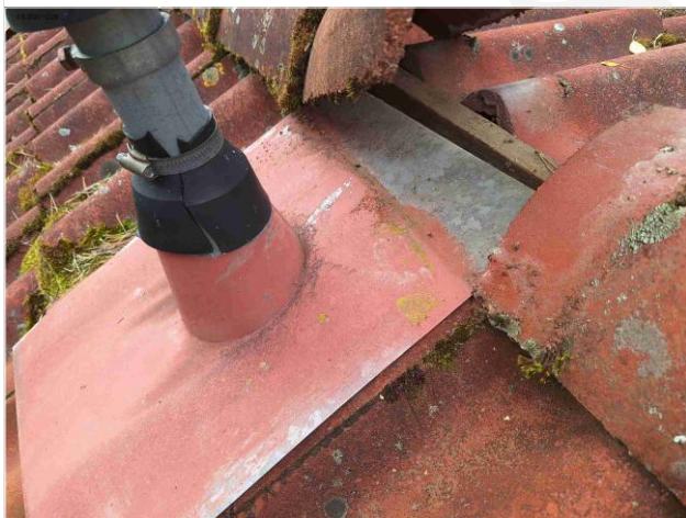
Kuva 101 Läpivientikappaleiden kiinnitys puutteellinen, molemmat talot
