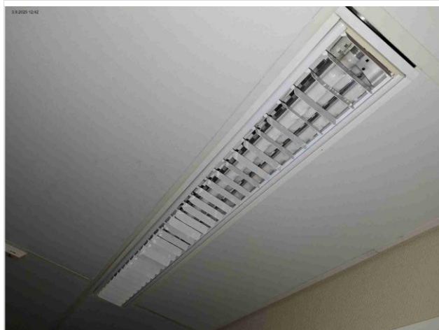
Kuva 200 Yleisissä tiloissa loisteputkivalaisimet
