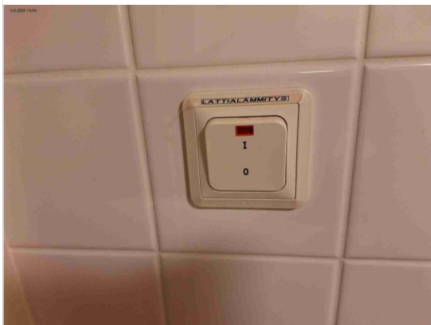
Kuva 203 Laajennusosan pesuhuoneissa sähköinen lattialämmitys
