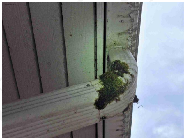
Kuva 112 Rästaskouruliitokset eivät olleet tiiviitä
