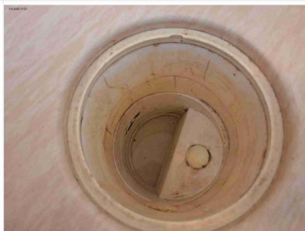
Kuva 153 Huoneiston lattiakaivo, korokerenkaassa halkeamia
