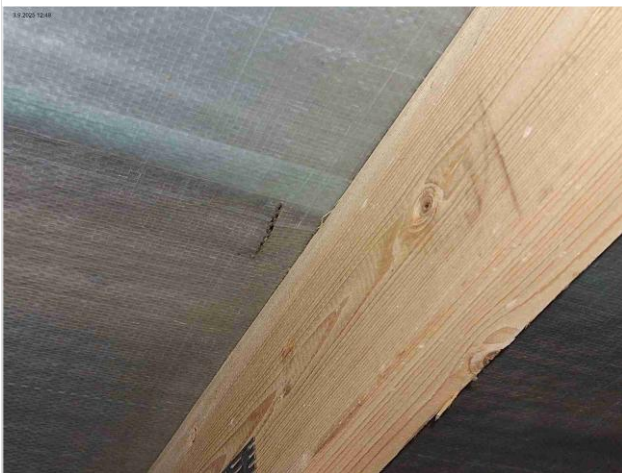
Kuva 63 Reikä aluskatteessa, rivitalo
