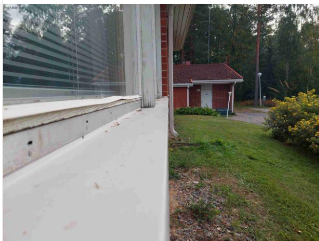
Kuva 72 Ikkunapeltien kallistus väärän suuntainen
