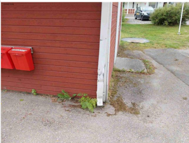
Kuva 15 Sadevedet nurkalle valuvat nurkalle ja kulkuväylälle
