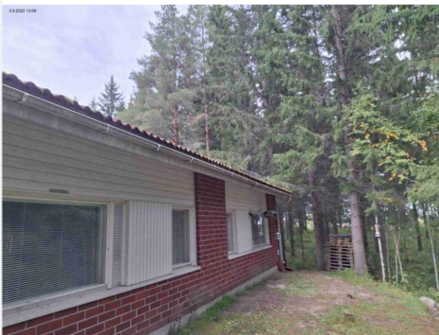
Kuva 109 Rästaskourujen kiinnitykset olivat puutteelliset rivitalo
