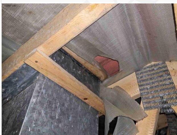
Kuva 48 Puutteellinen läpiviennin tiivistys, rivitalo
