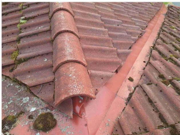
Kuva 96 Tiilikate irtoillut paikoin
