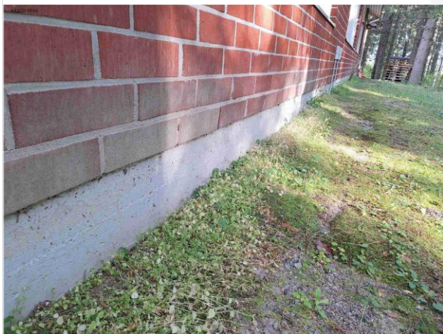
Kuva 32 Humusmaa kiinni perustuksissa, rivitalo
