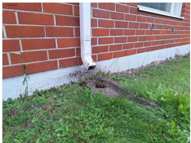
Kuva 23 Sadevedet ohjautuivat avokouruihin liian lähelle perustuksia
