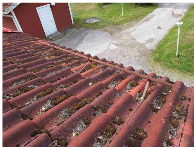
Kuva 116 Lumiesteiden kiinnitykset olivat puutteelliset, rivitalo
