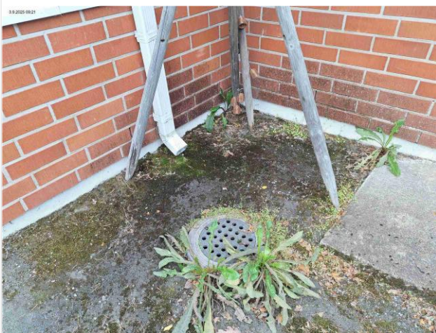
Kuva 22 Hulevedet ohjautuu salaojajärjestelmään palvelutalon nurkalla
