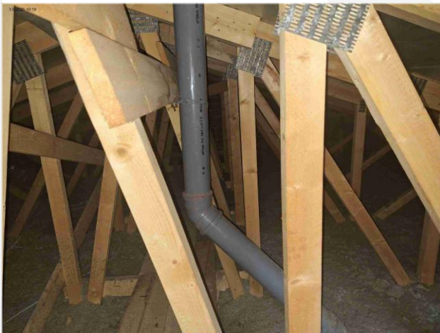
Kuva 67 Viemärin tuuletusputkea ei ollut lämpöeristetty
