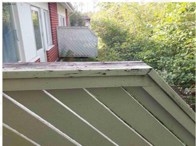
Kuva 16 Väliaidoissa huoltokorjauksen tarvetta
