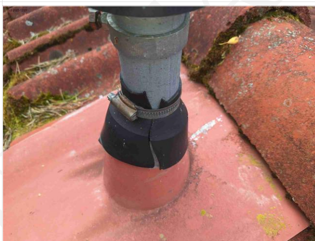
Kuva 100 Antenniputken juuritiivistys puutteellinen
