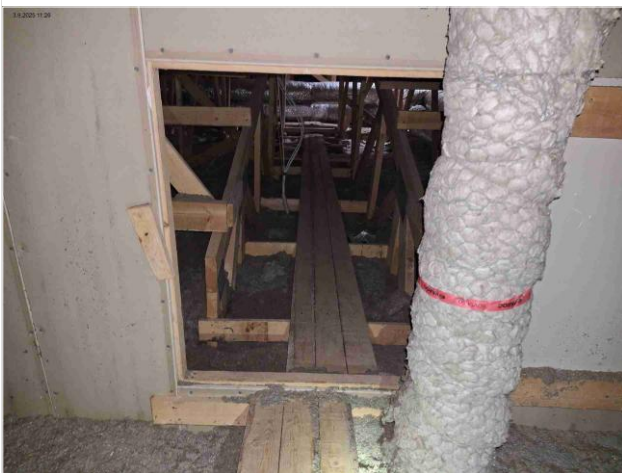
Kuva 65 Palokatkoseinässä oleva kulkuluukku ei ollut tiivis
