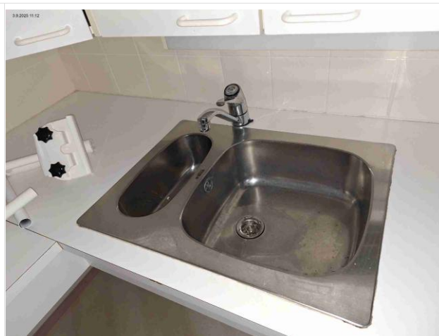
Kuva 149 Keittiön hana irtonainen
