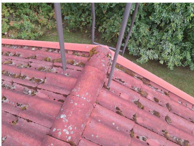
Kuva 115 Seinätikkaita ei ollut kiinnitetty yläpäästään
