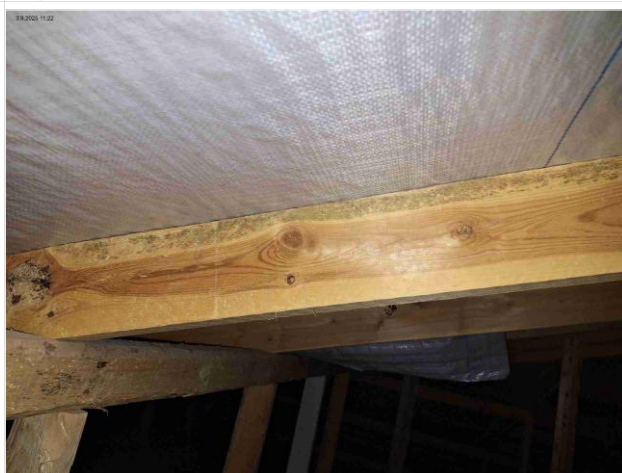
Kuva 50 Kosteusjälkiä kantavassa rakenteessa
