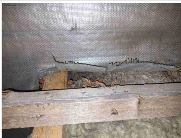
Kuva 44 Puutteellinen läpiviennin tiivistys
