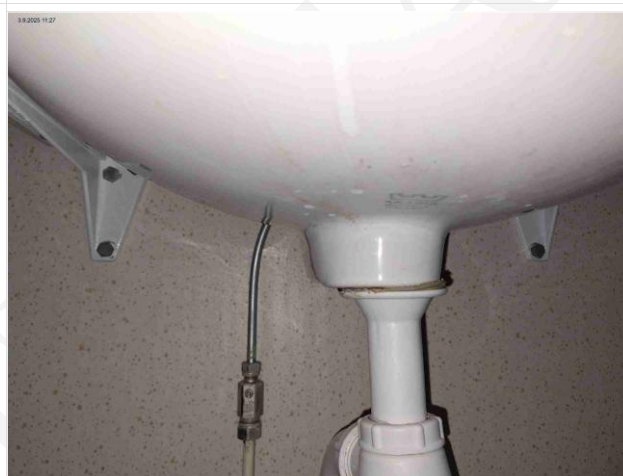
Kuva 151 Alttaiden viemäriiitoksissa epätiiviyyksiä
