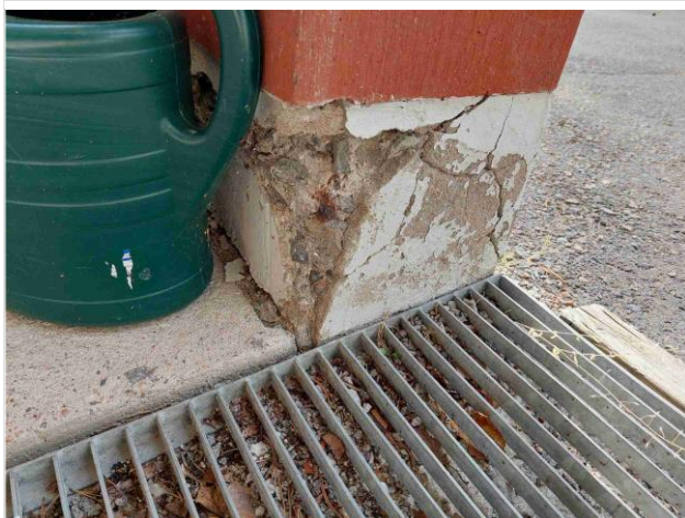
Kuva 78 Muurin perustus rapautunut
