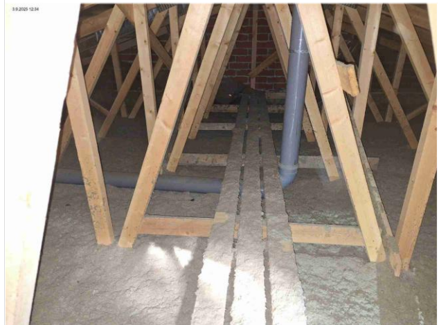
Kuva 68 Viemärin tuuletusputkea ei ollut lämpöeristetty, rivitalo
