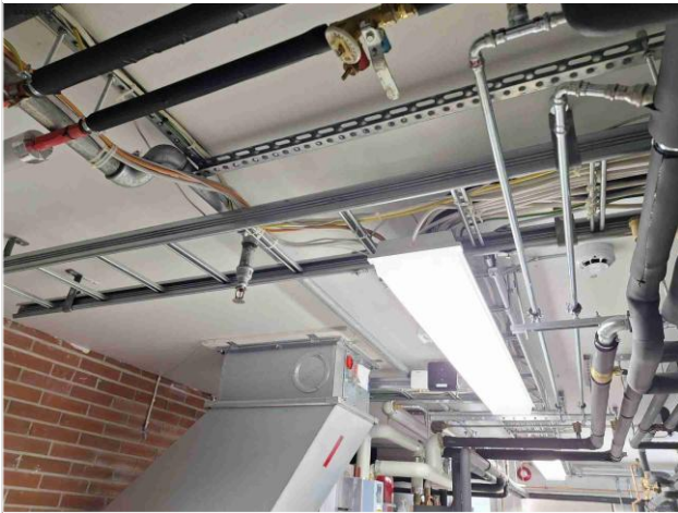
Kuva 183 Kaapelihyllyt teknisessä tilassa
