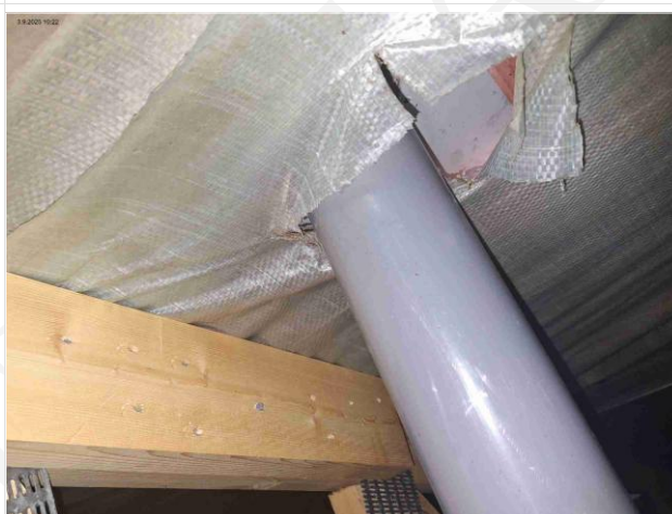
Kuva 42 Puutteellinen läpiviennin tiivistys
