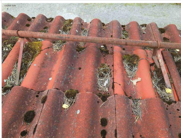
Kuva 98 Haljenneita tiiliä, rivitalo
