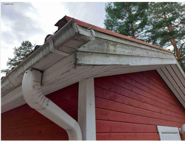
Kuva 13 Pihavaraston maalipinta kulunut
