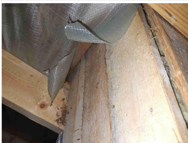
Kuva 46 Puutteellinen läpiviennin tiivistys, rivitalo
