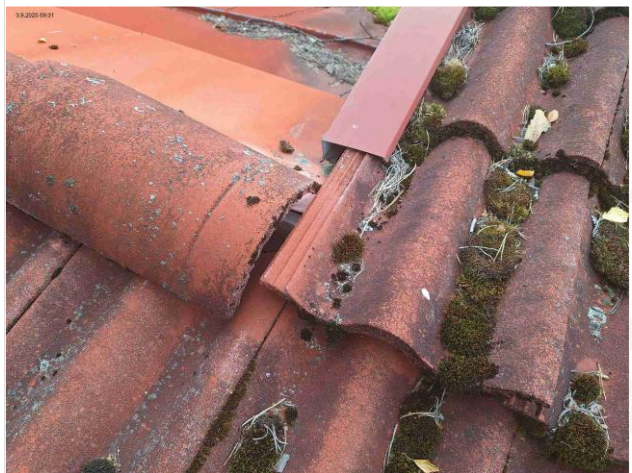
Kuva 104 Puutteellinen päätypellin ja katteen liitos
