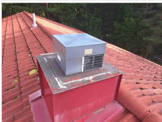
Kuva 156 Poistoimuri, laakerit ääntävät useassa koneessa
