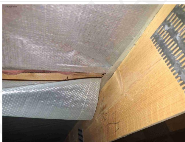
Kuva 60 Aluskatteen limitykset puutteelliset
