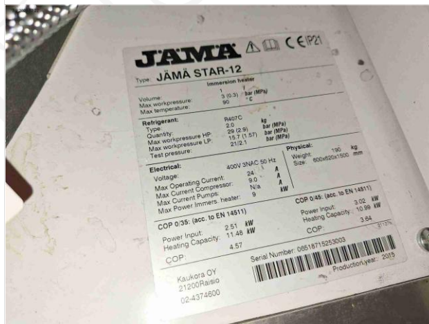
Kuva 130 Maalämpöpumpun tyyppikilpi, rivitalo
