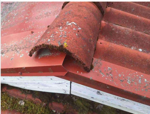
Kuva 103 Puutteellinen päätypellin liitos
