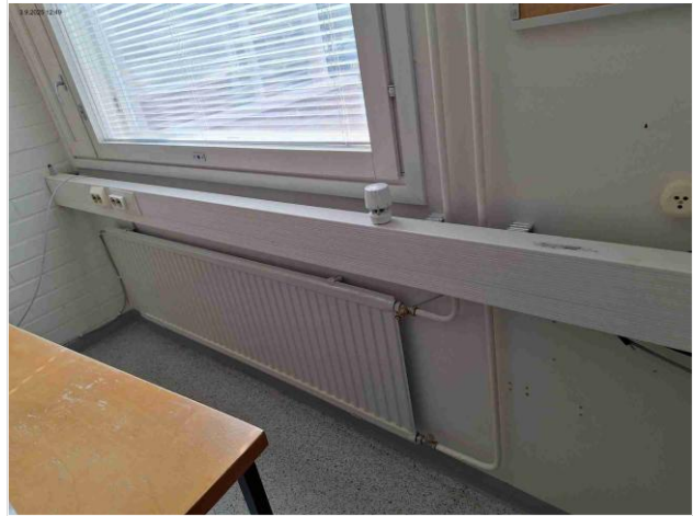
Kuva 184 Toimistotilassa muoviset johtokanavat
