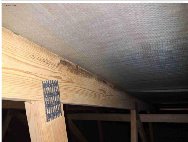
Kuva 49 Kosteusjälkiä kantavassa rakenteessa
