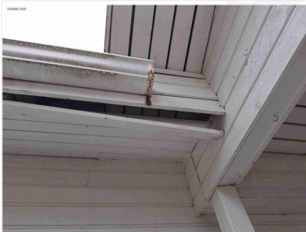
Kuva 89 Räystäslautojen kiinnitys oli puutteellinen
