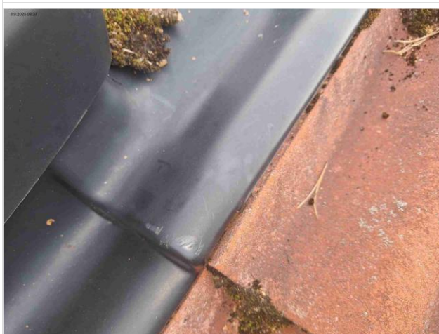
Kuva 99 Kattoluukun reunat epätiivit
