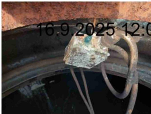
Kuva 146 Rasvaerottelukaivon jakorasia heikossa kunnossa
