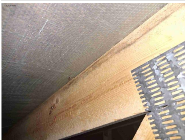
Kuva 57 Aluskate haurastunut, kosteusjälkiä
