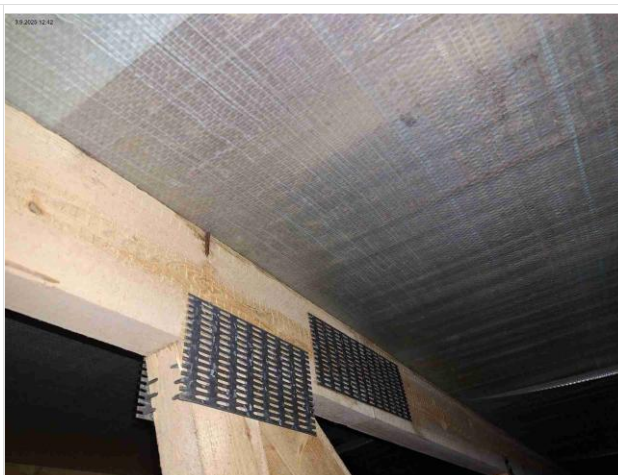
Kuva 52 Kosteusjälkiä kantavassa rakenteessa, rivitalo
