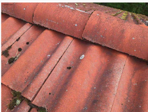
Kuva 97 Harja- sekä kattotiilet liikkuneet, rivitalo
