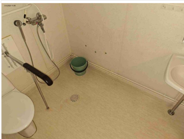
Kuva 142 Pesutilojen putket pinnassa, maalattua kuparia
