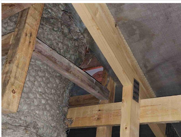
Kuva 45 Puutteellinen läpiviennin tiivistys
