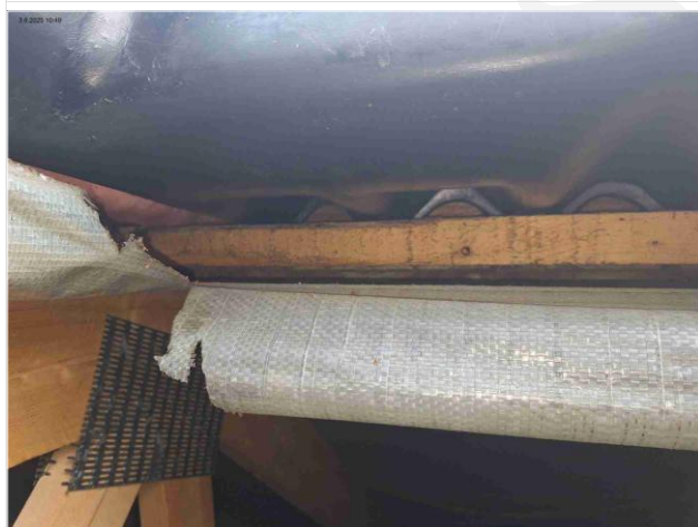
Kuva 43 Kattoluukkujen kohdalta puuttuu aluskatteen nostot
