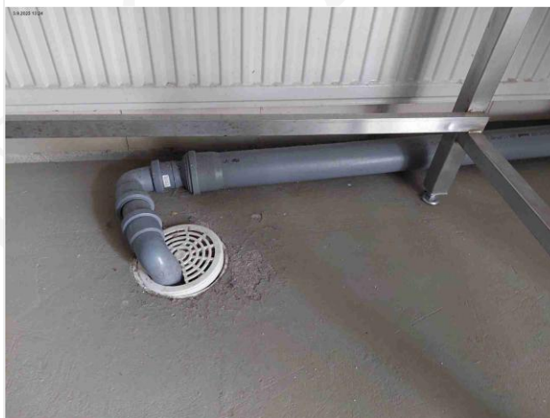
Kuva 34 Kosteuspoikkeamaa pesulan viemäriputken alla
