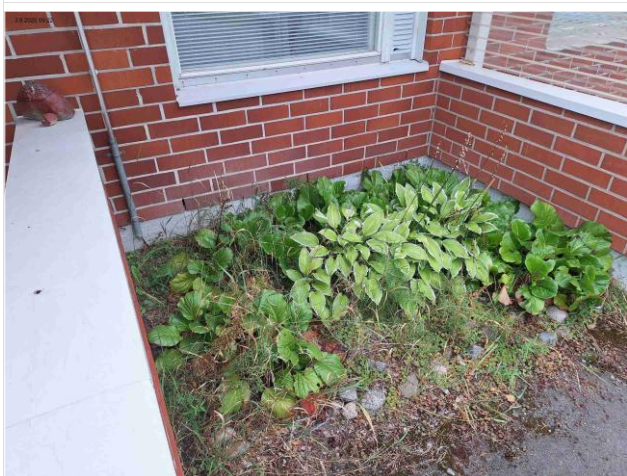
Kuva 30 Perusmuurin vierellä havaittiin kasvillisuutta
