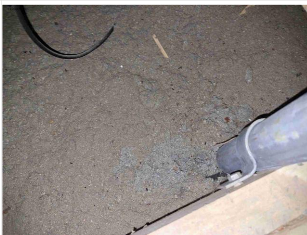
Kuva 56 Valumajälki eristeessä, rivitalo
