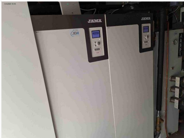
Kuva 127 Maalämpöpumput 1 ja 2 päärakennuksessa
