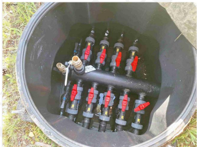
Kuva 136 Lämmityksen kokoojakaivo tontilla
