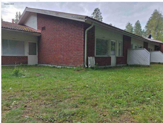
Kuva 19 Maanpinnan kallistukset puutteelliset
