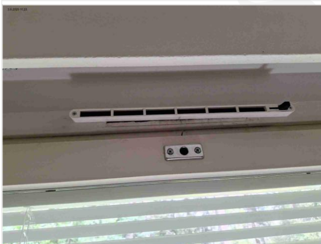
Kuva 174 Korvausilmaventtiilien kiinnitykset irronneet
