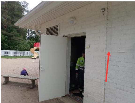
Kuva 33. IV-konehuoneen ulko-ovi oli hyväkuntoinen
