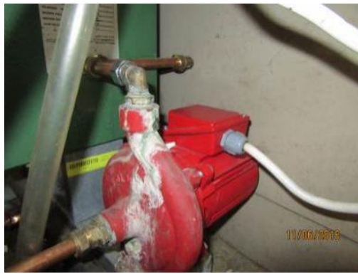
Kuva 55. Lämpimän käyttöveden kiertovesipumppu
