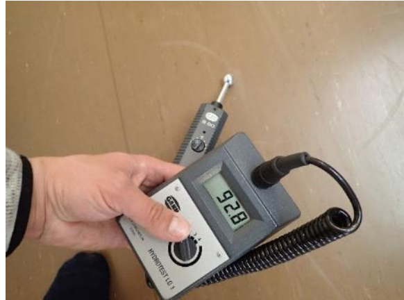
Kuva 47. Huonetiloissa muovimattolattioissa oli paikoin pintakosteudet koholla (>80)
