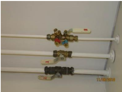
Kuva 62. Vesijohtojen sulk- ja linjasäätöventtiilit
