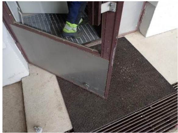
Kuva 34. Yleisesti ulko-ovien maalipinnat olivat kuluneita
