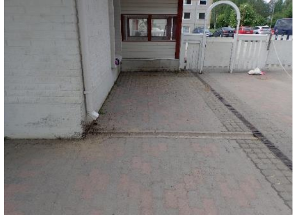
Kuva 4. Maanpintojen kallistukset ovat puutteelliset
