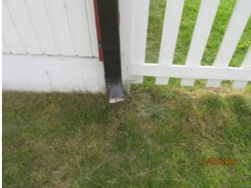
Kuva 74. Kaikkien syöksyputkien alla ei ole rännikaivoja
