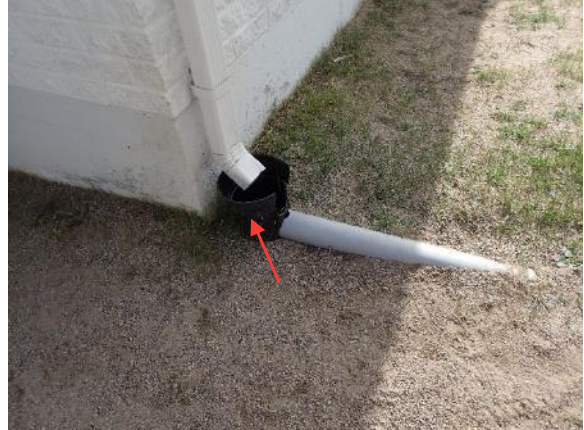
Kuva 8. Yksittäisten syöksyputkien alla on rännikaivo, josta vedet puretaan putkea pitkin tontin viereiseen rinteeseen. Sadevesiputki on näkyvillä ja saattaa rikkoutua lumitöiden yhteydessä
