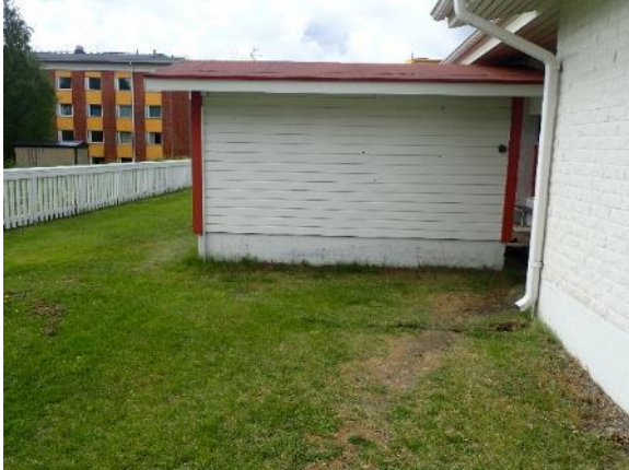
Kuva 3. Maanpintojen kallistukset ovat puutteelliset
