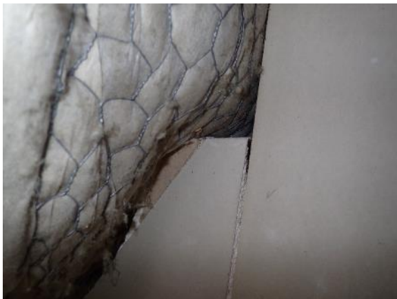
Kuva 37. Yläpohjan palo-osastoinnin läpiviennin tiivistys on puutteellinen
