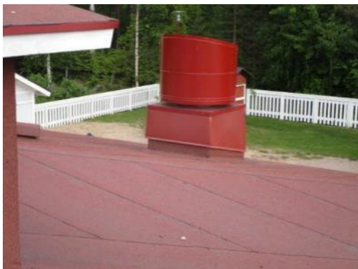
Kuva 80. Ilmanvaihtokoneen jäteilman ulospuhallushajotin
