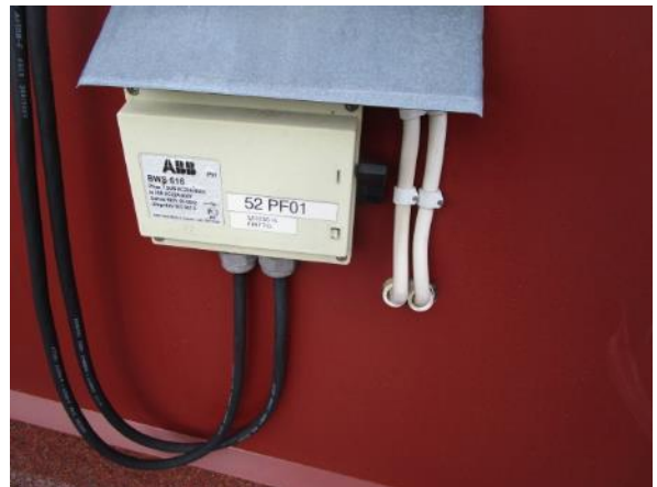
Kuva 98. Katolla läpivienti on tiivistämättä.
