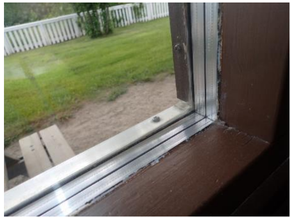
Kuva 28. Ikkunoiden maalipinnat olivat paikoin kuluneet
