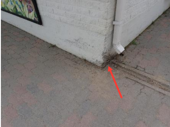
Kuva 7. Syöksyputken alta puuttuu loiskekuppi.
