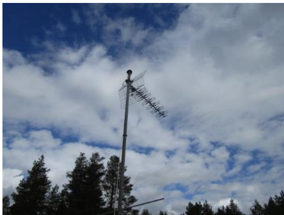
Kuva 106. Näkymää antenniharavasta katolla.
