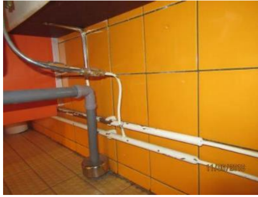
Kuva 61. Kupariputkia allastason alapuolella
