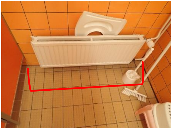
Kuva 50. WC:n lattialaatoissa havaittiin kopoalueita
