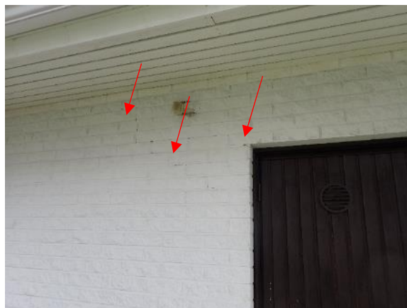
Kuva 25. Ulkoseinissä havaittiin yksittäisiä halkeamia
