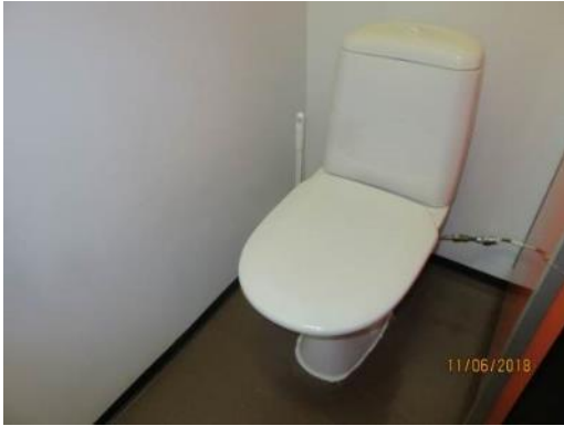
Kuva 66. Wc-istuin on irronnut kiinnityksestä
