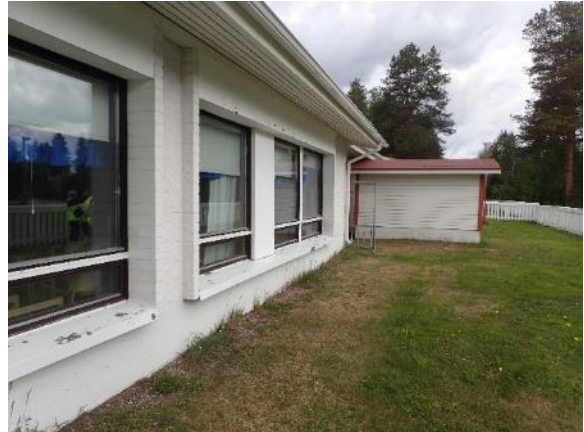
Kuva 6. Rakennuksen vierellä nurmikko rajautuu sokkeliin
