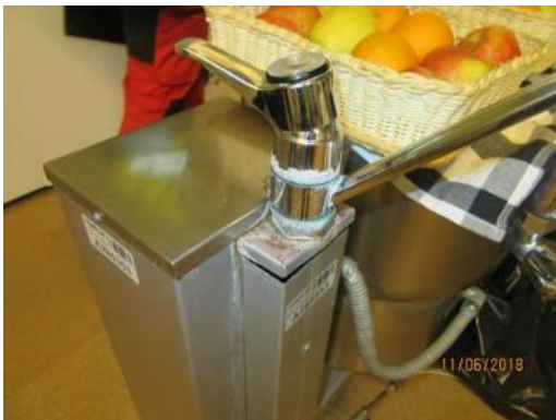
Kuva 64. Keittopadan hana on heikossa kunnossa
