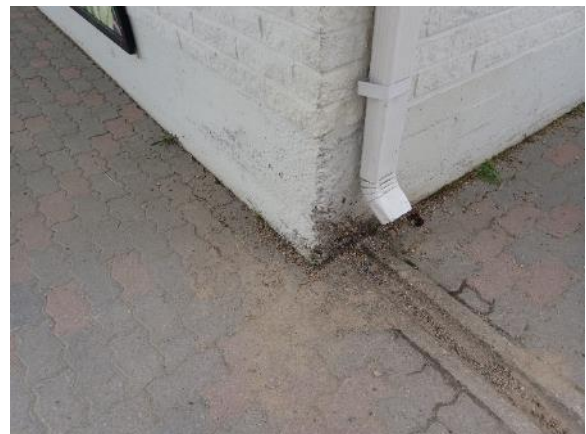
Kuva 20. Sokkelissa rapautumaa ja sammalkasvustoa syöksyputken kohdalla
