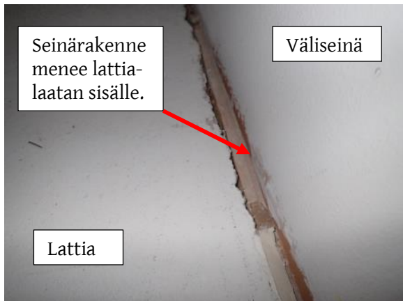
Kuva 21. Väliseinän runko ulottuu lattiarakenteen sisälle
