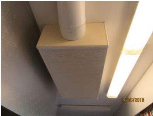
Kuva 84. Keittiön piennopeus tuloilmaventtiili
