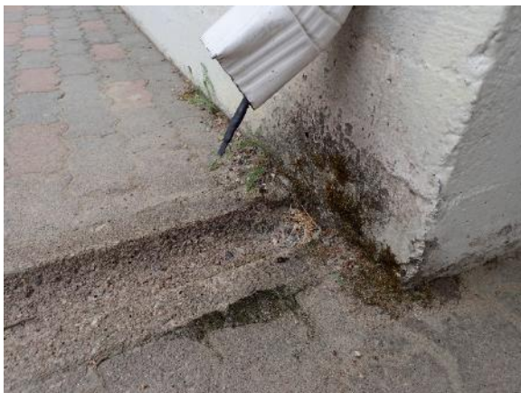
Kuva 19. Sokkelissa rapautumaa ja sammalkasvustoa syöksyputken kohdalla
