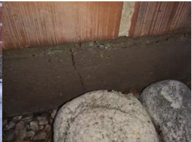
Sokkelissa halkeama etujulkisivun puolella
