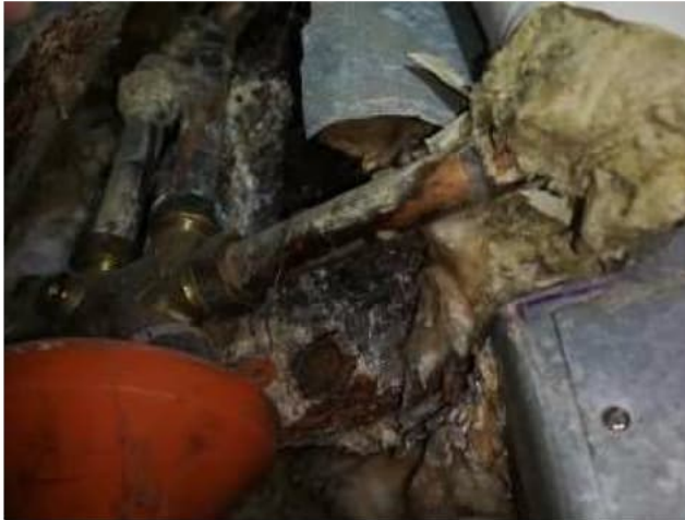
Varaajassa syöpymää ja ruostetta
