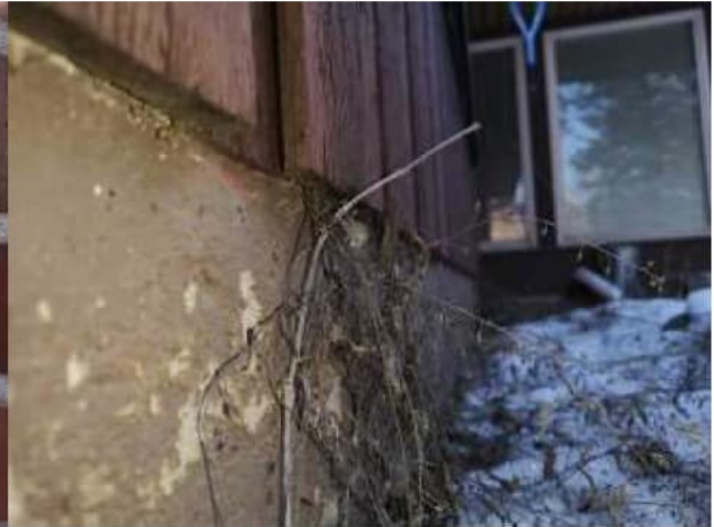
Ulkooverhouksen alaosa ei ole auki
