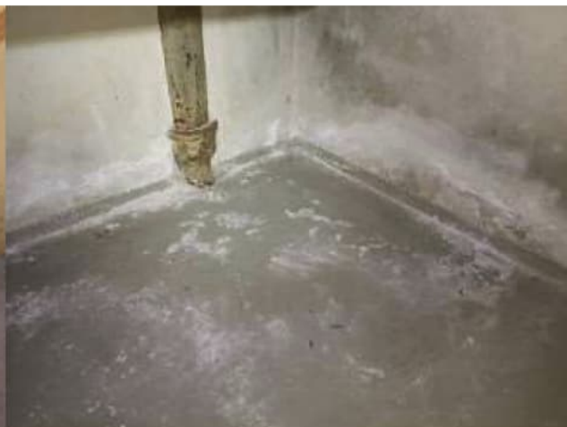
Kellarin lattiassa ja seinän alaosassa kalkkihärmää
