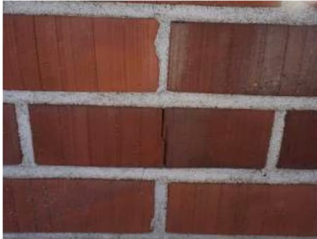
Tiilissä paikoin halkeamia
