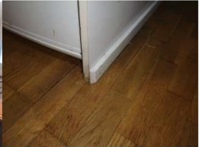
Parketissa vuoto-/kosteusjälkiä kylmäkoneen kohdalla
