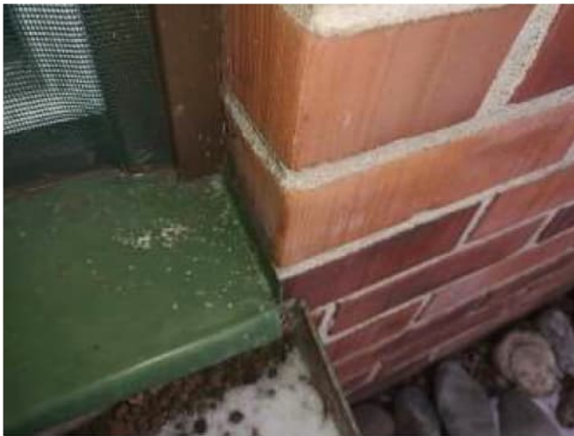
Ikkunan vesipellin nurkka ei täysin tiivis
