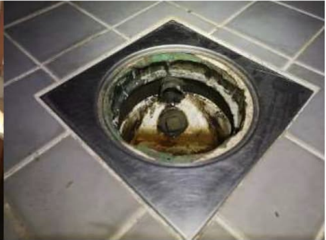
Vedeneristettä ei ole liitetty kiristysrenkaalla lattiakaivoon
