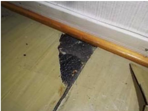
Pintabetonilaatta halki vaatehuoneessa, muovimatto asbestiliimalla kiinni
