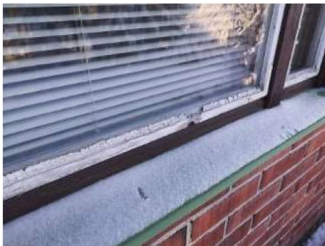
Ikkunan ulkopuite huonokuntoinen
