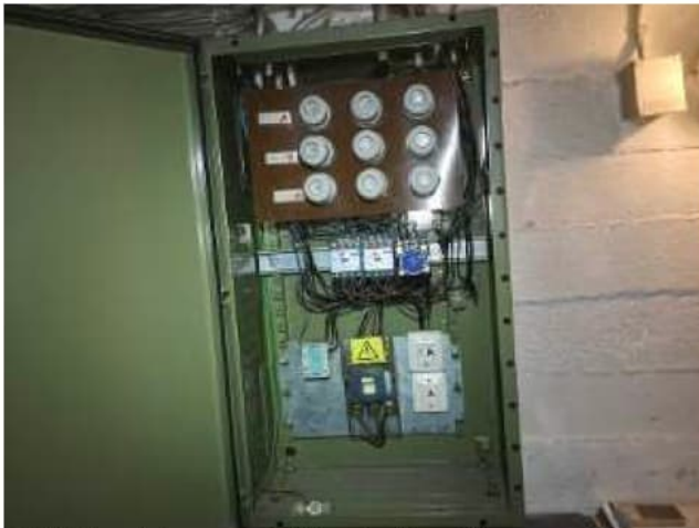
Sähkökeskuksessa johtimet näkyvillä
