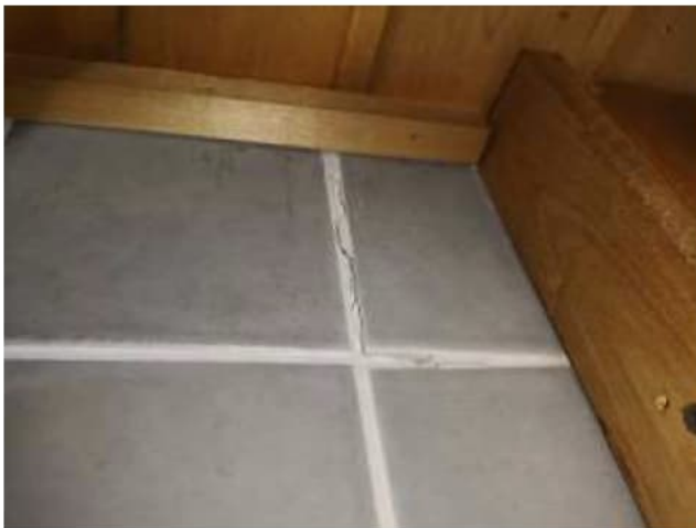
Saunan seinän yläosassa alustastaan irti oleva laatta
