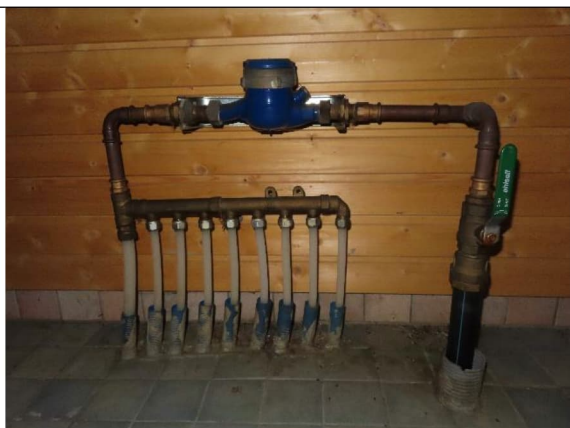
Vesimittari ja kylmänkäyttöveden jakotukki saunassa
