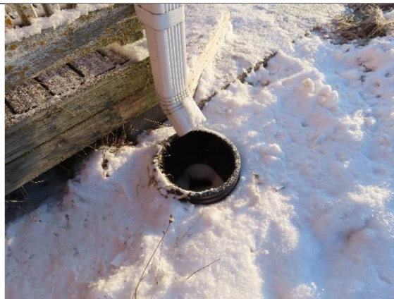
Rännien alustoissa on sadevesiviemärinti
