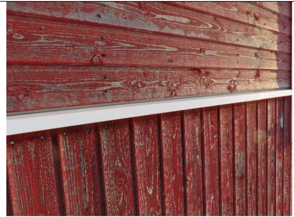
Julkisivuverhous alkaa olla paikoin huoltomaalauksen tarpeessa
