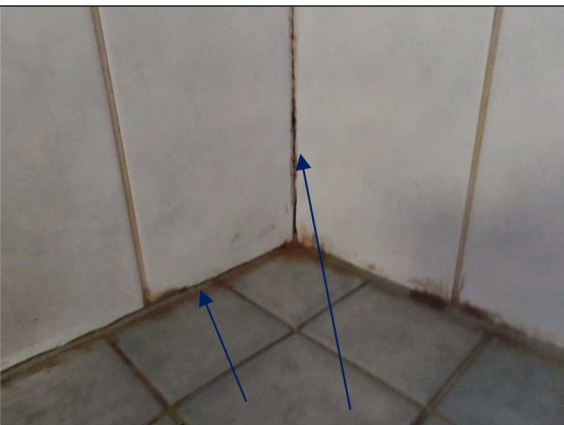
Nurkka- ja kulmasaumamat paikoin auki
