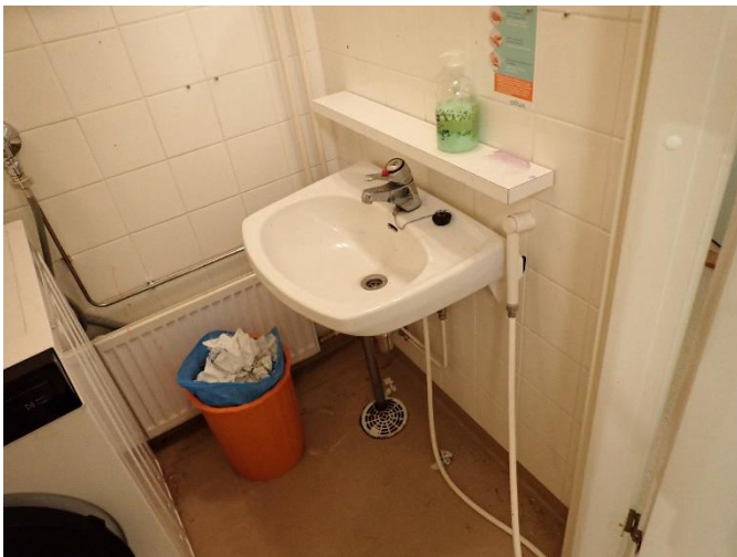
Toimistotilan wc:n lattia on välttävässä kunnossa.
