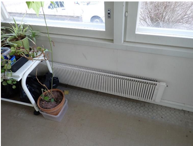
Lämmönjako on toteutettu seinäpattereilla.
