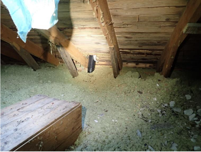
Yläpohjakuvaa. Viemärin tuuletusputki on eristämättä yläpohjassa.
