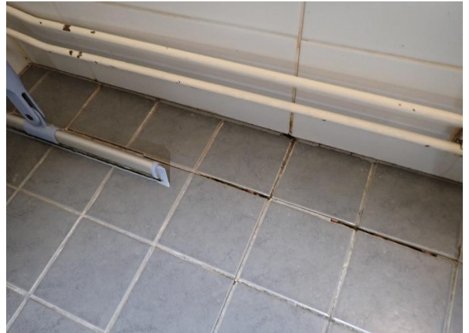
Yläkerran pesuhuoneen laattasaumat ja silikonisaumat ovat kuluneet.
