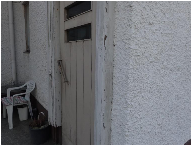
Takaovet ovat välttävässä kunnossa.
