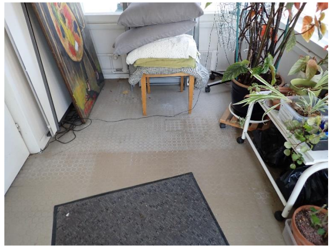
Sisääntulo on tyydyttävässä kunnossa.
