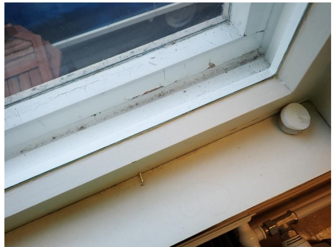
Toimistotilan ikkunat ovat tyydyttävässä kunnossa.
