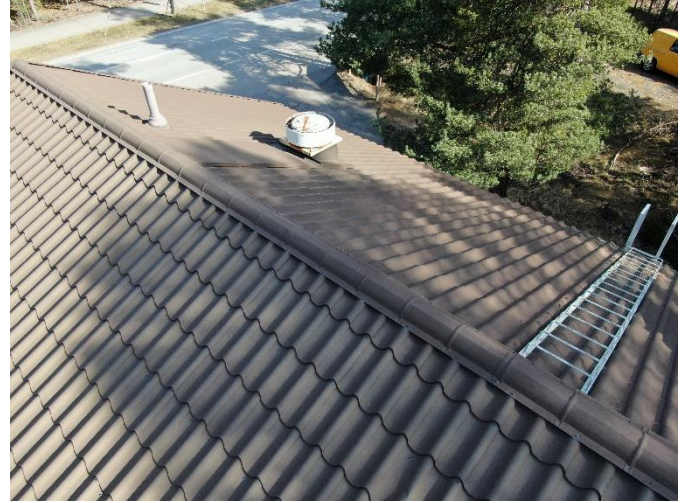
vesikate on tyydyttävässä kunnossa.
