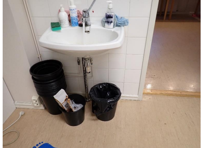
Vesipisteet ovat ulkoisesti tyydyttävässä kunnossa.
