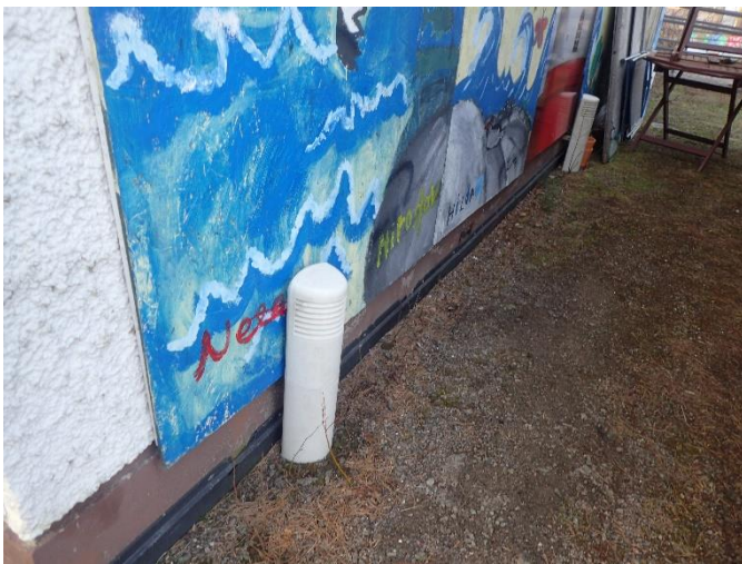
Sokkelimaali on hilseillyt paikoin.
