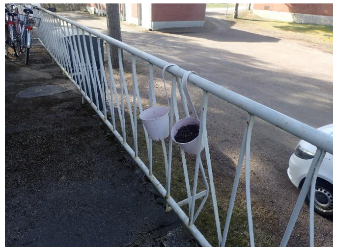
Rakennuksen kaide on matala.
