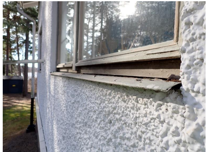
Osa ikkunoista on heikossa kunnossa.
