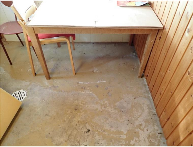
Kellarin tilat ovat heikossa kunnossa.
