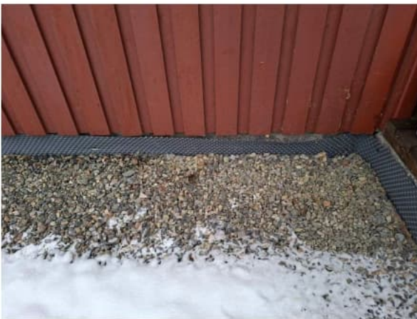
Kuva 24. Patolevyt on jätetty pitkiksi. Reunalistaa ei ole.
