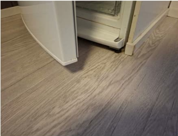
Kuva 57. Kodinkoneiden alapuolella ei havaittu vuotokaukaloita.
