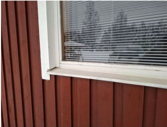
Kuva 36. Karmit kaipaavat maalia. Pellitykset riittävät.
