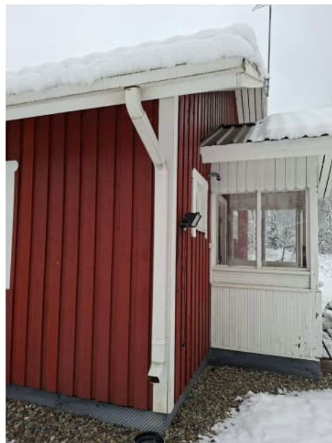
Kuva 38. Syöksytorven pudotuskorkeus liian suuri.
