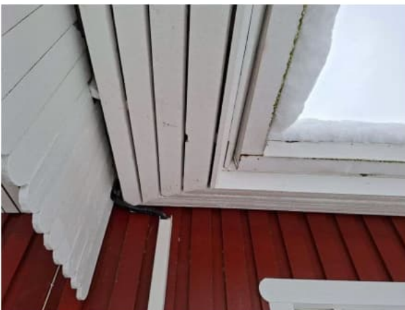
Kuva 7. Räystäskouruissa lieviä painaumia jiirin kohdalla.
