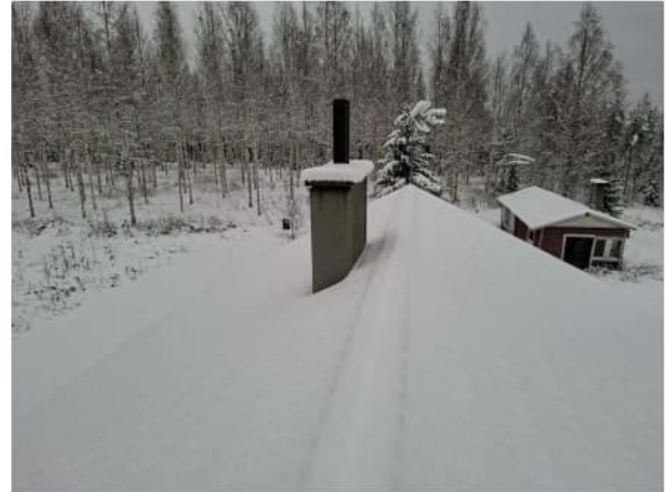
Kuva 2. Savuhormi on pellitetty. Sääsuojaa ei ole.
