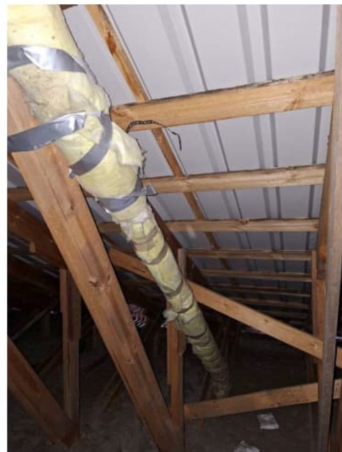
Kuva 8. Viemärin tuuletusputki yläpohjassa.
