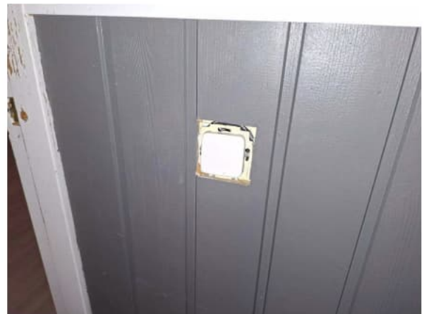
Kuva 62. Katkaisijoiden kansia puuttuu.
