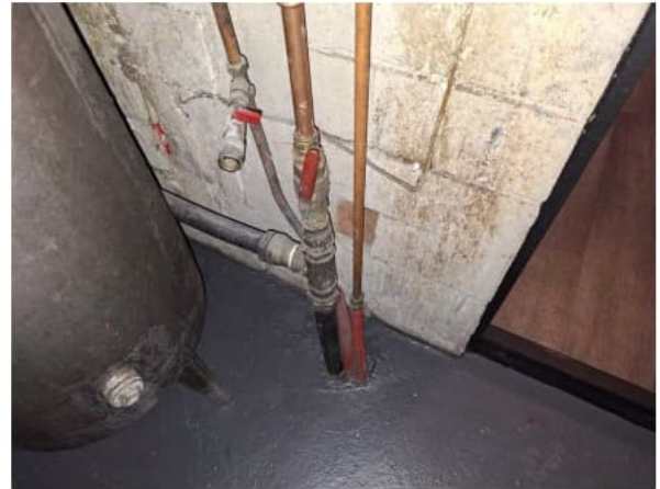
Kuva 58. Upolet putket kulkevat suojauputkien sisällä.
