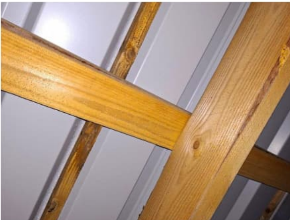
Kuva 19. Peltikate on hyväkuntoinen alapuolelta arvioituna.
