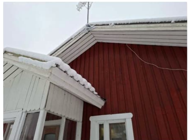
Kuva 21. Maalipinnassa on havaittavissa haalistumaa.
