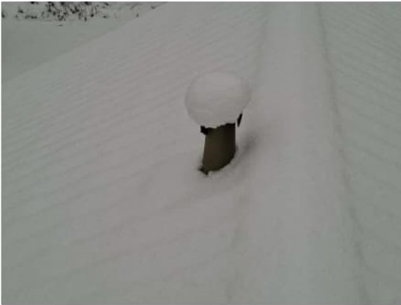
Kuva 5. Viemärin tuuletusputki katolla.
