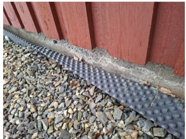
Kuva 25. Rapaumaa ja kalkkihärmää patolevyn takana.
