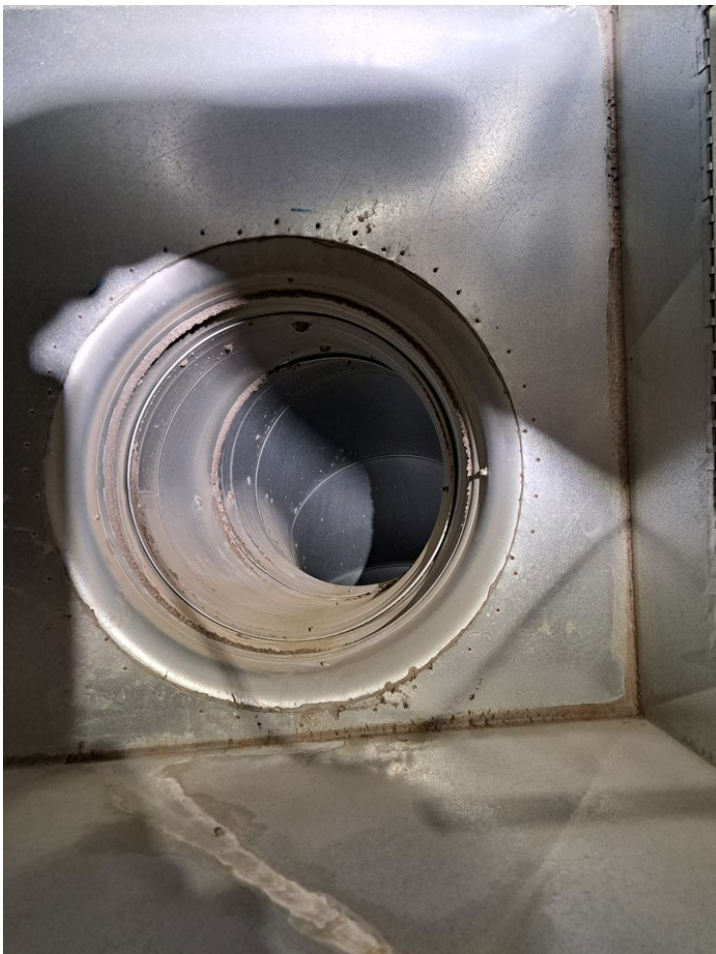
Kuva 14. TK03, Pölyä poistoilmakanavassa
