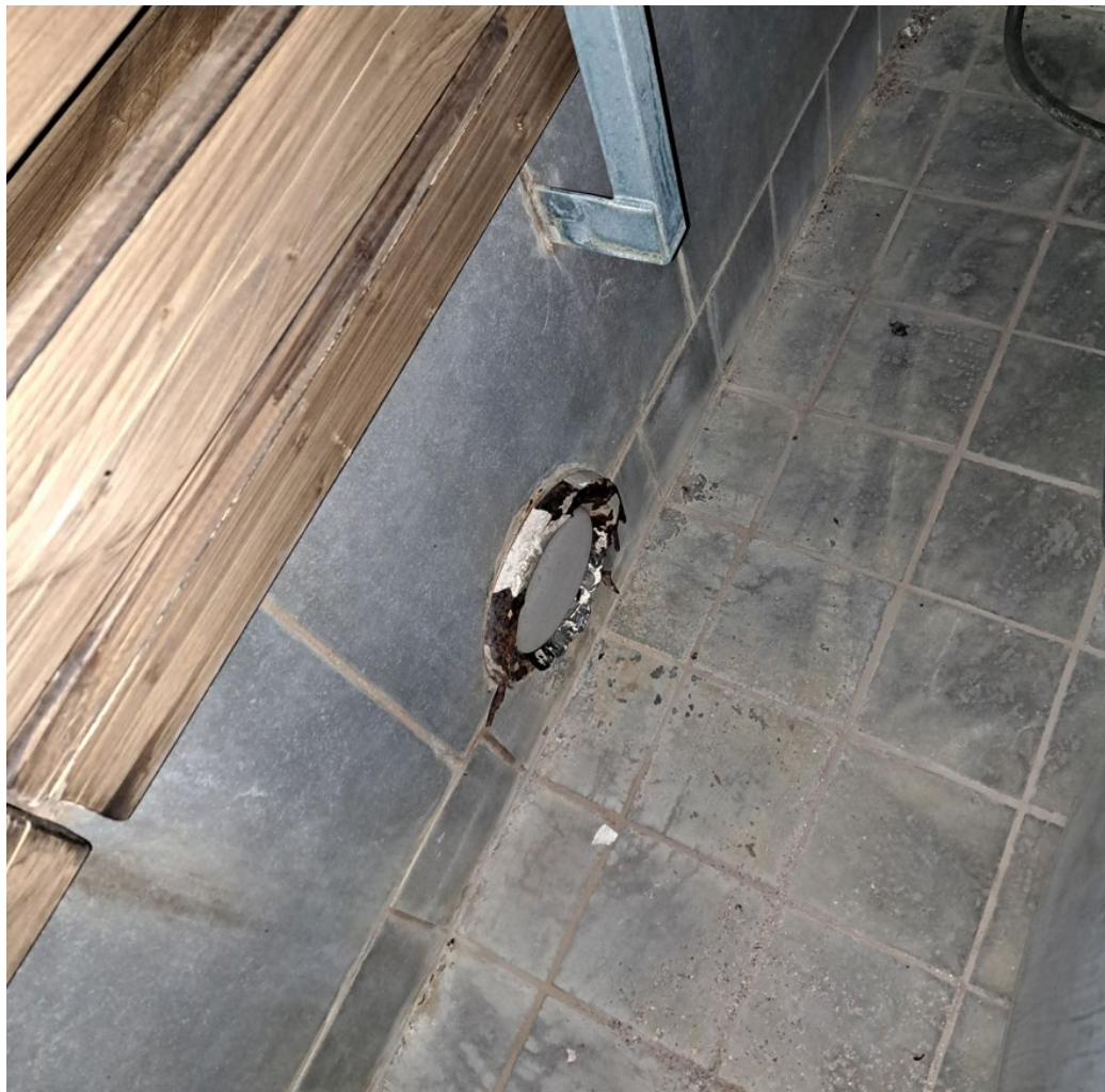
Kuva 17. Ruostunut poistoilmaventtiili karjalaisessa saunassa
