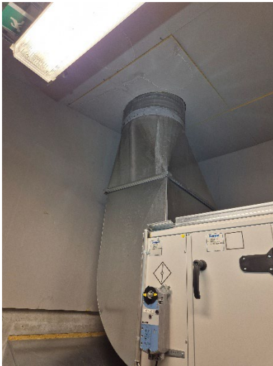
IV-konehuoneen sisäkatossa IV-läpiviennin kohdalla merkkejä vuodosta
