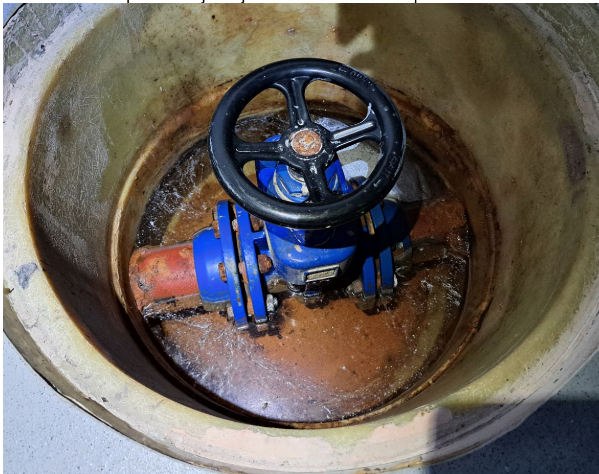
Kuva 11. Vettä väestönsuojan sulkuventtiilikaivossa.
