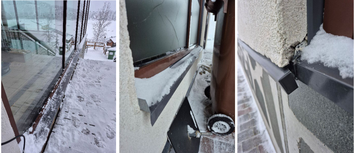
Ikkunapellityksiä yleensä, joitain kaato- ja tiiveyspoikkeamia
