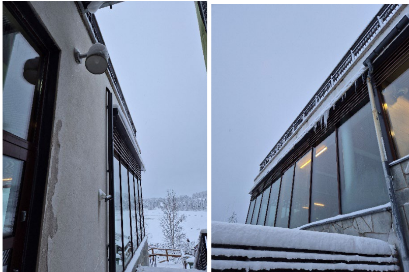
Huonokuntoista julkisivua terassin alueella
