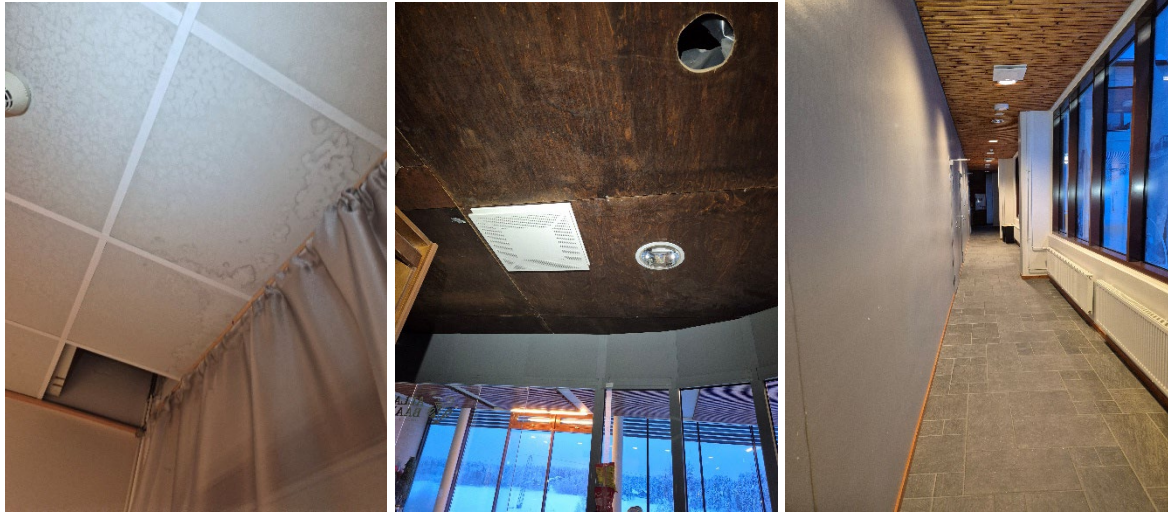
Vuotojälkiä ja irronneita levytyksiä, käytävän puurimotuskattoa
