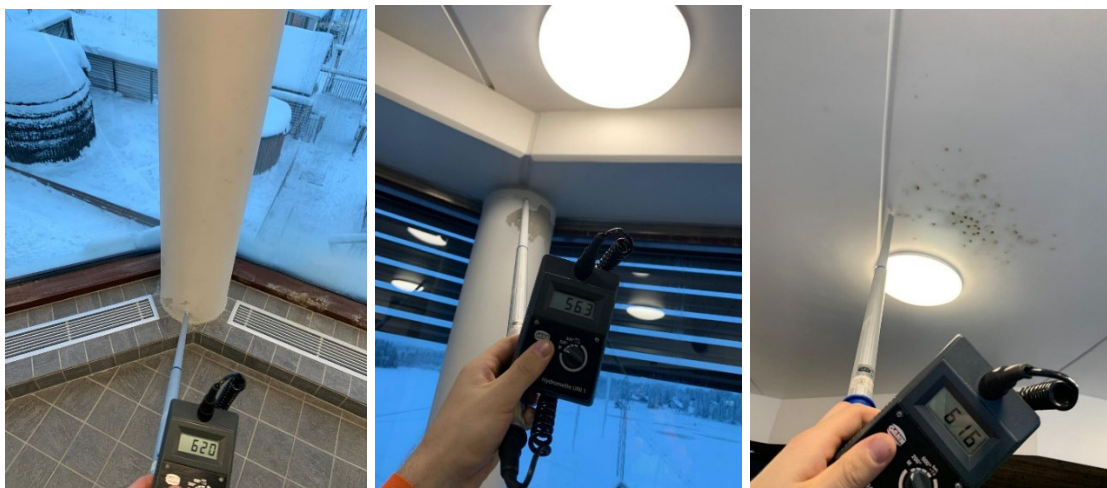
Kylpylän ulkoseinälinjan pilareiden ja palkkien hilseilleitä maaleja ja tasotteita, olesleku 124 roiskejälki katossa
