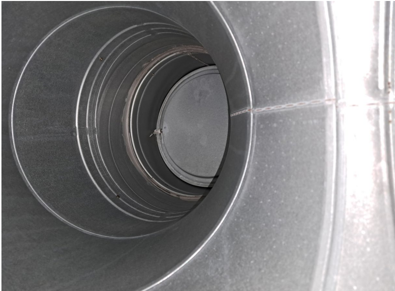
Kuva 13. TK03, Lauennut palopelti kanavassa
