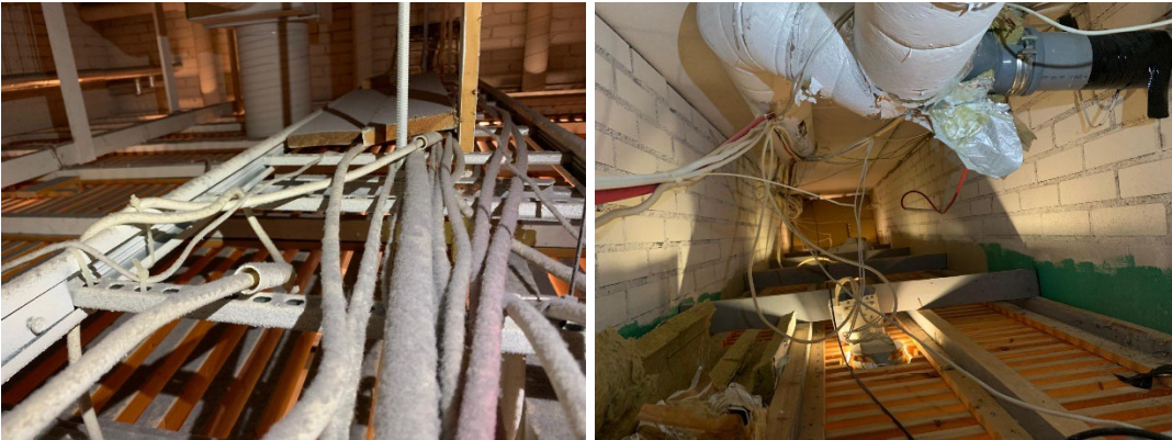
Rimoitetun alaslaskun yläpuolella pölyä ja eristevilloja
