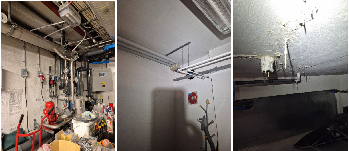
Yleiskuvia alemmasta välipohjarakenteesta ja hiushalkeama uima-altaan pohjassa
