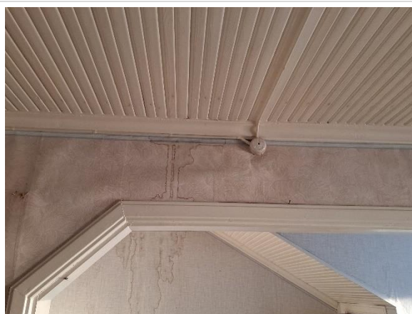
Spår av läckage i inredda rummet
