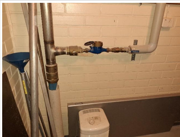
Inkommande vattenledning av plast
