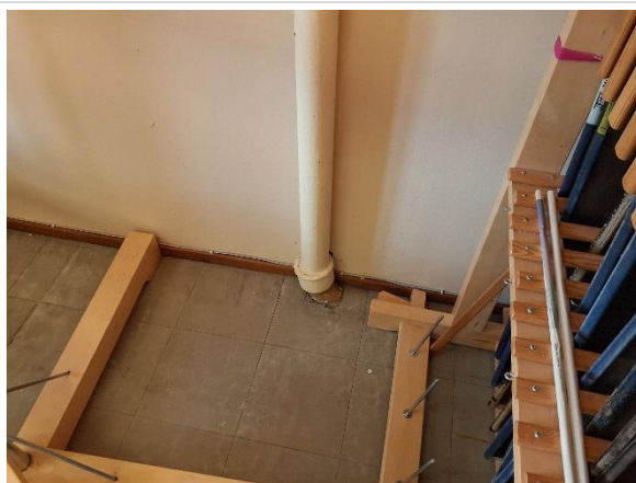
Avloppsrör av gjutjärn
