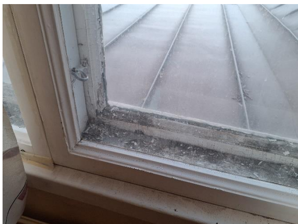
Fuktskadat fönster på andra våningen
