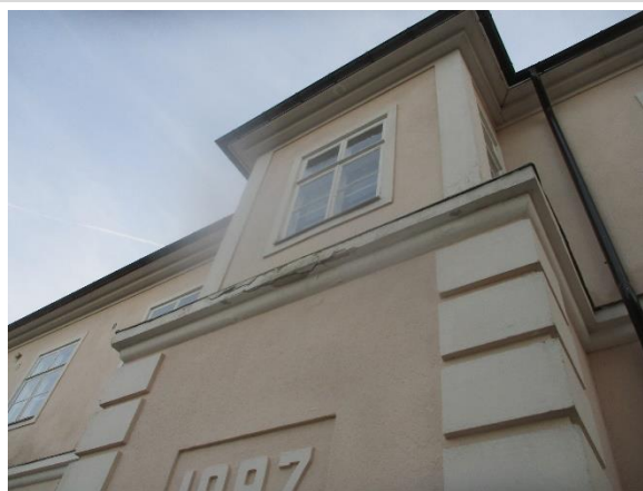
"Hyllan" på fasaden utanför trapphuset var vatten trängt in
