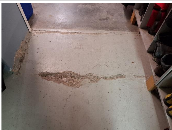
Spricka i golvet, på området uppmättes förhöjda fuktvärden
