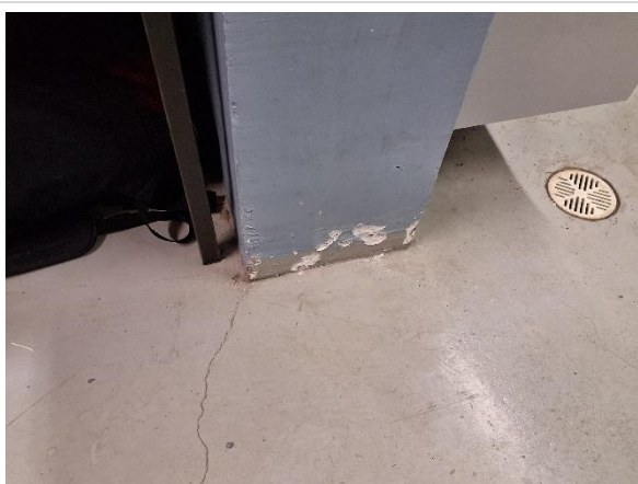
Spricka i golvet
