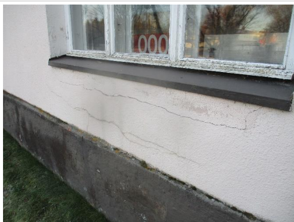
Sprickor i rappningen
