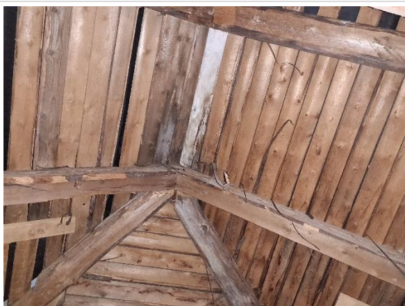
Spår av läckage inocken
