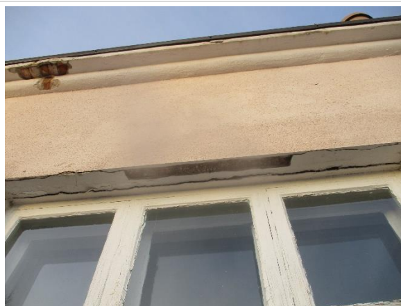
Rappning lossnat vid fönstersmyg och vid takkant
