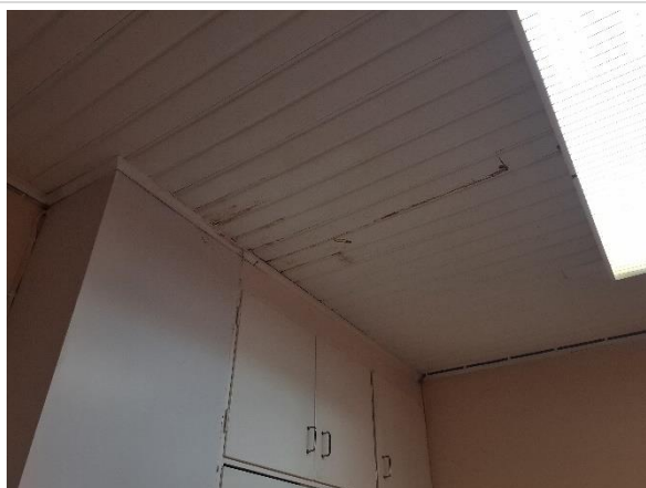
Spår av läckage i innertaket
