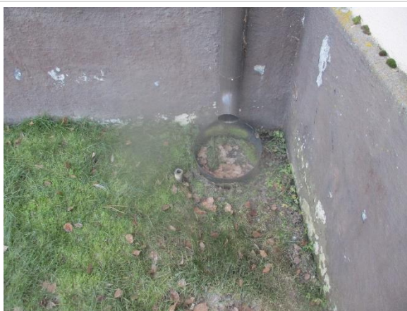
Regnvattenavlopp, uppsamlingsträtt full med skräp
