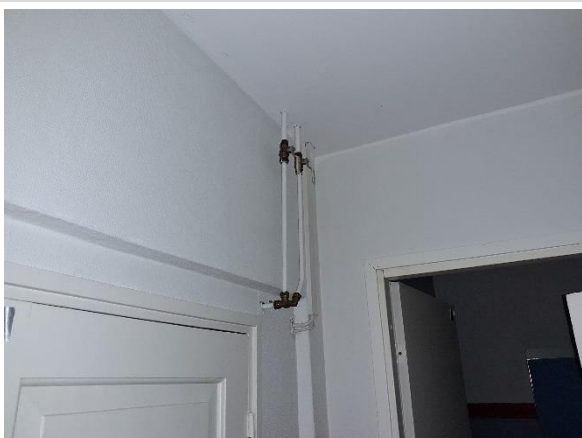
Bruksvattenrör på puts
