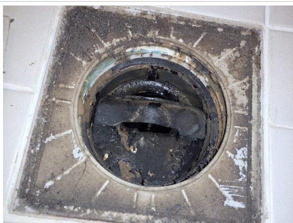
Golvbrunn av plast i badrum, stanklåset löst
