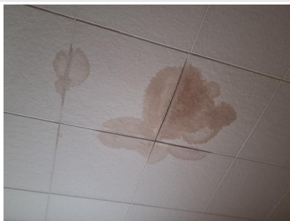
Spår av läckage i innertaket
