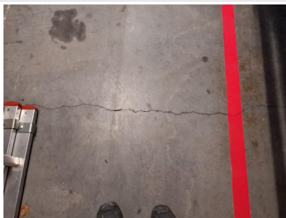
Spricka i golvet
