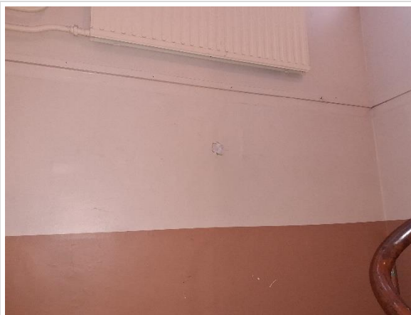
Skadad vägg i trapphuset
