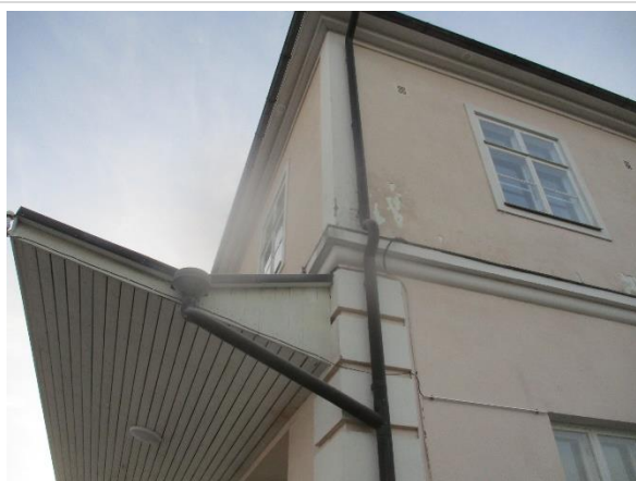
Skada på fasad som tyder på att gammalt stuprör har läckt
