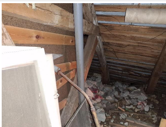
Avlopp av plast på vinden
