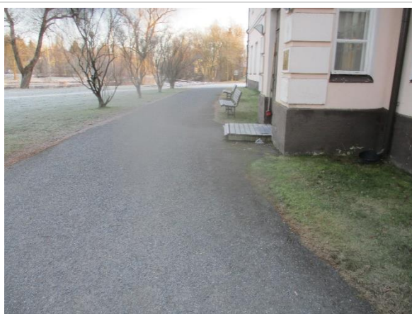
Byggnadens norra sida, bristfällig marklutning
