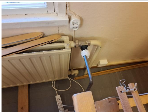
Radiator med förnyad termostat
