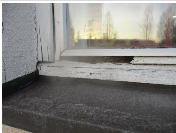
Rötskadad båge på tillbyggnaden
