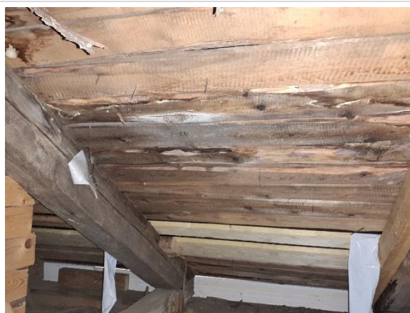
Spår av läckage
