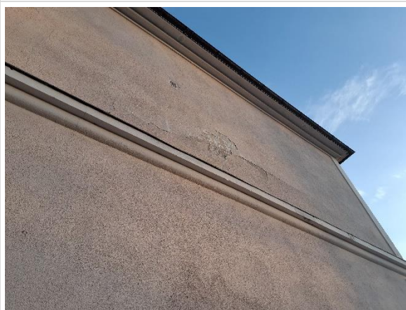
Rappningen buktar ut
