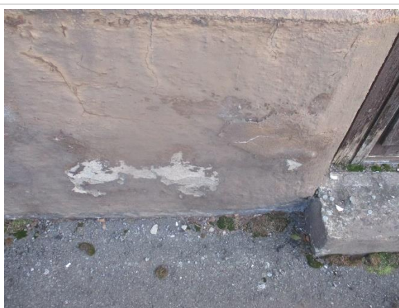
Små sprickor i sockeln
