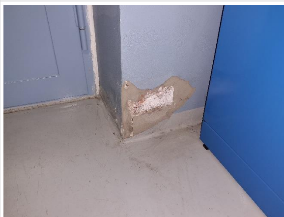
Kalkutfällning och rappning som vittrat sönder på insidan
