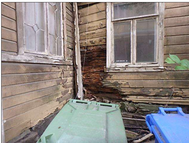
Kuva 12 L-rakennuksen sisänurkassa laajalti lahoa.
