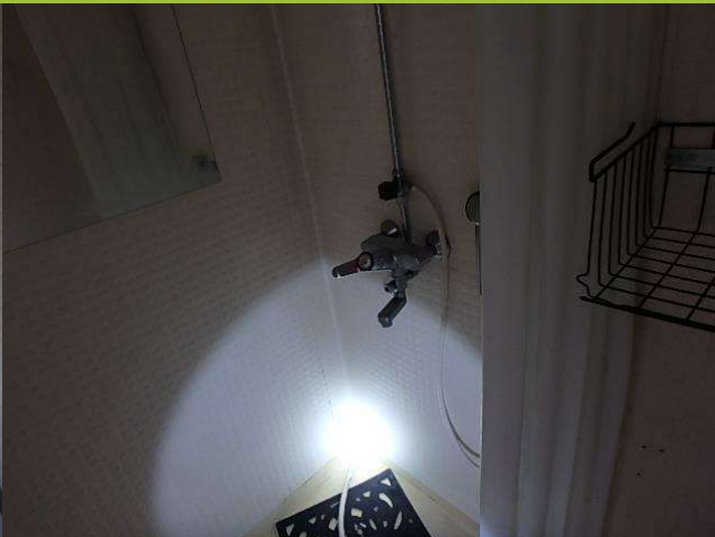
Kuva 35. Suihkunurkassa tapetin sauma hieman auki.
