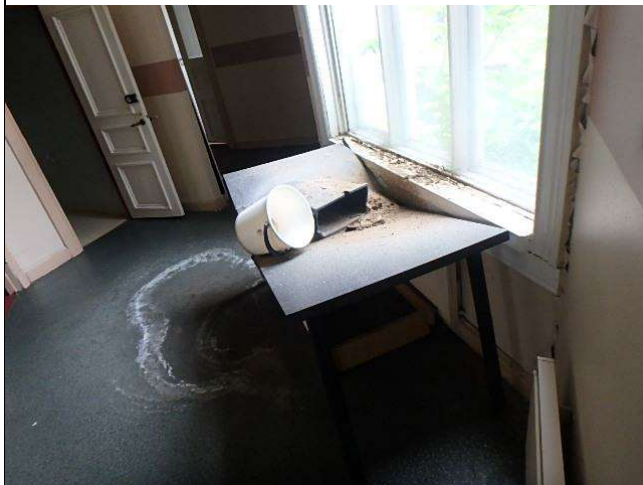
Kuva 11. Vettä vuotanut Kaskenkadun suuntaisen rakennuksen sisätilaan syöksytorvesta tai vuotavasta katosta.
