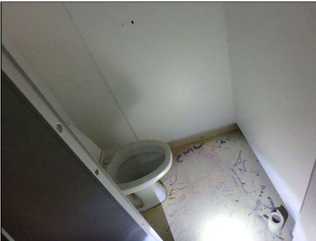
Kuva 41 Kaskenkadun suuntaisen rakennuksen keskikerroksen Wc-tiloja. Tiloja töhritty.
