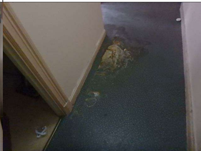
Kuva 55. Kaskenkadun suuntaisen rakennuksen wc-käytävän lattialle kaatunut jotain. Vuotoon tai kosteuteen viittaavaa ei tarkastushetkellä havaittu.
