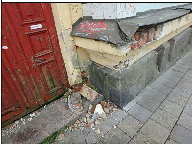
Kuva 5 Kaskenkadun suuntaisen rakennuksen sokkelirakenteessa vaurioitumista.
