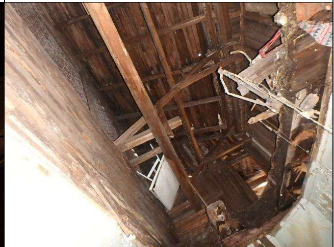
Kuva 21 Yläpohjarakenne sortunut L-mallisen rakennuksen nurkan läheltä.
