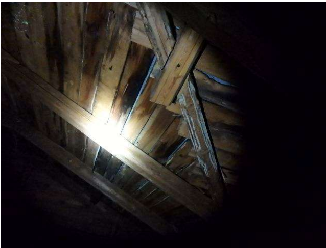
Kuva 28 Kaskenkadun suuntaisen rakennuksen vesikaton sisätaitteessa vuotojälkiä. Kohdan alla sisätiloihin valunut vettä.
