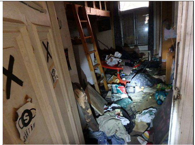
Kuva 49. L-mallisessa rakennuksessa asumiskäyttöön soveltuvia tiloja vain aivan sisäpihan päädyssä rakennusta. Muut rakennuksen tilat peruskorjauksen tarpeessa.
