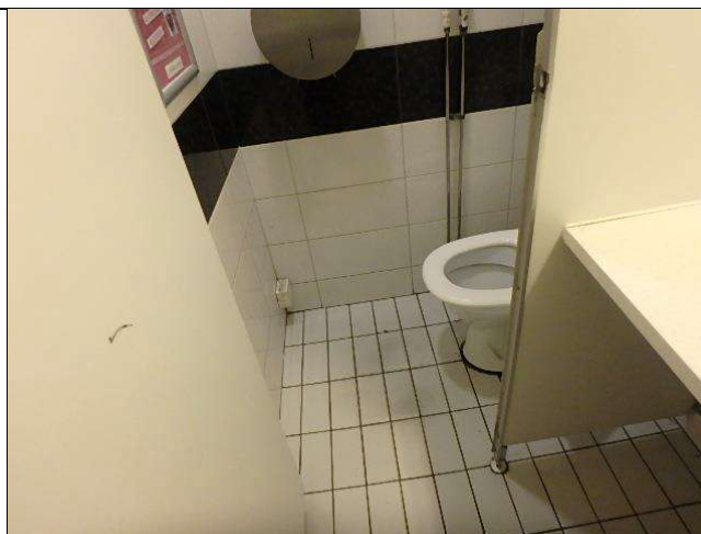
Kuva 46 Baarin wc-tiloja. Pinnat pesty ennen tarkastusta.
