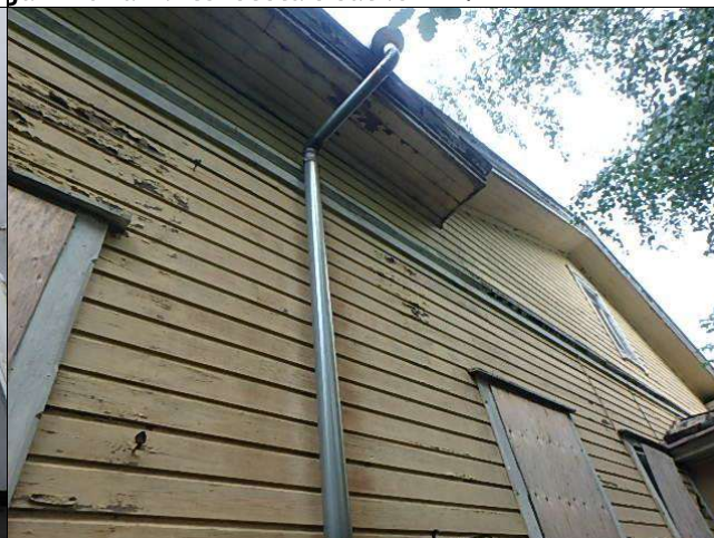
Kuva 15 Kaskenkadun suuntaisen rakennuksen julkisivun maalipinta on vaurioitunutta ja paikoin vettä valunut syksytorvista ulkoseiniin.
