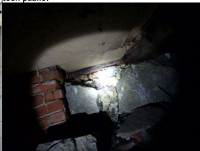
Kuva 6 Vuotavasta syöksytorvesta ohjautuu vettä ulkoseinän alaosaan.
