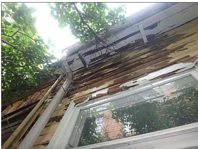
Kuva 7 L-rakennuksen takana räystäskouru/ vesikate vuotaa vettä ulkoseinälle
