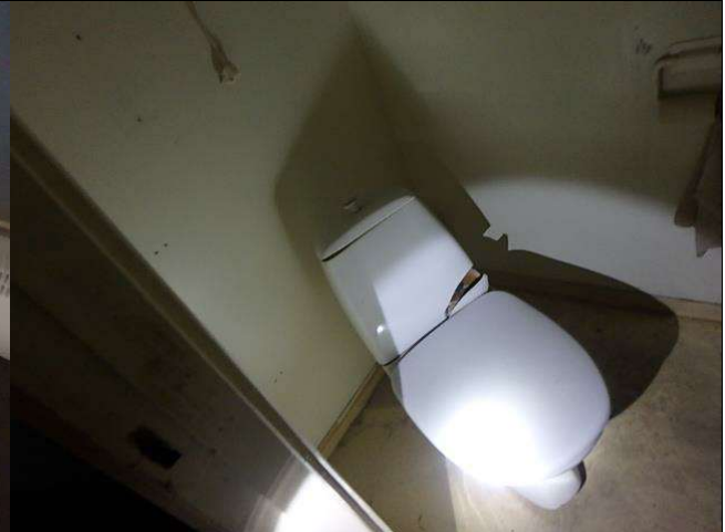
Kuva 44 Kaskenkadun suuntaisen rakennuksen keskikerroksen Wc-tiloja. Kalusteita rikki.
