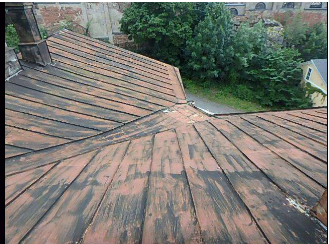
Kuva 29 Sisätaitteen alapäässä vuotojälkiä ja vettä valunut sisätiloihin. Katteen lähempi tarkastelu alueelta ei ollut tarkastushetkellä turvallista.
