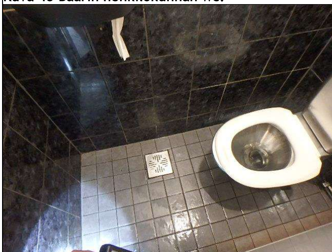
Kuva 47 Baarin wc-tiloja. Pinnat pesty juurin ennen tarkastusta.
