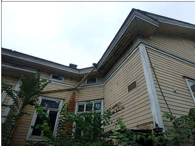
Kuva 9. Kaskenkadun suuntaisen talon syöksytorvi vuotaa vettä talon seinälle.
