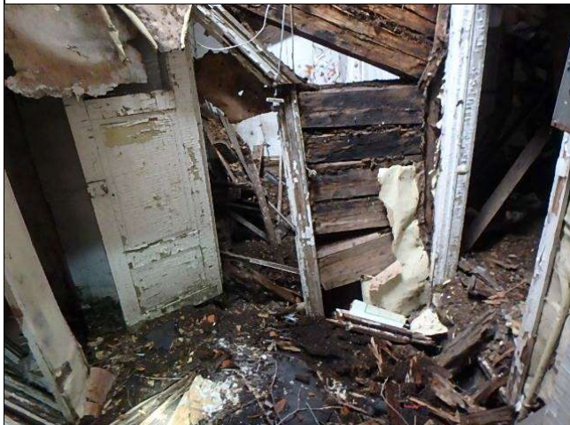
Kuva 3 Sortuneita rakenteita L rakennuksen keskiosalla.
