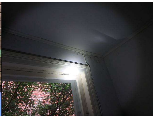
Kuva 13 L-rakennuksessa olevan asunnon ikkunan päälle vuotaa vettä. Purua tms valuu katon ja ikkunan liitoksesta sisätiloihin.
