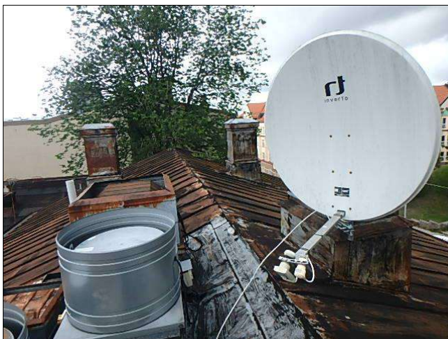
Kuva 22 Kaskenkadun suuntaisen rakennuksen esikattoa. Vesikate on kulunut ja pinnaltaan epäsiisti.
