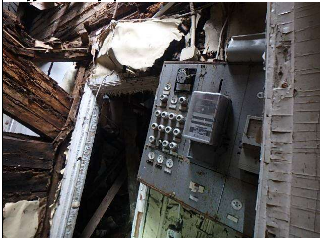
Kuva 58 Sähkökeskus sortumavaarassa olevalla osalla L-malli rakennusta. Suositeltavaa on varmistaa, että nousujohto keskukselle on jännitteetön.
