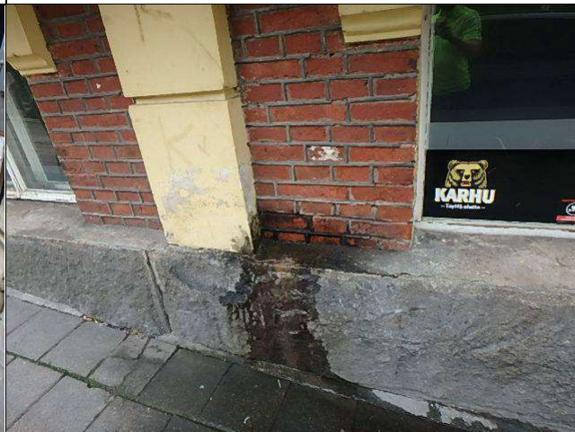
Kuva 4 Kaskenkadun suuntaisen rakennuksen jäähdytyslaitteista tippuu vettä sokkelirakenteen päälle.
