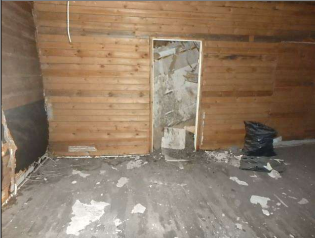
Kuva 50. L-rakennuksen galleriatiloja kaskenkadun päässä. Vesikatto vuotaa ja sisäpihan suuntaan rakenteita sortunut.
