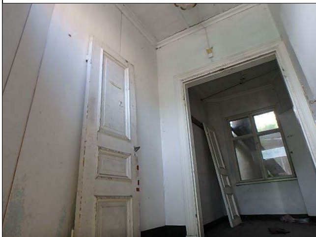
Kuva 14 L-rakennuksen kaskenkadun päädyssä seinien sisäpinnoilla mikrobikasvua.
