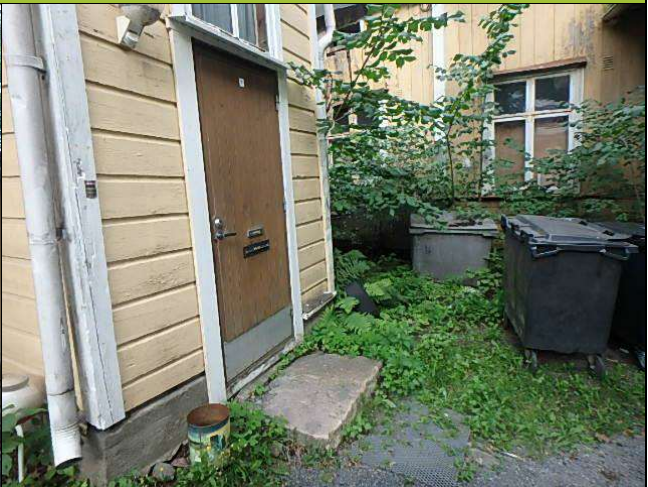
Kuva 17. L-rakennuksen asunnon ulko-ovi on ikkääntynyt.
