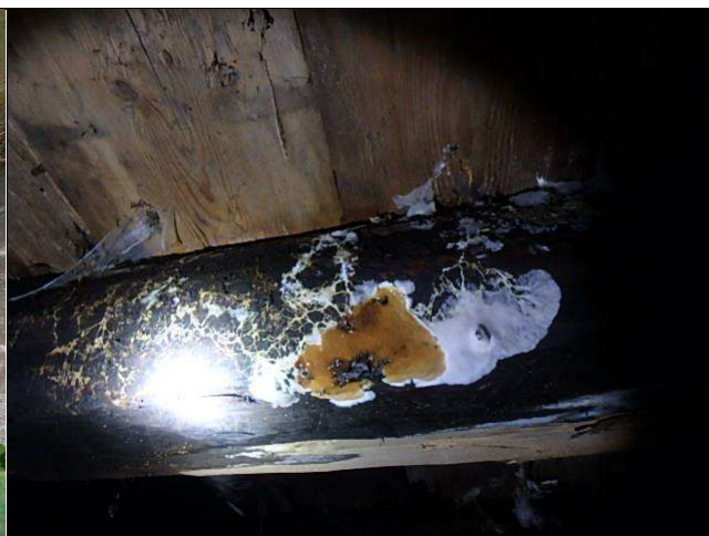
Kuva 2 L-rakennuksen alapohjarakenteissa lahoittajasienen kasvua.
