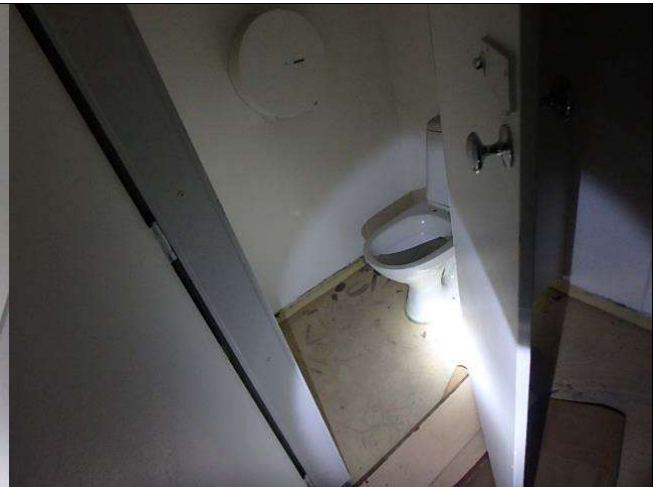
Kuva 42 Kaskenkadun suuntaisen rakennuksen keskikerroksen Wc-tiloja. Tiloja töhritty.
