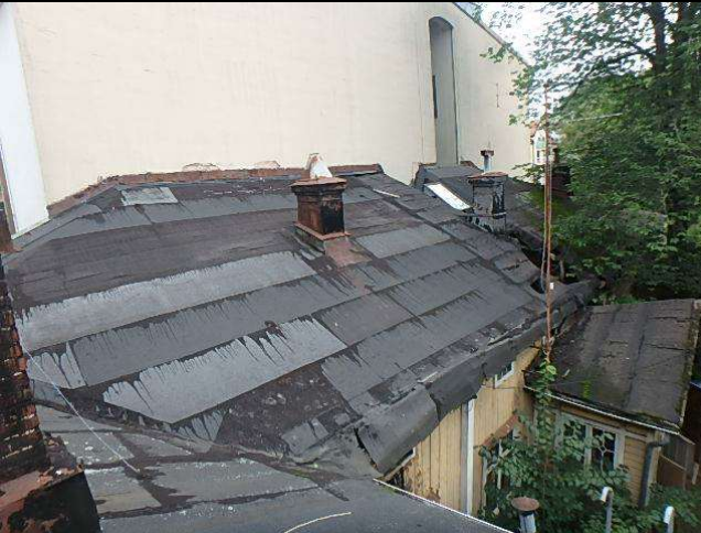
Kuva 18 L-mallisen rakennuksen vesikattoa asuinkäytössä olevasta osasta Kaskenkadun suuntaan, kattorakenteet laajalti romahtaneet.
