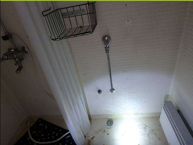
Kuva 34 Suihkutilaa. Tilassa oleva pesukoneen hana vuosi vettä lattialle. Hanakulma suljettiin tarkastuksella.
