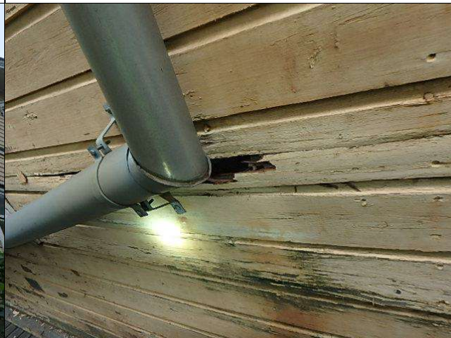
Kuva 10. Syöksytorvi vuotaa Kaskenkadun suuntaisen rakennuksen päädystä.
