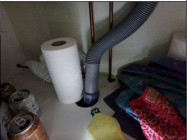
Kuva 37. Allaskaappia. Pohjalevyä ei ollut tiivistetty
