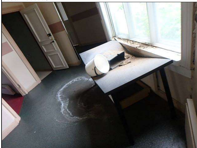
Kuva 54. Kasken kadun keskikerroksessa pöytä rikkoutunut sisälle valuneesta kosteudesta ja lattiassa kuivuneen veden jättämä läikkä
