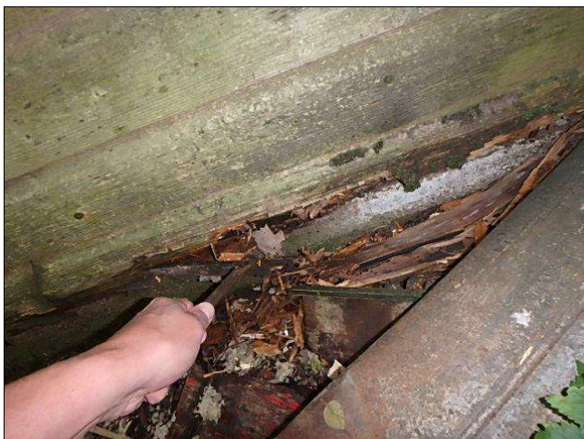
Kuva 1 L-rakennuksen takasivulla alin hirsirakenne vaurioitunut.
