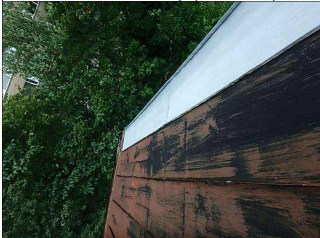
Kuva 24 Kaskenkadun suuntaisen rakennuksen vesikatolla yksittäinen uusittu kattopeltivuota.
