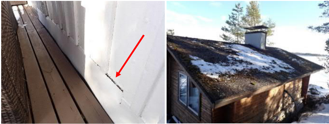
Kuva 60. Parvekkeelta havaittiin, että pellin ylösnosto ulkoseinää vasten ei ollut tiivis yläreunasta.
