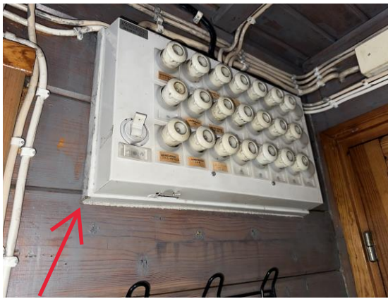
Kuva 7. Sähkötaulun massalevy sisältää asbestia.
