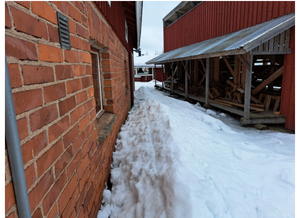
6. Takkatupa. Kattovedet valuvat suoraan katolta maahan.
