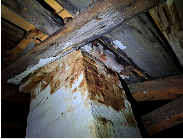
1. Kosteusjälkiä pamarin yläpohjatilassa.
