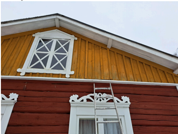
32. Pakarin päädyn lautaverhousta. Huoltomaalaus- / kunnostustarvetta havaittavissa.
