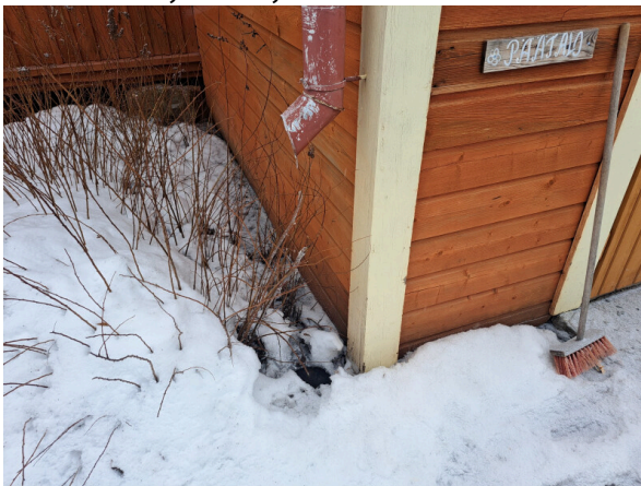
30. Päätalon lautaverhous ulottuu lähelle maanpintaa, riskinä kosteusvaurioituminen.
