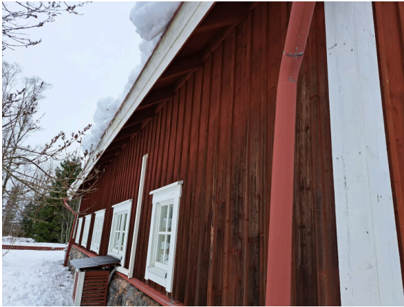
34. Heiskasalin ulkoseinää. Kunnostustarvetta.
