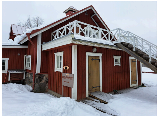
33. Heiska-salin ulkoverhousta. Parvekerakenteissa huoltomaalaus- ja kunnostustarvetta.
