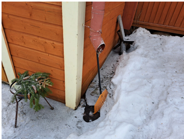
3. Päärakennuksen kattovesien ohjausta. Syöksytorvesta otetaan kasteluvettä.
