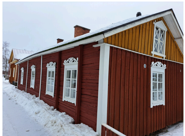
25. Pakari. Perustusten/ hirsirungon painumisesta johtuvaa vääntymistä havaittavissa.
