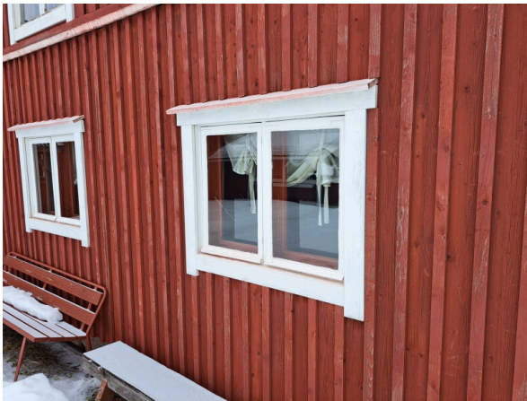
36. Takkatuvan puuverhousta. Huoltamaalaustarvetta.
