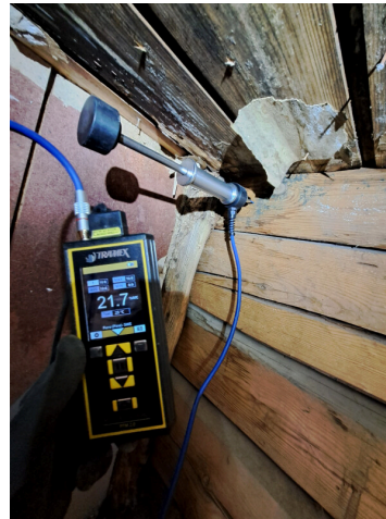
132. Varaston seinän yläosien hirsissä kosteus kohollaan vuotokohdalla
