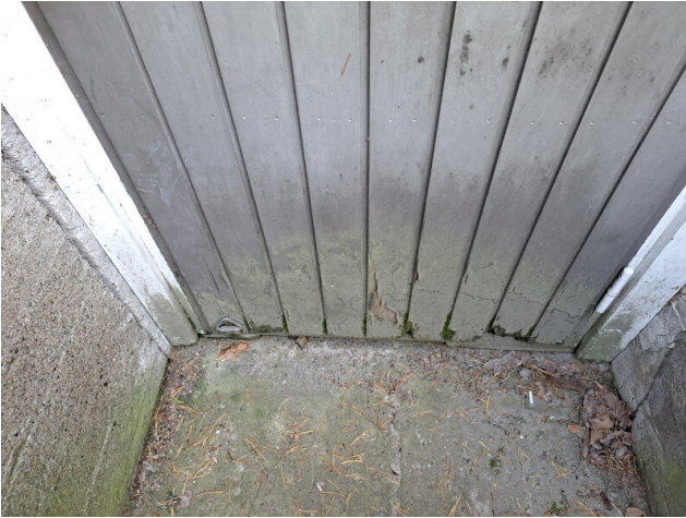
56. Kellarin oven alaosissa maalipinta irti ja oven alaosissa pehmentymää
