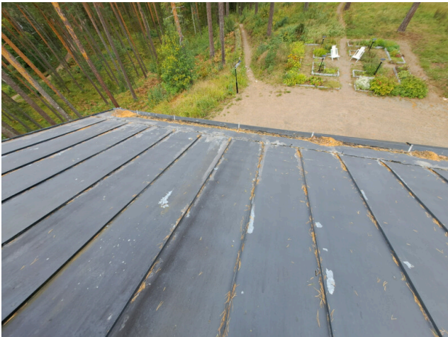
65. Keittiön vesikaton maalipinta paikoin irronnut
