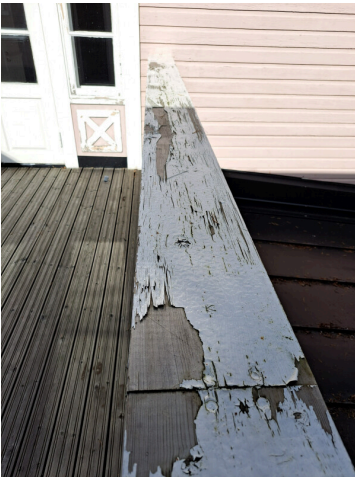
52. Kattoterassin kaiteiden puuosissa maalipinta irti
