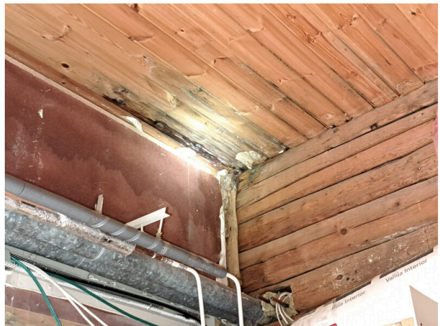
130. Vesikaton vuodoista johtuen yläpohjassa kosteusvauriota
