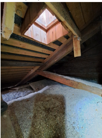
73. Keittiön yläpohjan kohdalla tuuletuskanavan kautta päässyt vettä yläpohjaeristeille
