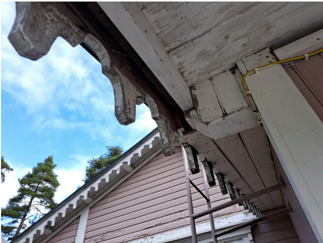
46. Maalipinnat tummuneet räystään puuosissa
