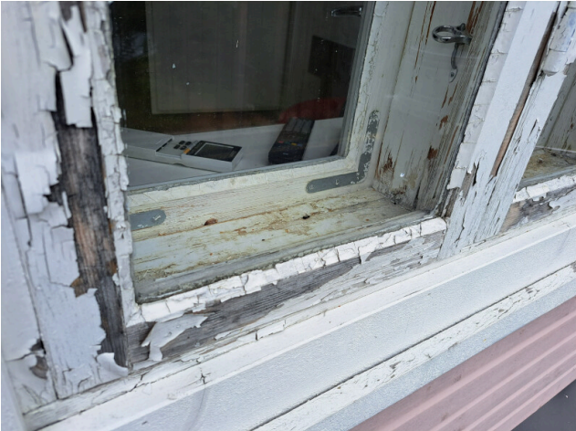
54. Ikkunan puitteiden maalipinta vaurioitunut
