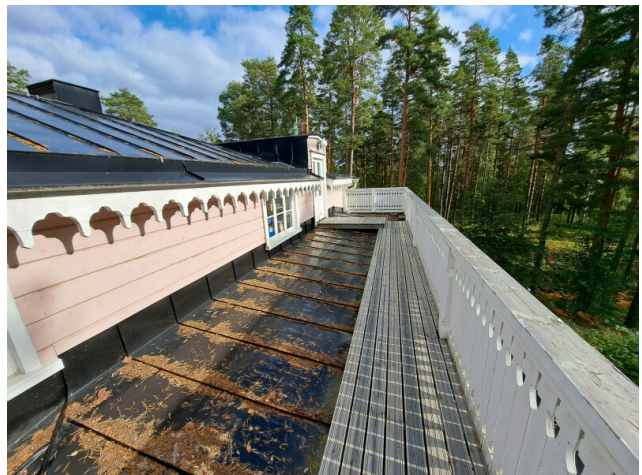
49. Kattoterassia verannan kohdalla. Kaiteiden maalipinnat hilseilee.
