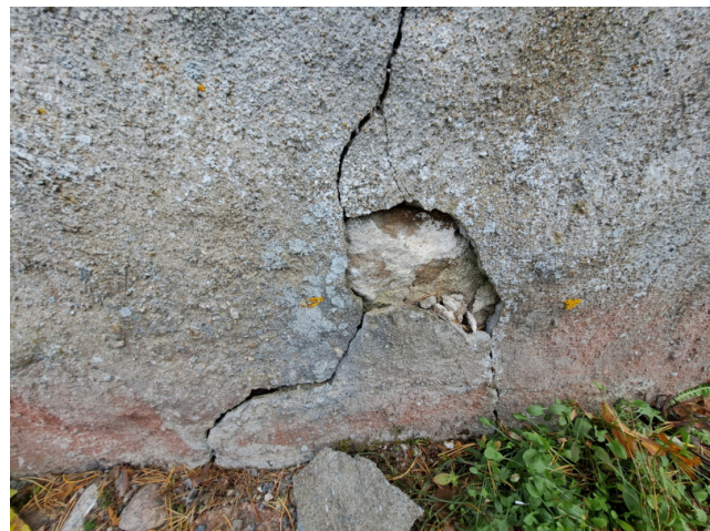
2. Sokkelin betonirappauksessa vaurioita
