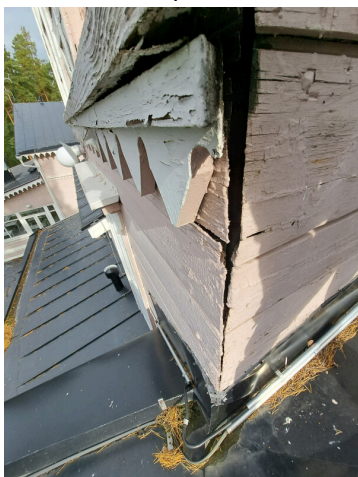
42. Tornin puuverhouksessa lahovaurioita
