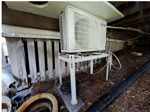
165. Ilmalämpöpumpun ulkoyksikköä terassin alla
