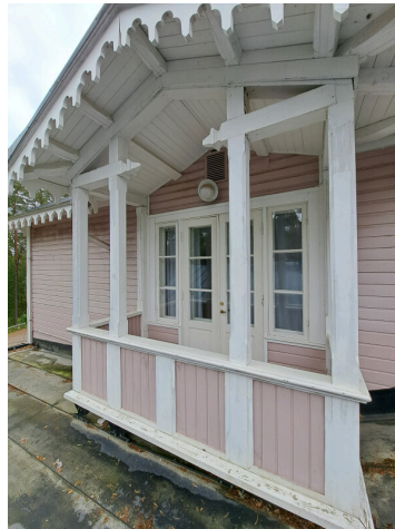
47. Parvekkeen kaiteen/rakenteen puuosissa maalipinnan hilseilee
