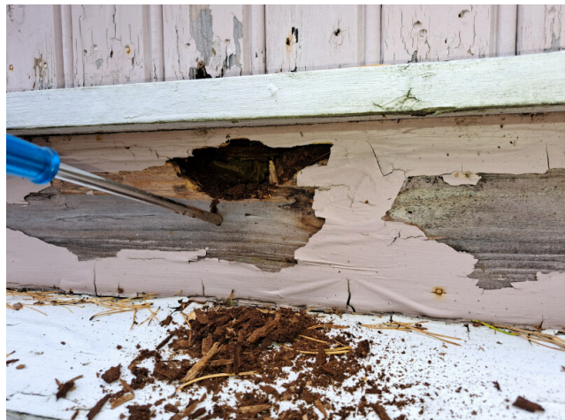
35. Lahovaurioita verannan kohdalla
