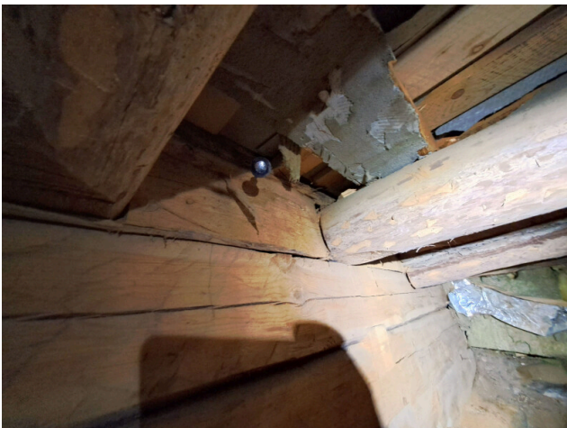
19. Lahovauriota ison ravintosalin väliseinän kohdalla
