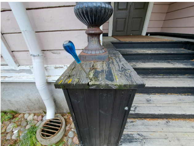
7. Hotellin takapihan sisäänkäynnin portaiden kaiderakennelmissa lahovaurioita
