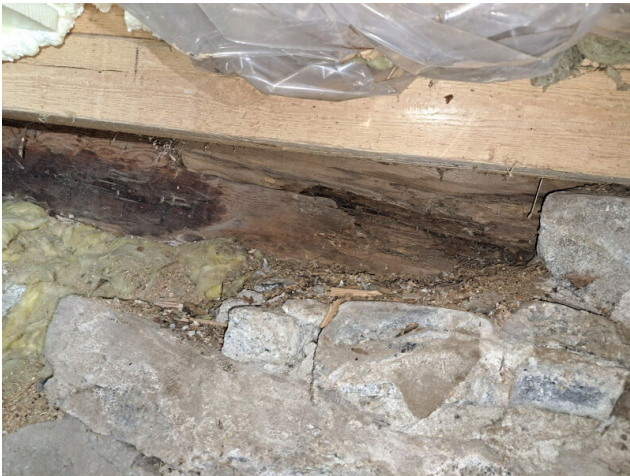
17. Verannan kohdalla on alapohjan hirsirakenteessa lahovauriota
