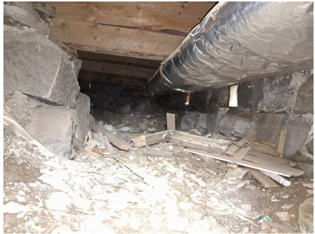
16. Ryömintätilassa runsaasti rakennusjätettä
