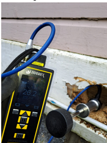
40. Ulkoseinän alimmassa hirressä koholla olevaa kosteupitoisuutta
