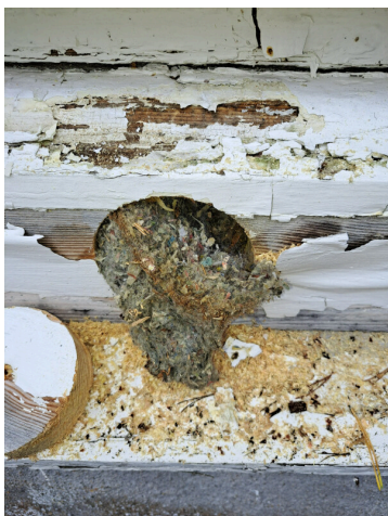
38. Ikkunan alla lämmöneristeet kastuneet seinärungossa
