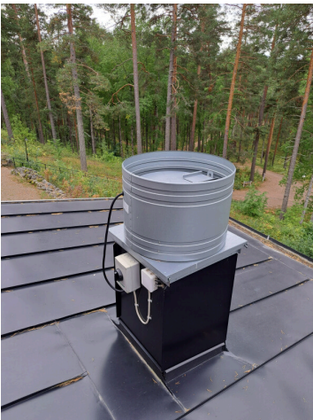
168. Poistoilmapuhallin ravintolan vesikatolla
