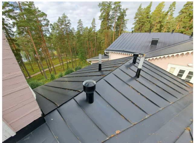
72. Yläpohjan tuuletusputkia vesikatolla
