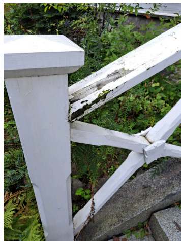
8. Kaiteiden puuosissa on lahovaurioita
