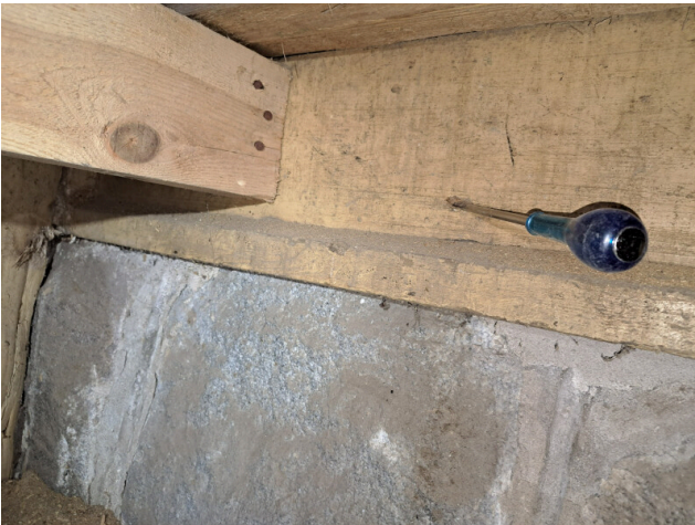
23. Lahovaurio rakennusosien liittymäkohdassa.
