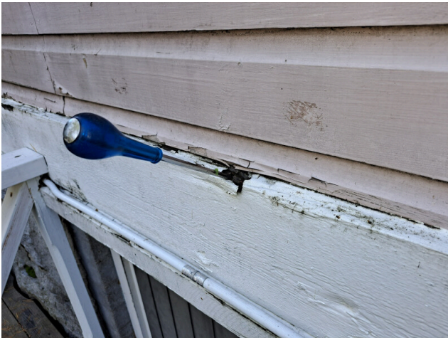
32. Lahovaurioita kellarin sisään tulon kohdalla
