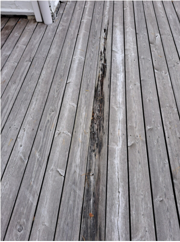
50. Terrassin alapohjan laudoituksessa lahovaurio
