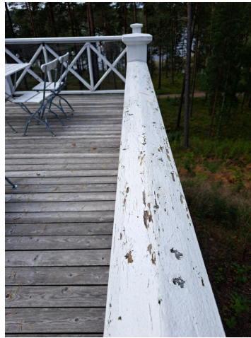
53. Terrassin kaiteiden maalipinnat hilseilee
