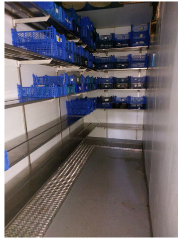
123. Kylmiön lattialla vettä, ei lattiakaivoa
