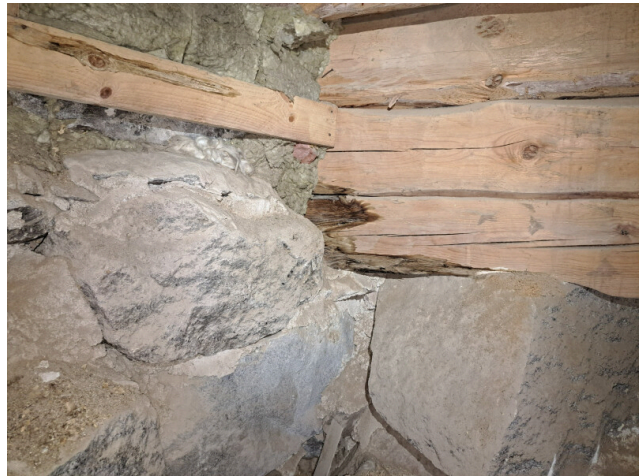
18. Vanha kosteusjälki arviolta ison ravintolasalin uunin kohdalla
