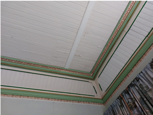
125. Ruokasalin katossa maalipinnan hilseilyä
