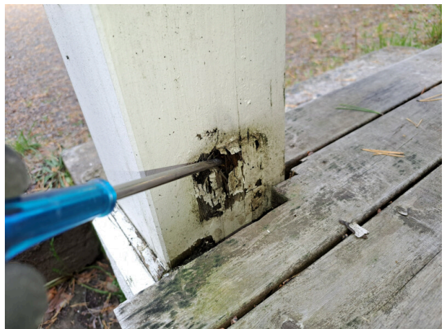
6. Keittiön portaiden kaiteiden alaosissa lahovaurioita
