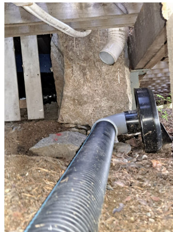
26. Terrassin alla rännikaivon asennus puutteellinen
