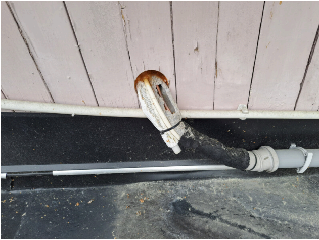
166. Ilmalämpöpumpun kylmäaineputkien eristykset puutteelliset
