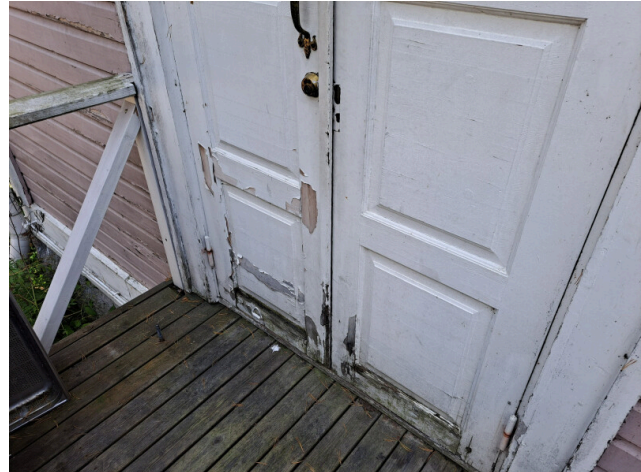
55. Keittiön päätyoven alaosissa vaurioita
