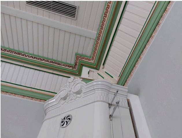
127. Ruokasalin katossa maalipinnan hilseilyä
