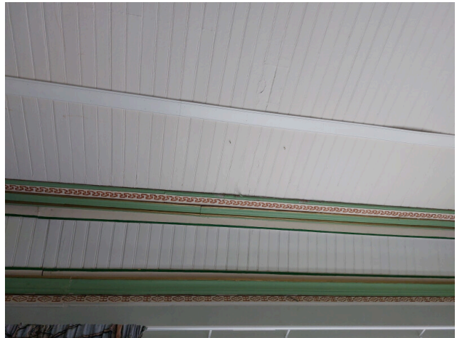
126. Ruokasalin katossa maalipinnan hilseilyä
