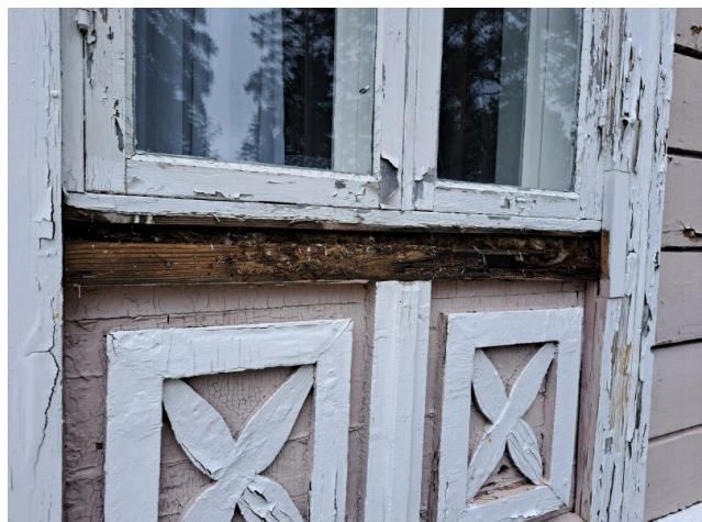
37. Ikkunan alapuolen rakenteissa lahovaurioita kosteusvaurioista johtuen
