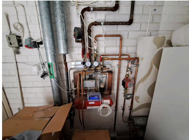
163. Kaukolämmösiirrin huolto- ja myymälärakennuksessa
