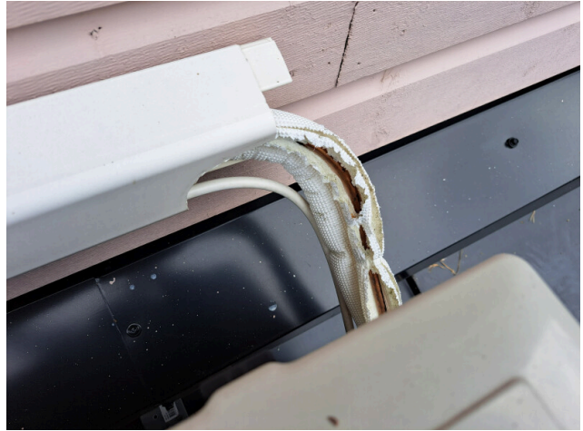
167. Ilmalämpöpumpun kylmäaineputkien eristykset puutteelliset
