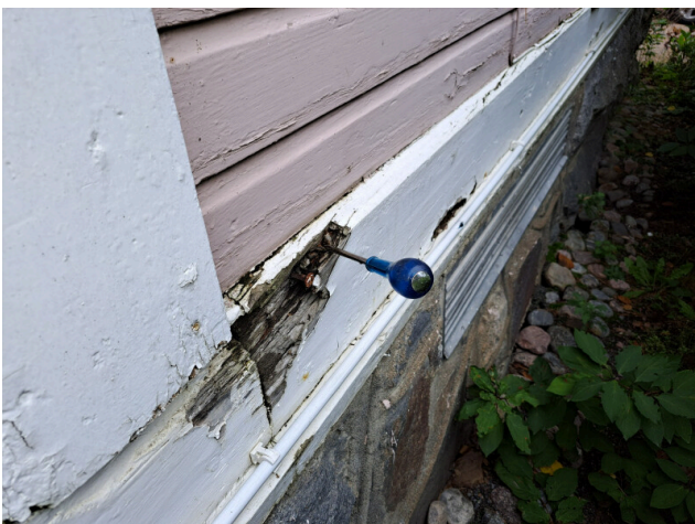
36. Lahovaurioita etupihan puolella alimmassa korsitelautoituksessa
