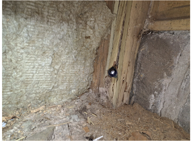
22. Lahovaurio rakennusosien liittymäkohdassa.
