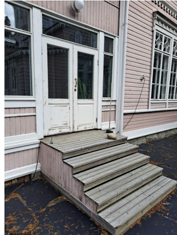
57. Terassin oven maalipinnat hilseilee
