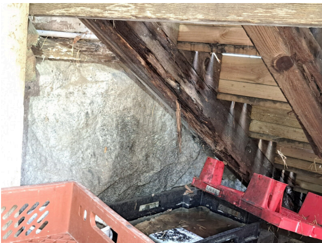
5. Keittiön portaiden kantavissa rakenteissa on lahovauriota
