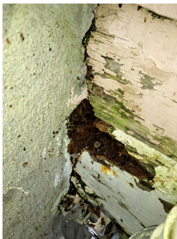
39. Ravintolan sisäänkäynnin vieressä alin osa puuverhouksesta ja osin alin hirsikerta lahonnut
