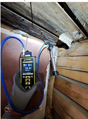
133. Varaston yläpohjan rakenteissa kosteuspitoisuus kohollaan merkittävästi
