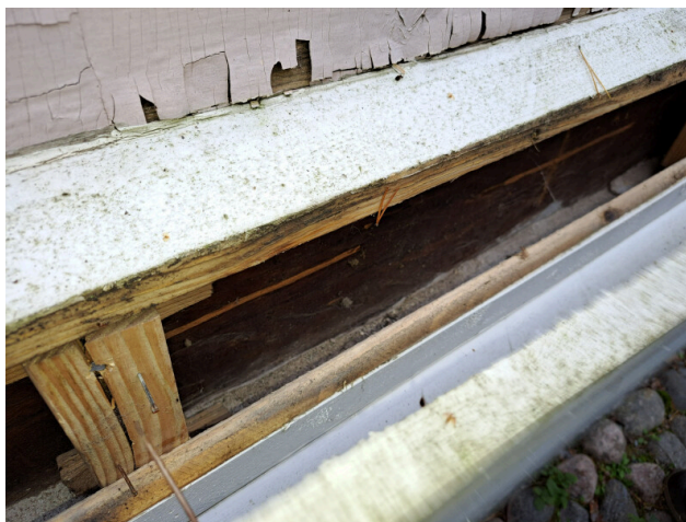
43. Etupihan puolella alaosan vaakalautoitusta on korvattu samannäköisellä kotelolaudoituksella ja koolauksella. Hirsikerta ehjää kyseisellä kohdalla.
