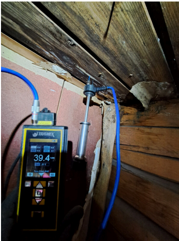
131. Varaston yläpohjan rakenteissa kosteuspitoisuus kohollaan merkittävästi
