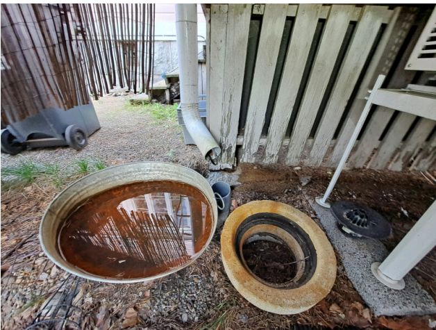
27. Keittiön takapihan puoleisella sivustalla sadevesien ohjaus puutteellinen
