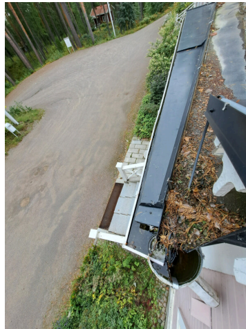
66. Sadevesikourut ja syöksytorvet tukossa neulasista yms. roskasta
