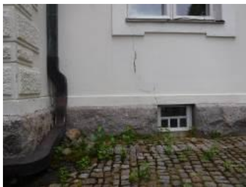
Kuva 18. Halkeama julkisivussa etupihan puoleisella terassilla.
