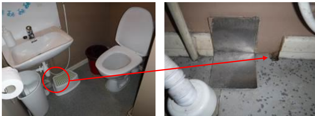
Kuva 65 ja 66. Ilmavuotokohta Vanamojen WC-tilan lattiarajassa
