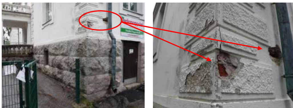
Kuva 10 ja 11. Rappaus on lohjennut ja halkeillut etupihan ulkonurkassa
