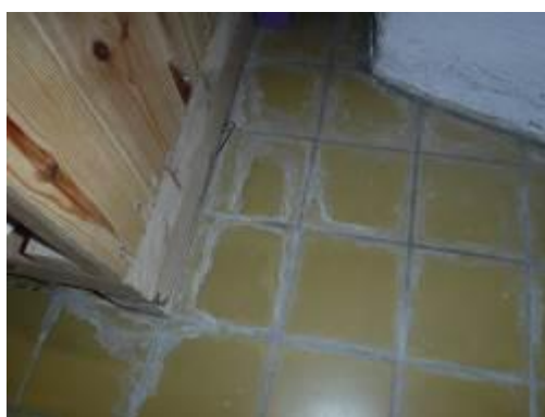
Kuva 55. Kosteusjälkiä lattiassa pilarin juuressa.
