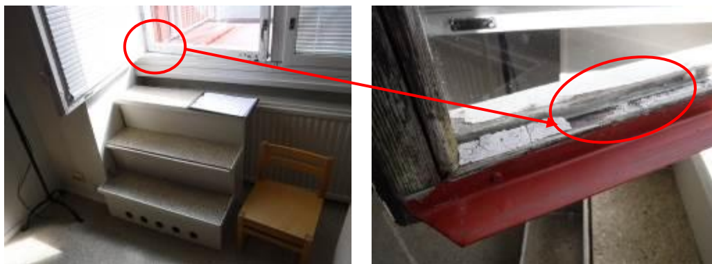
Kuvat 34 ja 35. Ikkunapoka on paikoitellen irronnut.
