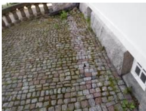
Kuva 45. Vesi on tulvinut yli sadevesirännistä.
