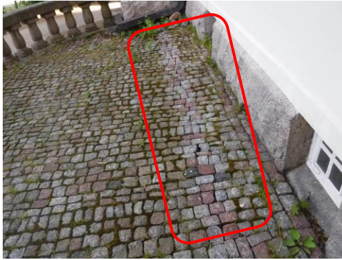
Kuva 5. Räystäältä tippuva vesi on puhdistanut terassilaatoitusta
