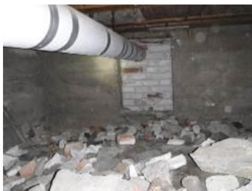
Kuva 8. Ryömintätilan pohjalla on kiveä, tiiltä ja betonijätettä.
