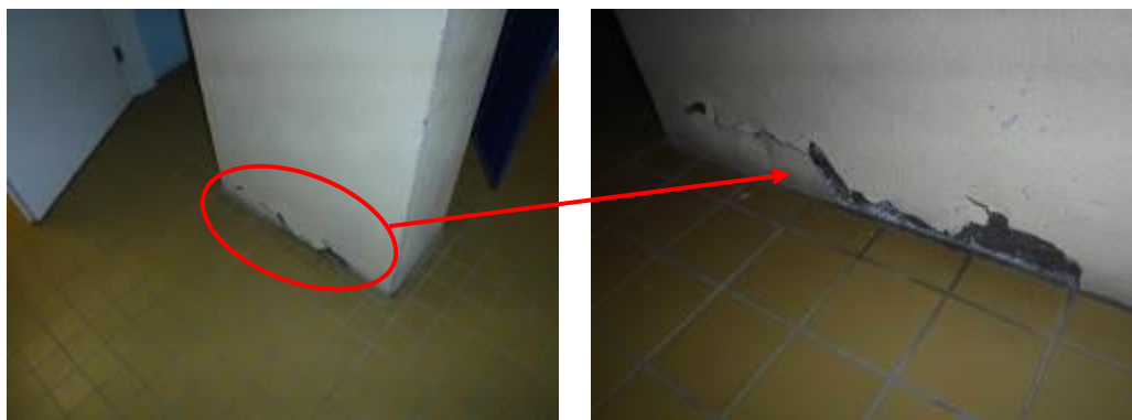
Kuvat 49 ja 50. Seinän alaosa kupruilee kosteuden vaikutuksesta käytävällä.
