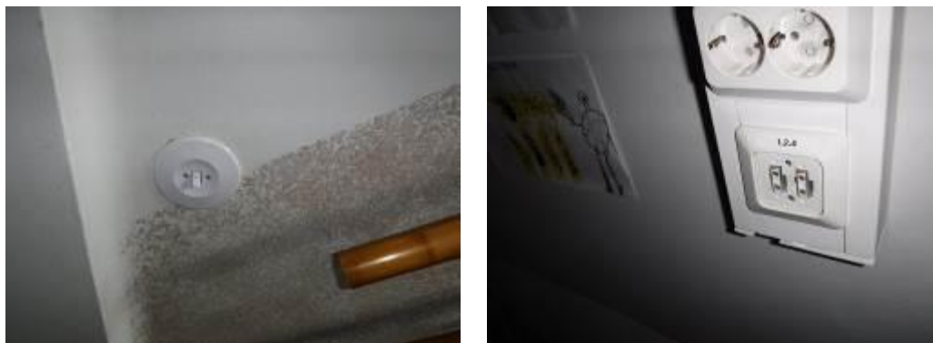
Kuvat 88 ja 89. Sähköjärjestelmä on osittain vanhaa ja osittain uutta.
