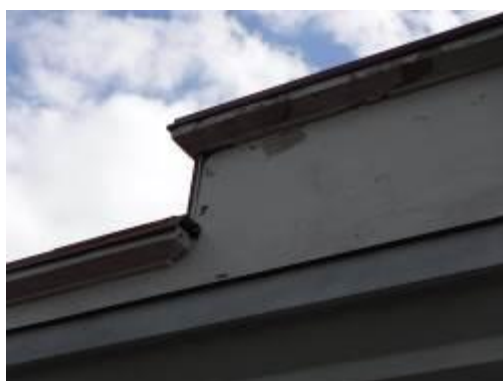
Kuva 22. Pinnoite kupruilee irti ulkoseinästä etupihan puolella vesikaton rajassa.
