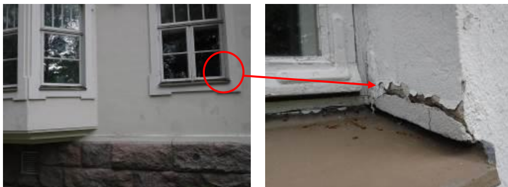
Kuva 21. Ikkunan smyygirappaus halkeilee etelänpuoleisessa päädyssä.
