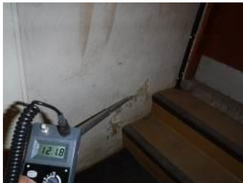
Kuva 52. Seinän alaosa kupruilee kosteuden vaikutuksesta porrasaukon alapäässä.
