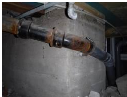
Kuva 87. Ryömintätilassa on sekä uutta muovista viemäriputkea että vanhaa valurautaputkea.
