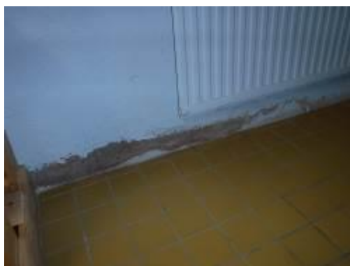
Kuva 51. Seinän alaosa kupruilee kosteuden vaikutuksesta pyykkituvassa.
