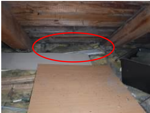
Kuva 48. Yläpohjan lämmöneriste on kiinni vesikatteessa.
