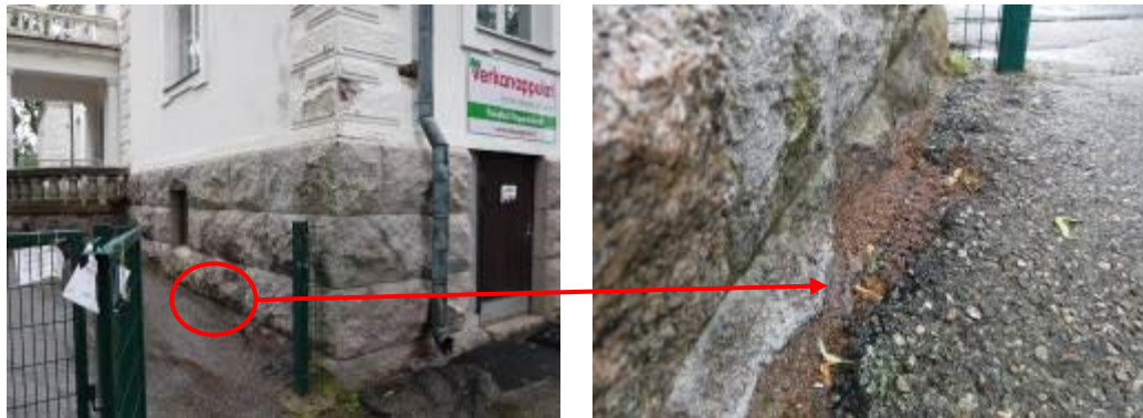
Kuvat 3 ja 4. Kohta, josta vettä saattaa päästä rakennuksen alle.
