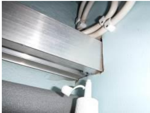
Kuva 62. ilmavuotokohta seinän läpivientikohdassa
