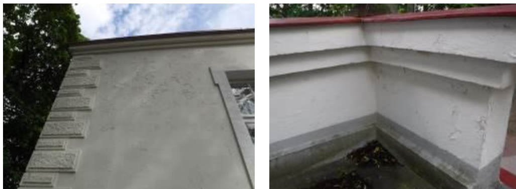
Kuva 12 ja 13. Rappauksen maalipinta hilseilee.
