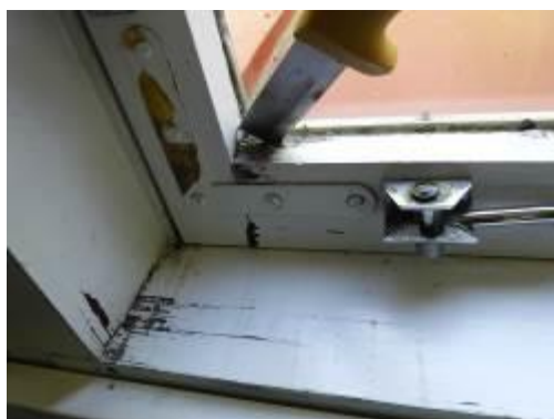
Kuva 33. Yläkerran ikkunan poka on pehmennyt kosteuden vaikutuksesta.
