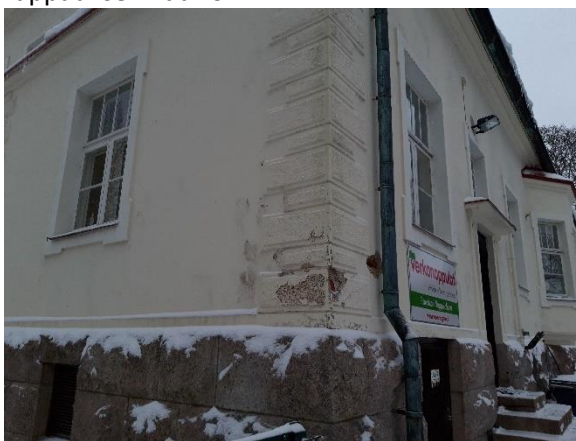
Kuva 17. Etelän- ja idänpuoleisen seinän nurkassa useita vaurioita rappauksessa ja maalipinnassa
