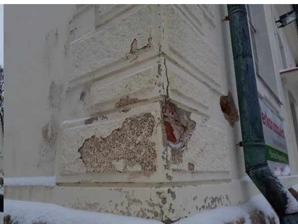
Kuva 18. Lähikuva nurkan vaurioista
