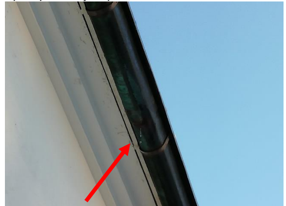
Kuva 34. Räystäissä havaittiin vuotoa ja pisarat valuivat lävitse
