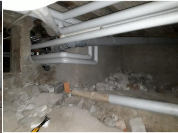
Kuva 2. Ryömintätilassa havaittiin runsaasti kiviperäistä rakennusjätettä.
