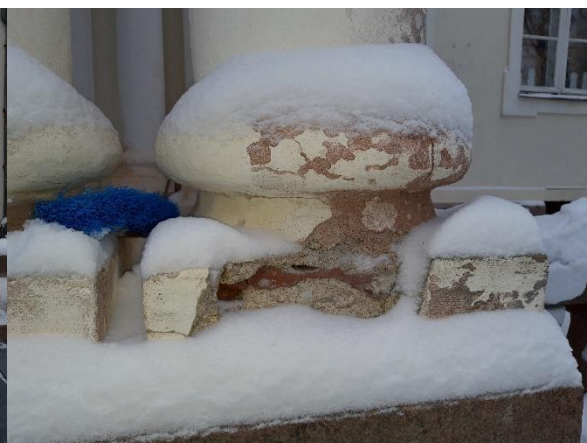
Kuva 16. Lähikuva pilarin alaosan vauriosta
