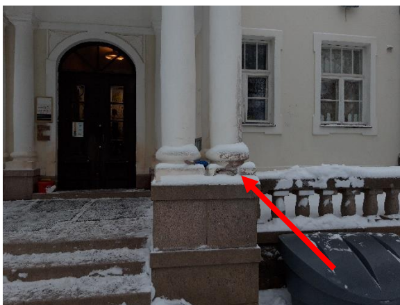
Kuva 15. Sisäänkäynnin katoksen pilarin alaosan rappauksen vaurio
