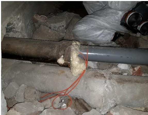
Kuva 3. Käytöstä poistettua viemärointiä sekä virheellinen viemäroinnin liitos.
