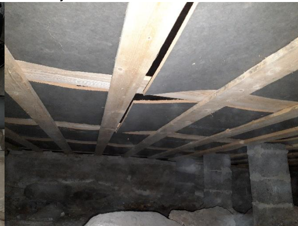
Kuva 4. Repsottavia tuulensuojalevyjä uusitus alapohjarakenteessa.
