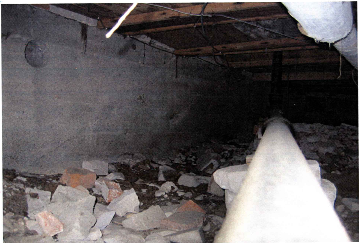
Kuva 19 Alapohjatila 5. Sokkelirakenteessa näkyy tuuletusventtiilin reikä. Venttiilin toiminta tulee tarkistaa.
