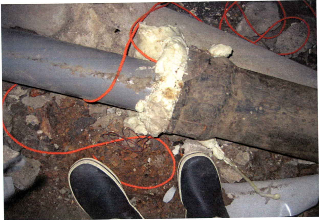
Kuva 14 Alapohjatila 3. Viemäreiden liitos tulee tutkia ja tarvittaessa korjata.
