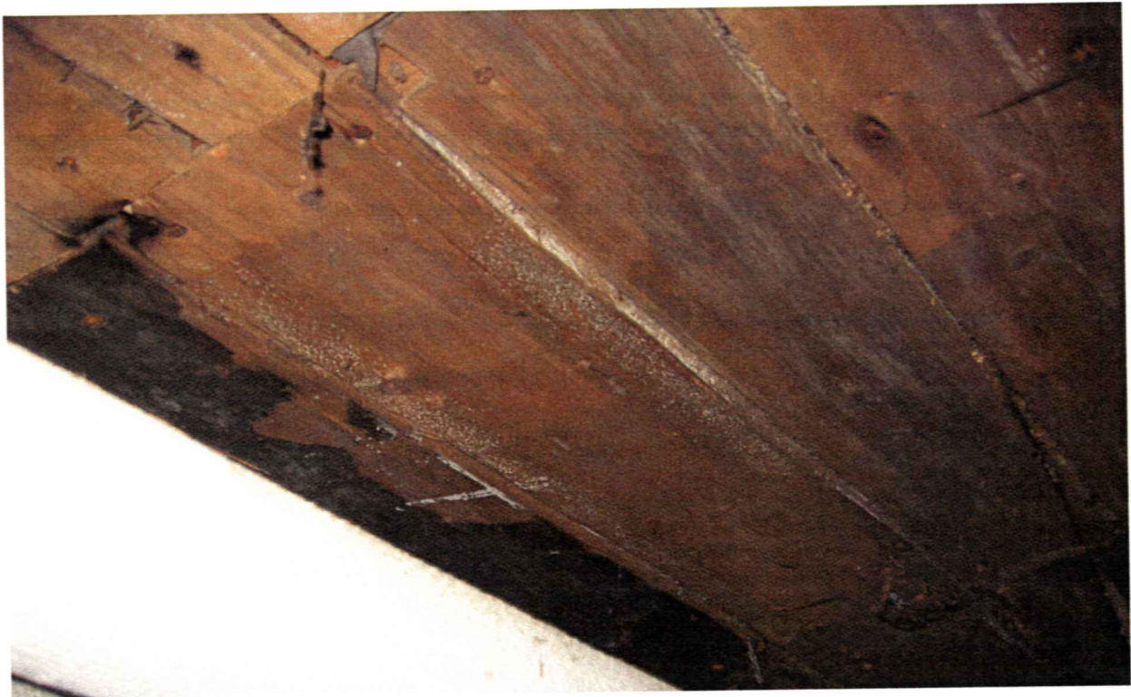
Kuva 23 Alapohjatila 6. Laudoituksessa mahdollisesti jälkiä aiemmasta kosteuden esiintymisestä rakenteessa. Tummuneella osalla laudoitusta on laudan pinta todennäköisesti palanut aiemmin pinnasta.
