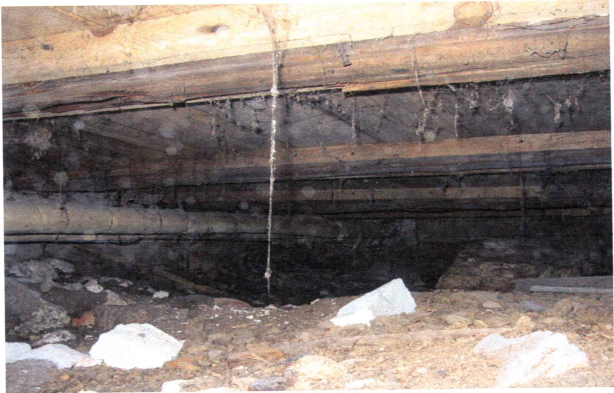
Kuva 7 Alapohjatila 1. Tilaa yläosaan päin kuvattuna, tuuletetun tilan korkeus mataloituu ylöspäin mentäessä. Todennäköisesti myös yläosassa olevat palkit vaurioituneet.
