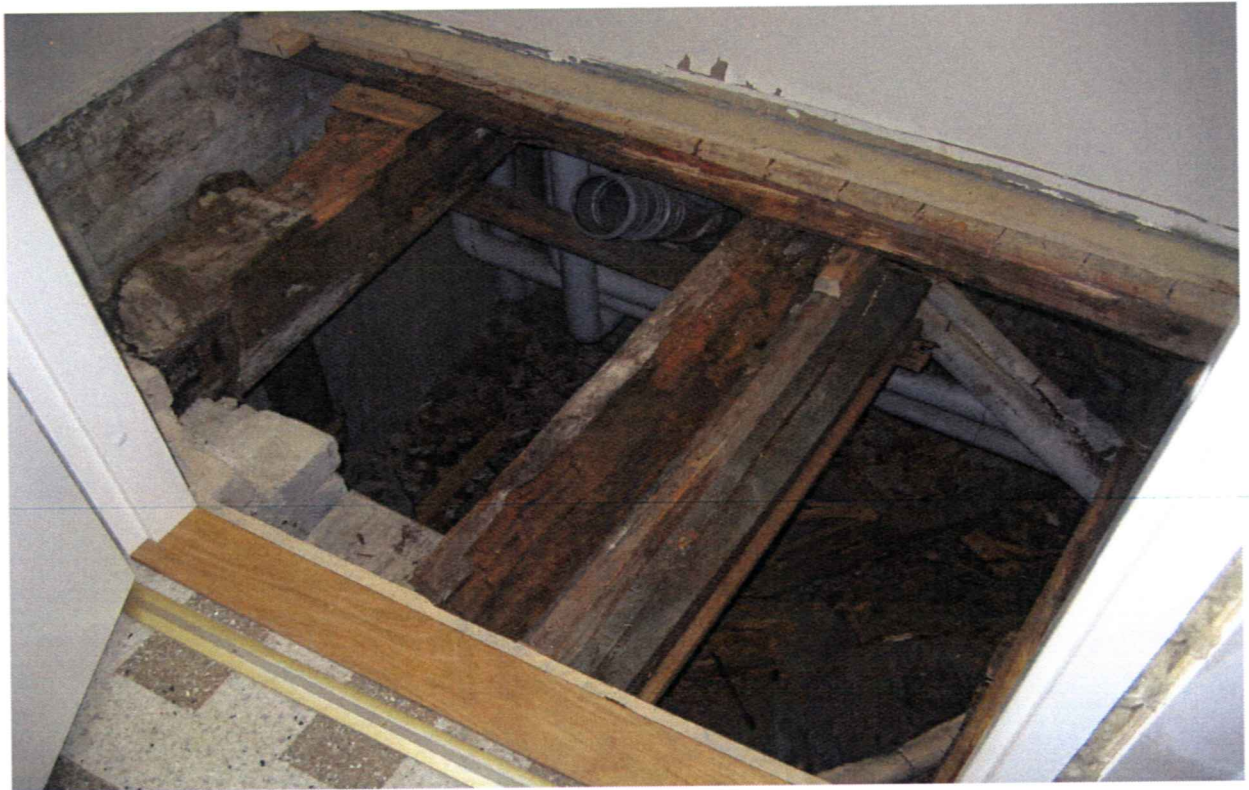
Kuva 1 Alapohjatila 1. Aiemmin avattu lattiarakenne WC:n kohdalla. Kantavat palkit vaurioituneet.
