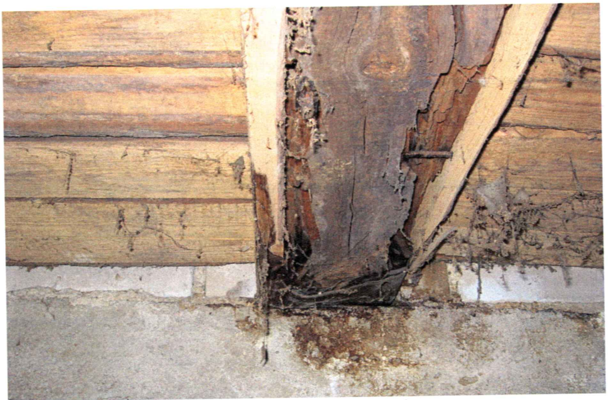
Kuva 4 Alapohjatila 1. Vaurioitunut kantava palkki lähellä ulkoseinälinjaa tuuletetusta tilasta kuvattuna.
