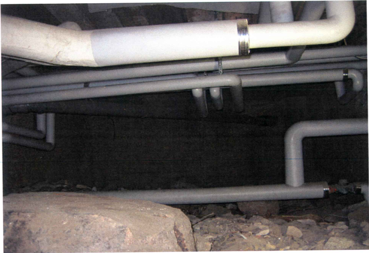
Kuva 15 Alapohjatila 3. Tilassa runsaasti putkivetoja.
