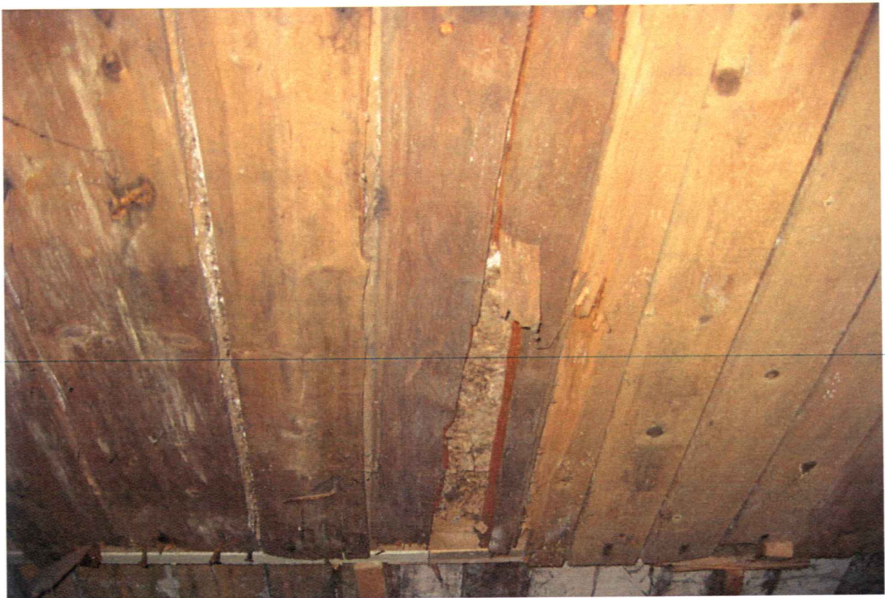
Kuva 24 Alapohjatila 6. Aluslaudoitus on rikkoutunut. Kuvan vasemmassa reunassa on mahdollisesti jälkiä aiemmasta kosteuden esiintymisestä rakenteessa.
