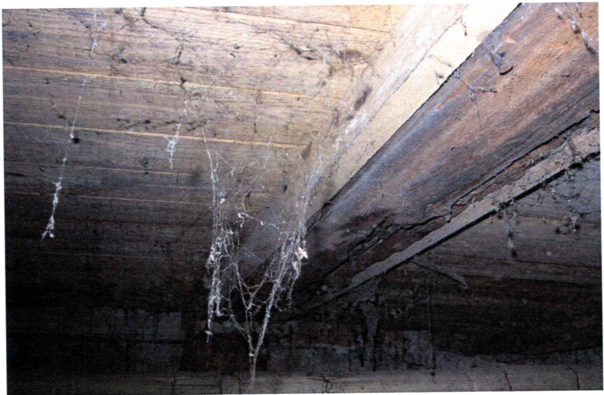
Kuva 6 Alapohjatila 1. Vaurioitunut kantava palkki lähellä ulkoseinälinjaa tuuletetusta tilasta kuvattuna.
