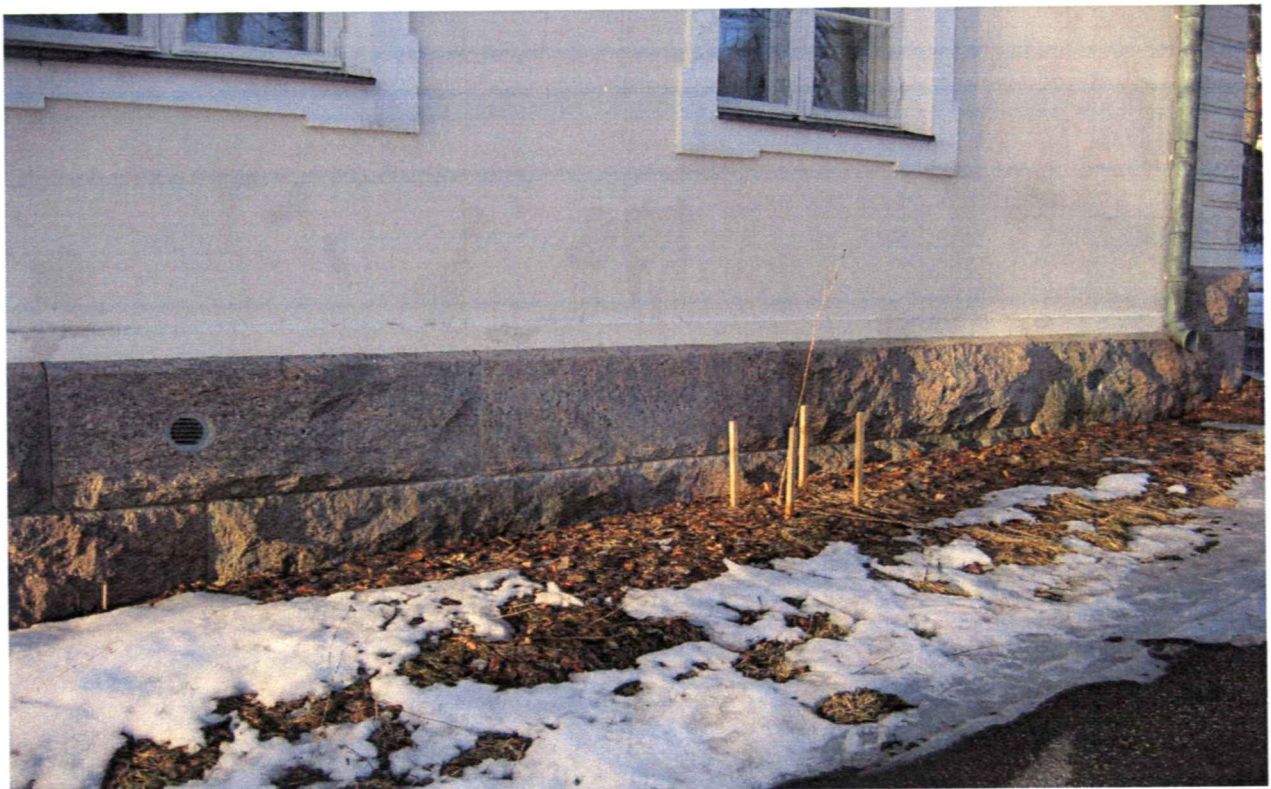
Kuva 25 Kuvassa alapohjatilan 2 korvausilmaventtileitä sokkelirakenteessa.
