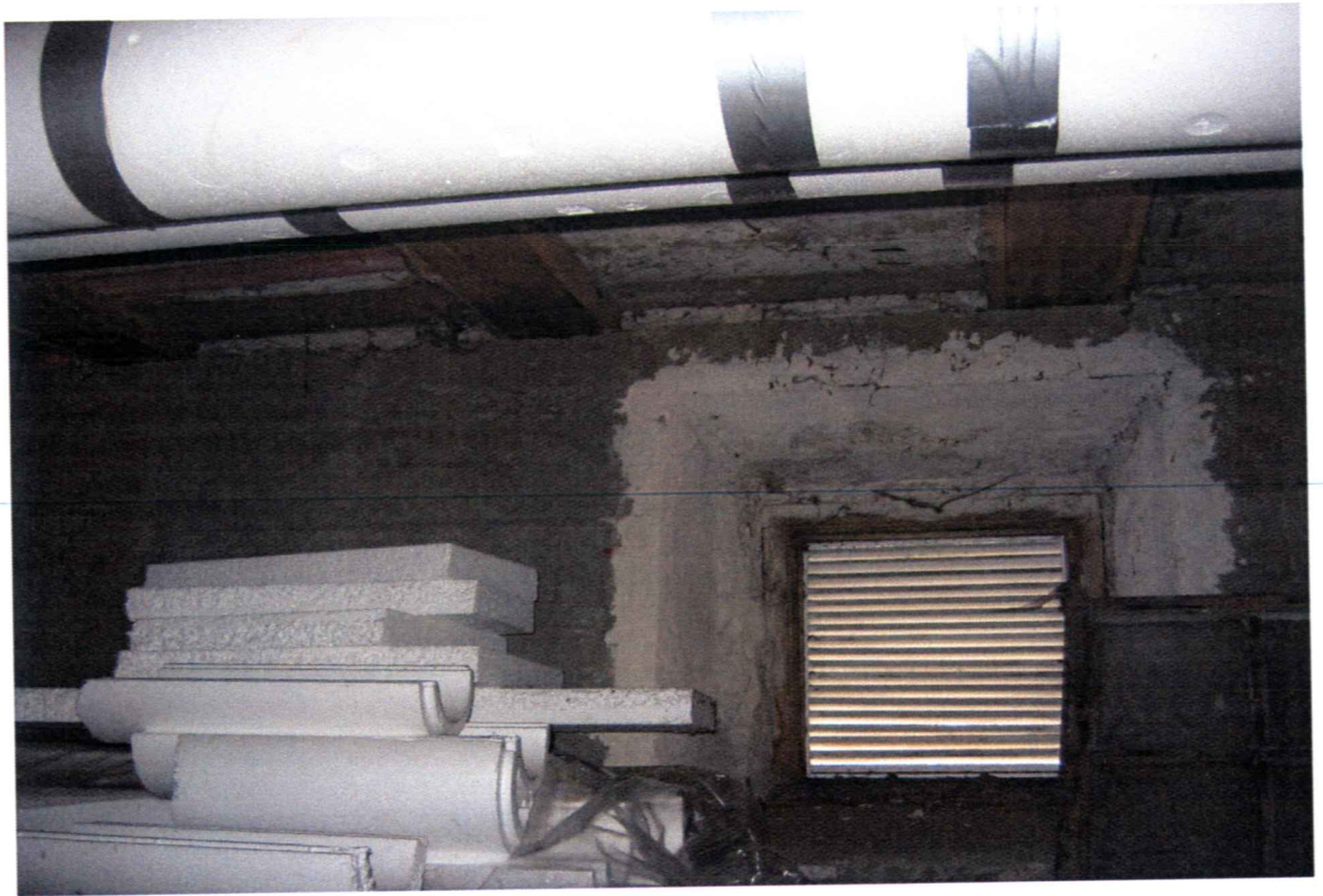
Kuva 11 Alapohjatila 2. Kuva kohti käyntiluukkua. Tilassa ylimääräisiä rakennustarvikkeita jotka tulee poistaa.
