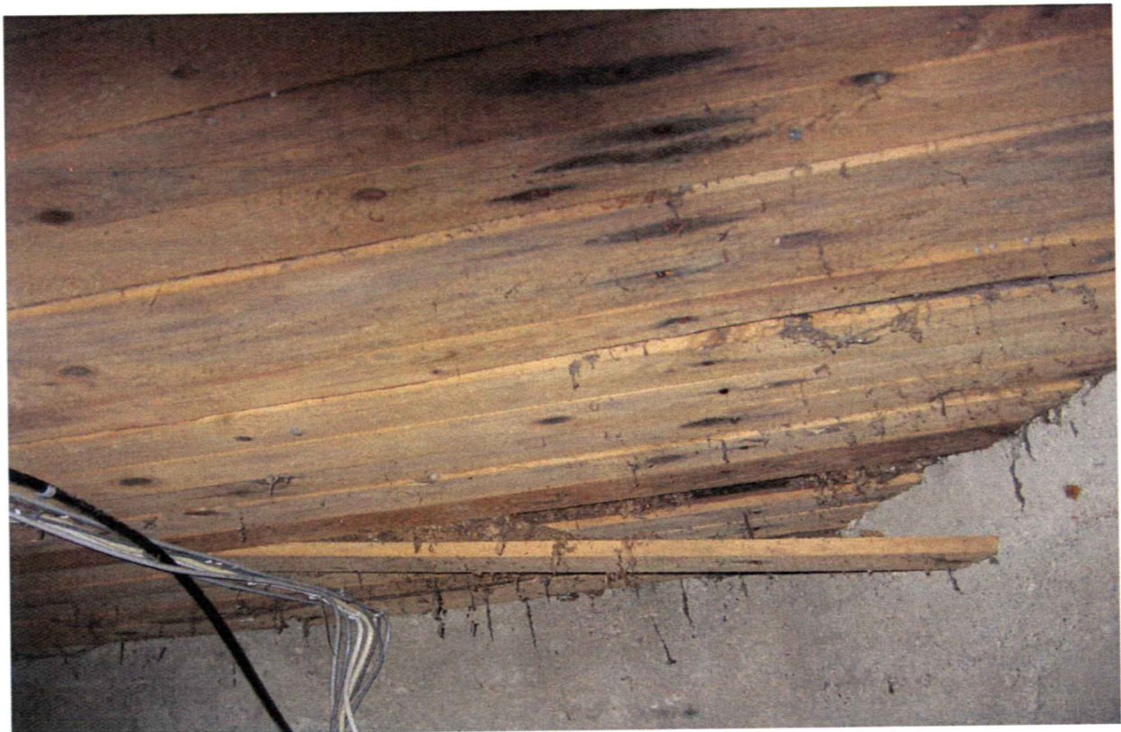
Kuva 21 Alapohjatila 6. Aluslaudoituksen kiinnitys tulee korjata.
