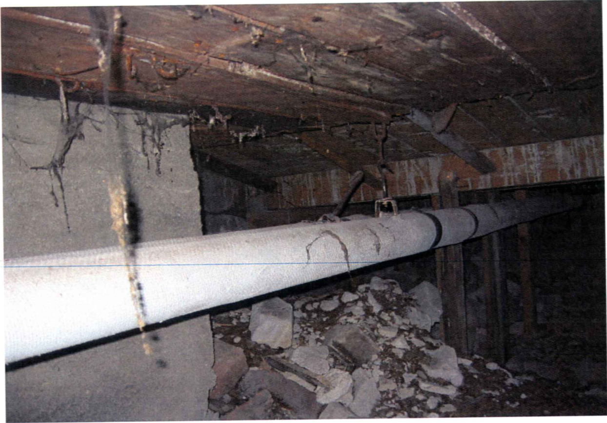
Kuva 22 Alapohjatila 6. Laudoituksessa mahdollisesti jälkiä aiemmasta kosteuden esiintymisestä rakenteessa.
