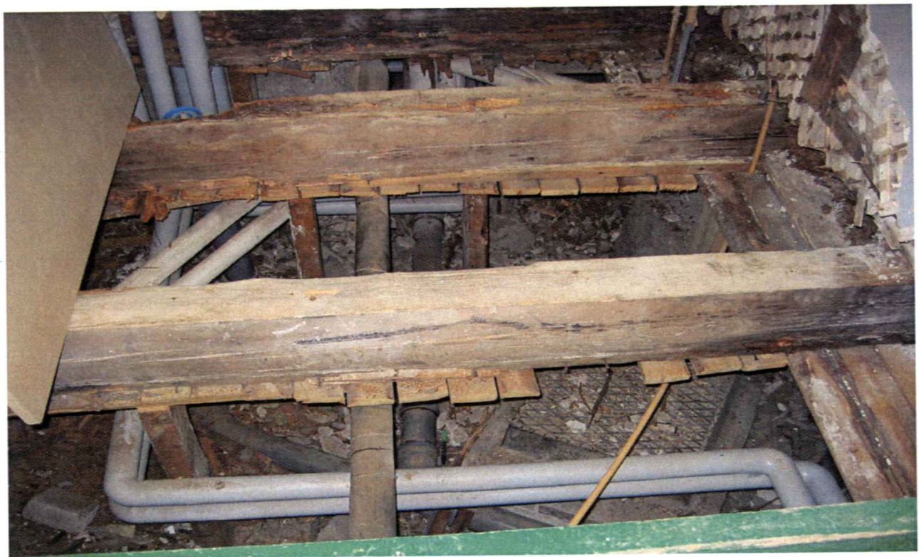
Kuva 2 Alapohjatila 1. Aiemmin avattu lattiarakenne pesuhuoneen kohdalla. Osa kantavista palkeista vaurioitunut.
