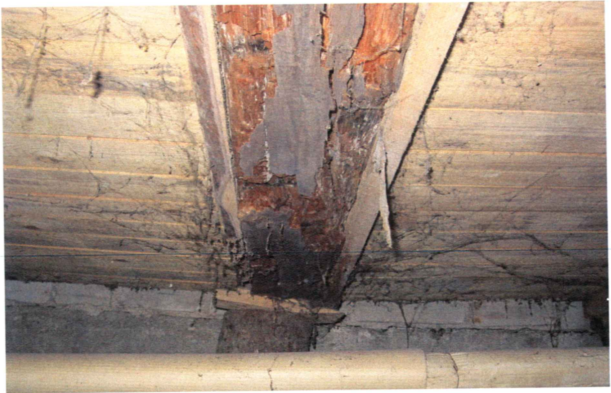
Kuva 5 Alapohjatila 1. Vaurioitunut kantava palkki lähellä ulkoseinälinjaa tuuletetusta tilasta kuvattuna.
