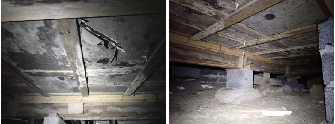
Kuvat 18 ja 19. Alapohjarakenteen alapinnassa on laajalti pitkälle edenneitä kosteus- ja mikrobivaurioita. Alapohjan alapinnassa on todettavissa viitteitä mikrobivaurioista lähes koko alapohjan alalla.
