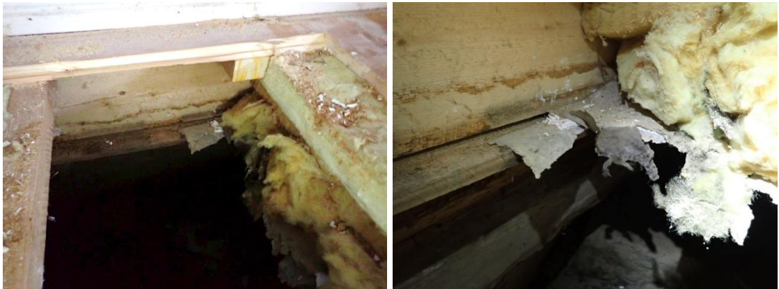
Kuvat 10 ja 11. Alapohjarakenne on pahoin kosteus- ja mikrobivaurioitunut aistinvaraisesti tarkasteltuna rakenneavauksen 6 kohdalla. Alapohjarakenteen puupalkeissa on kosteusjälkiä ja mineraalivillassa on tummentumaa. Tuulensuojalevynä olevan kipsikartonkilevyn ala- ja yläpinnassa on mikrobikasvustoa.
