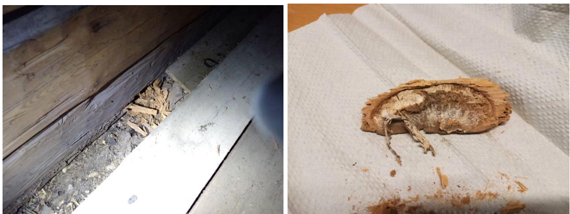
Kuvat 57 ja 58. Ullakkokerroksen lankkulattiaan tehtiin rakenneavaus 19 pääsisäänkäynnin puoleiselle sivustalle kuistin läheisyyteen. Kyseisellä kohdalla puulastueriste on tummunut ja ulkoseinähirressä on syväälle edennyt lahovaurio.
