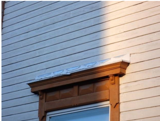
Kuva 40. Ikkunoiden koristelaudoitusten päällä olevien vesipeltien maalipinnat hilseilevät.
