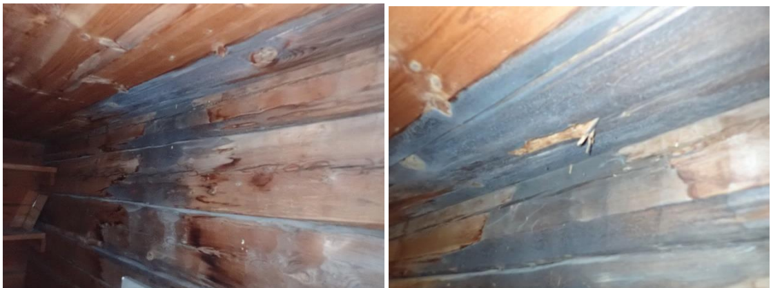
Kuvat 51 ja 52. Ullakkokerroksessa etelän ja lännen puoleisessa nurkkauksessa sijaitsevan huoneen ikkunan yläpuolella on mikrobivaurioitunut alue.
