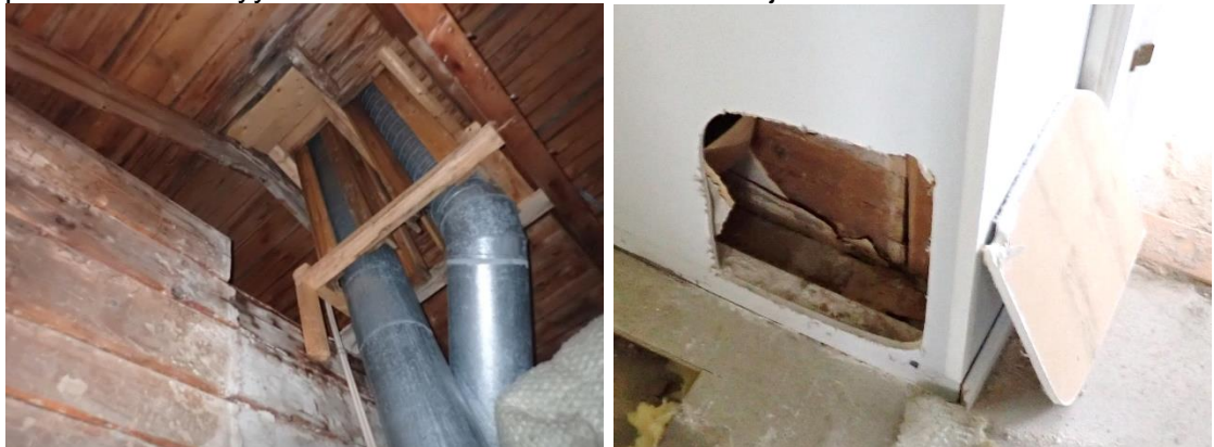
Kuvat 45 ja 46. Ilmanvaihtokanavia ei ole eristetty kylmässä ullakkotilassa. Käytävätilan 2 väliseinään tehdyn rakenneavauksen 15 kohdalla oli havaittavissa tummentumaa kipsikartonkilevyn taustapinnalla.
