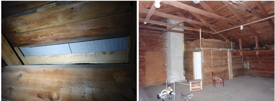
Kuvat 53 ja 54. Vesikatteen alla on vanha umpilautoitus, joka toimii kondenssikosteuden ta- saajana.
