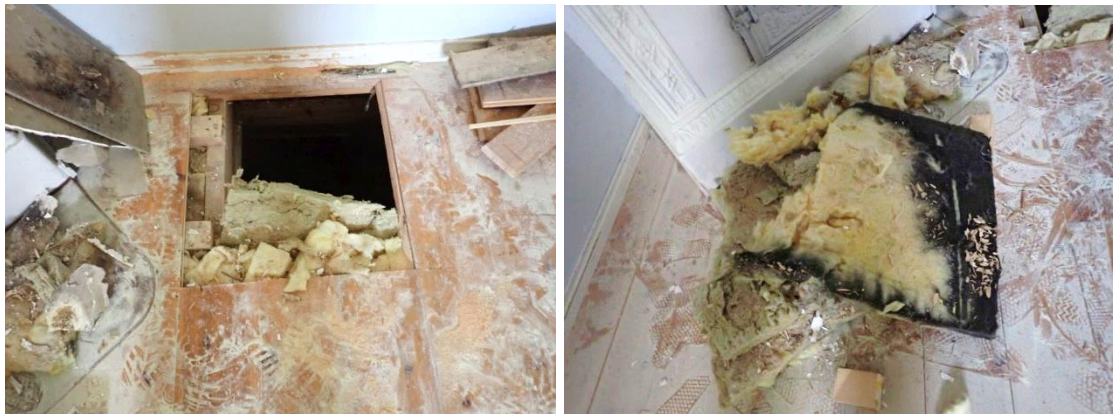
Kuvat 6 ja 7. Alapohjarakenne on pahoin kosteus- ja mikrobivaurioitunut aistinvaraisesti tarkasteltuna rakenneavauksen 5 kohdalla.
