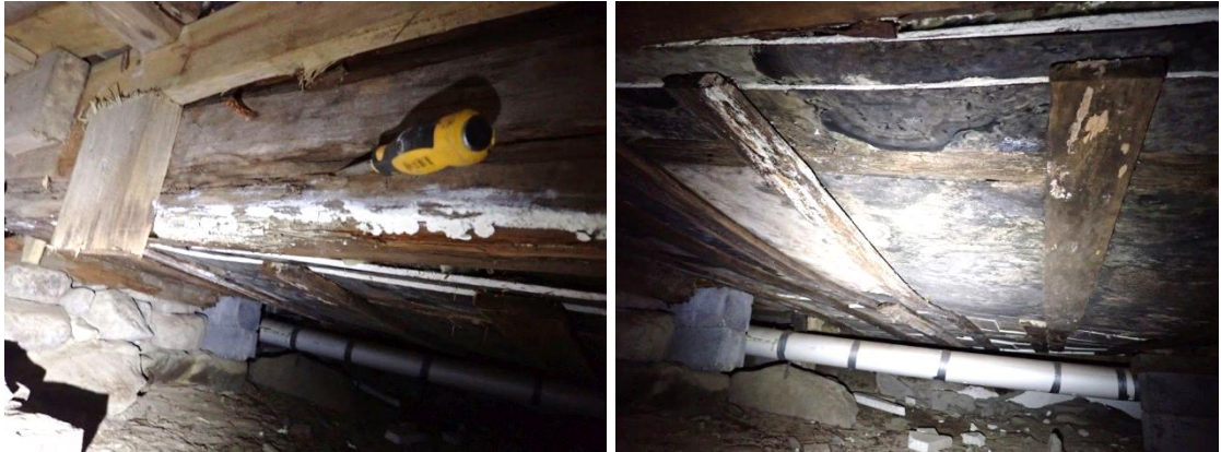
Kuvat 8 ja 9. Alapohja on pahoin kosteus- ja mikrobivaurioitunut ryömintätilasta tarkasteltuna.
