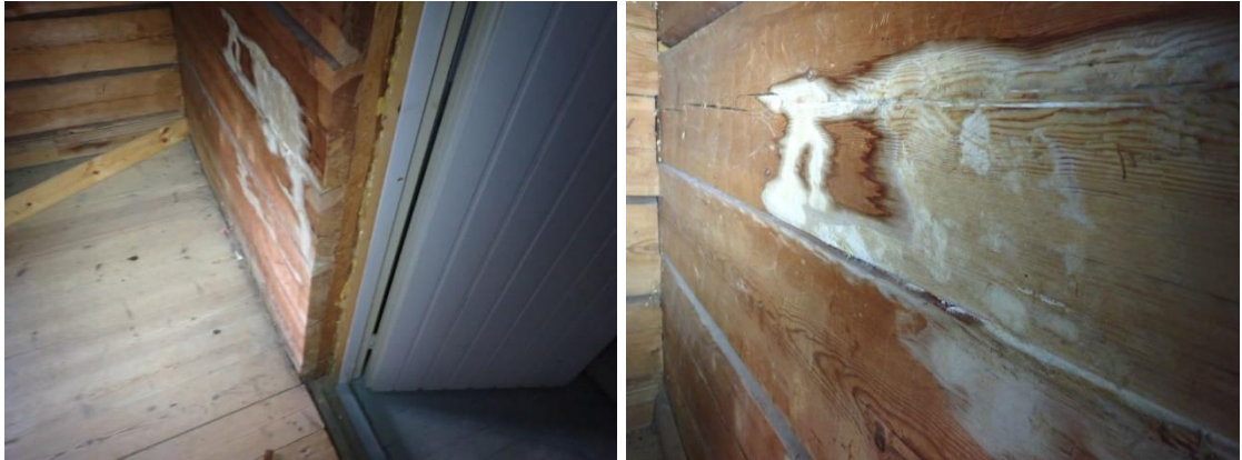
Kuvat 47 ja 48. Ullakkokerroksessa etelän ja lännen puoleisessa nurkkauksessa sijaitsevan huoneen hirsirakenteisen väliseinän pinnalla on valkoista mikrobikasvustoa.
