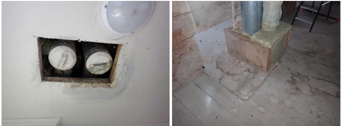
Kuvat 43 ja 44. Käytävätilan 1 katossa olevan ilmanvaihtokanavien tarkastusluukun kohdalla on kosteusjälkiä alakattolevytyksessä ja puukoolauksissa. Ilmanvaihtokanavat nousevat kyseiseltä kohdalta ylös kylmään ullakkotilaan ja edelleen vesikaton yläpuolelle.
