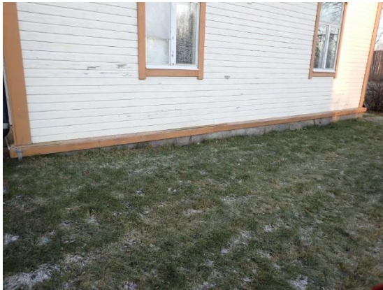
Kuvat 20 ja 21. Rakennuksen ryömintätila ei pääse tuulettumaan, mikä on olennaisin syy alapohjarakenteen laajoille ja pitkälle edenneille kosteus- ja mikrobivaurioille.
